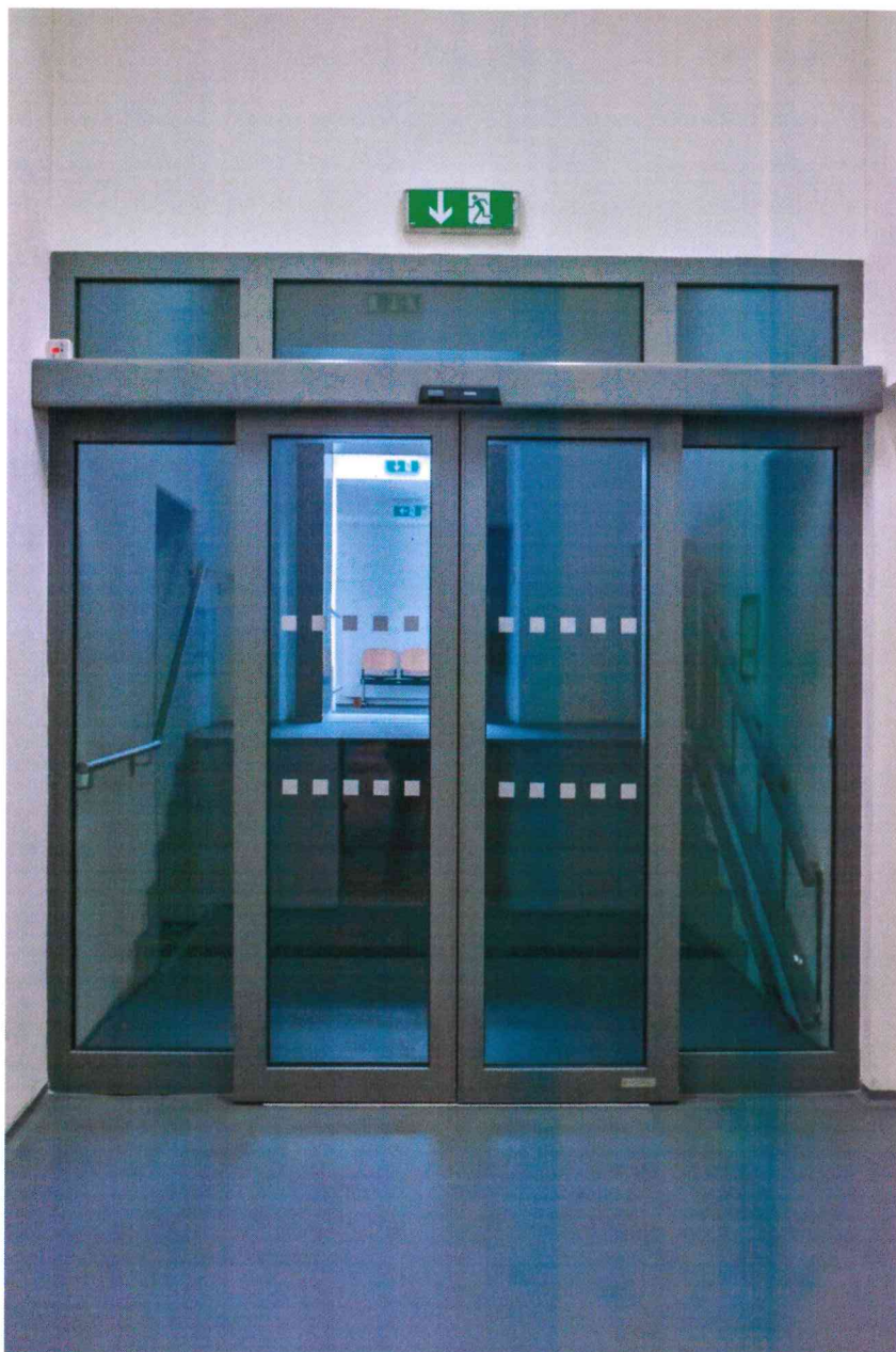
Obrázek 4 - Požární dveře EW 30 DP1- C ( posuvné ) na únikové cestě, tlačítko v horní části dveří umožní otevření požárních dveří v případě nutnosti úniku – ukázka provedení průhledných dveří – transparentní plocha je dodržena
