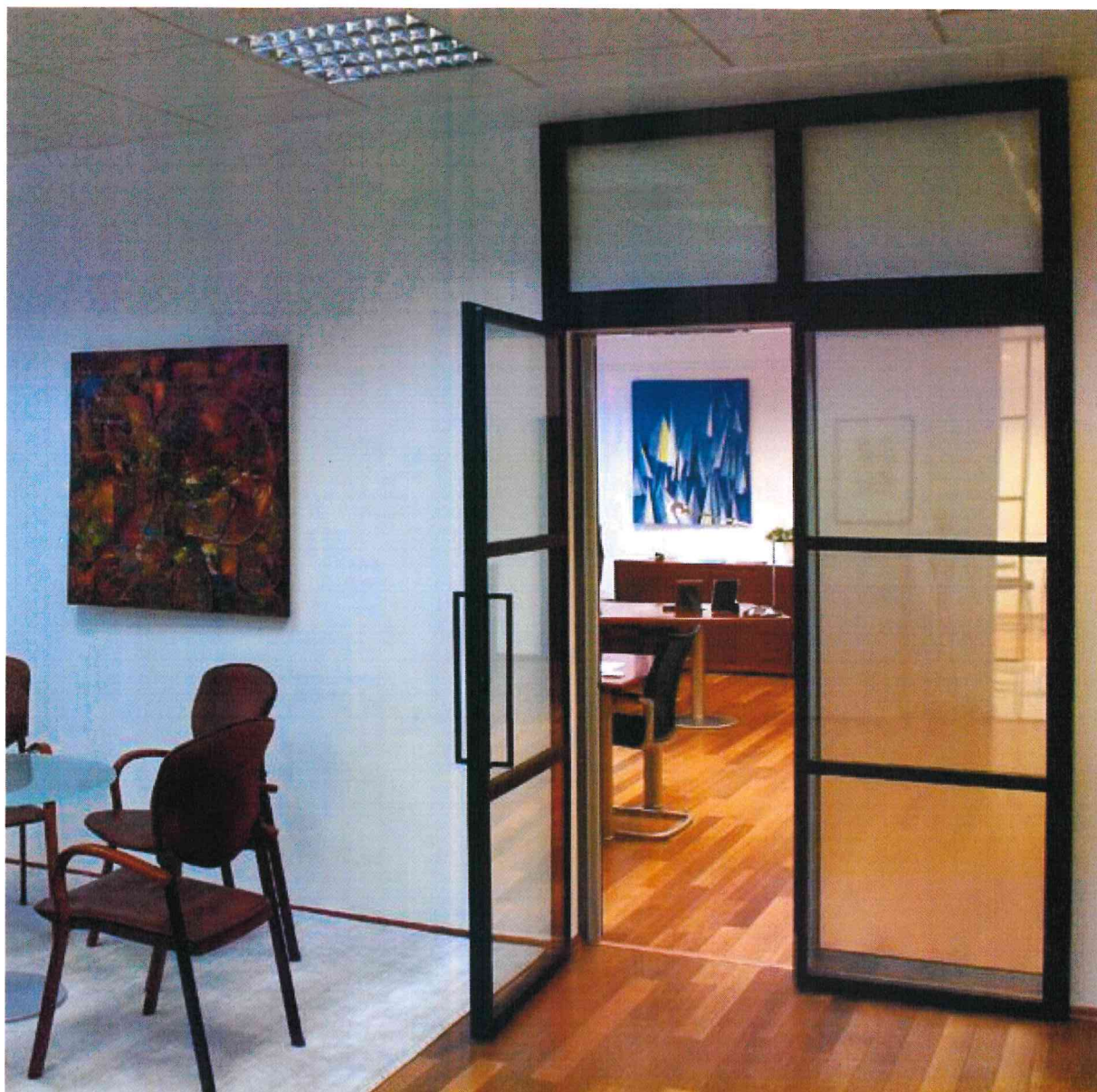
Obrázek 7 – Ukázka požárních dveří EW 30 DP1- C – mezi jednotlivými požárními úseky
