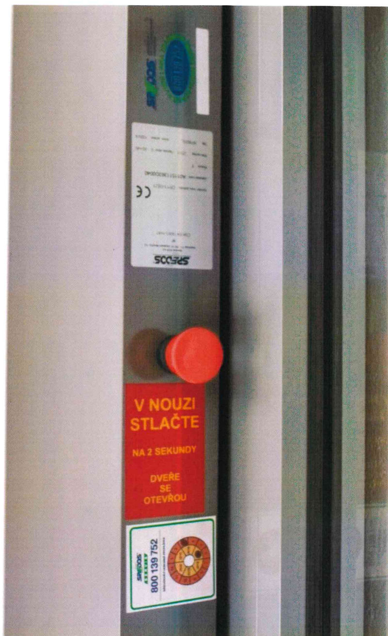
Obrázek 5 - Požární dveře EW 30 DP1- C na únikové cestě, tlačítko v horní části dveří umožní otevření požárních dveří v případě nutnosti úniku – ukázka umístění tlačítka a popisného štítku na dveřích
