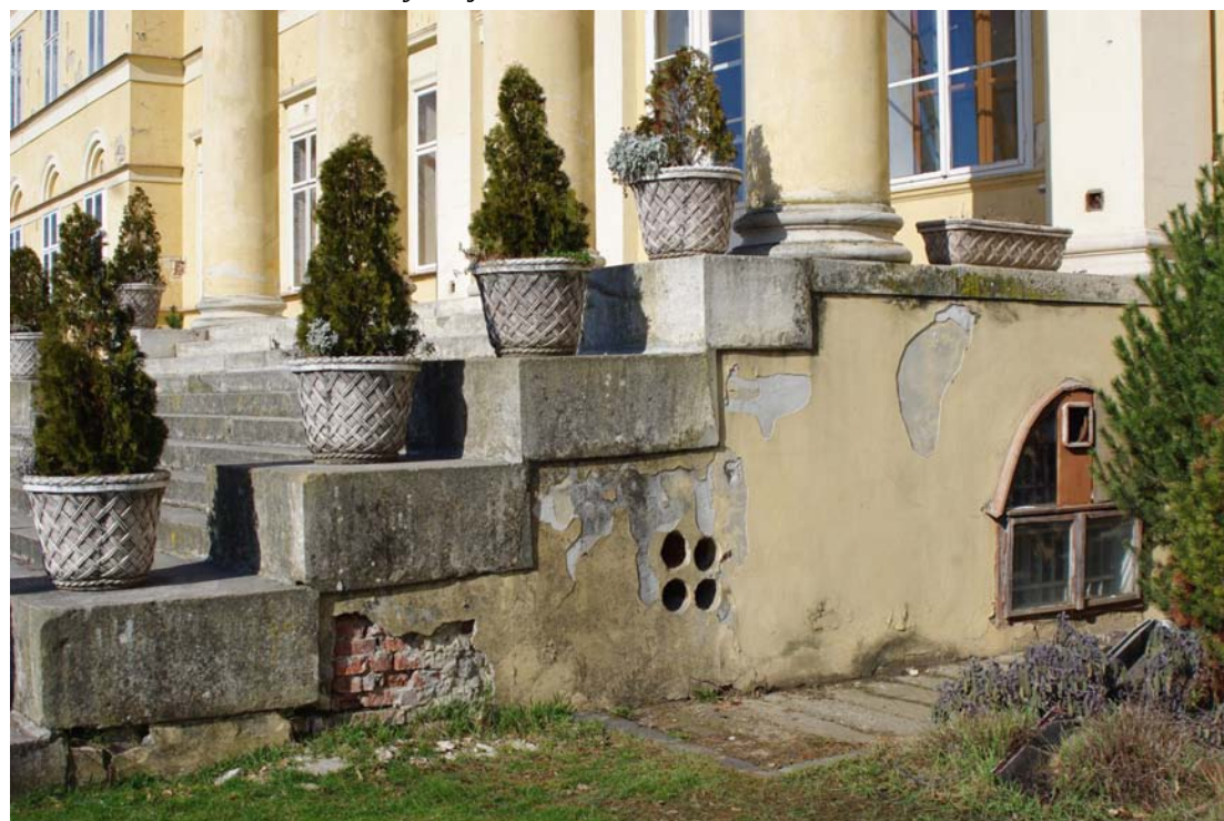
Schody na južnú terasu. Deštrukcie omietok.
