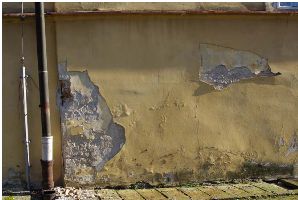
Poškodenia vrstiev na západnej fasáde kaštiľa.
