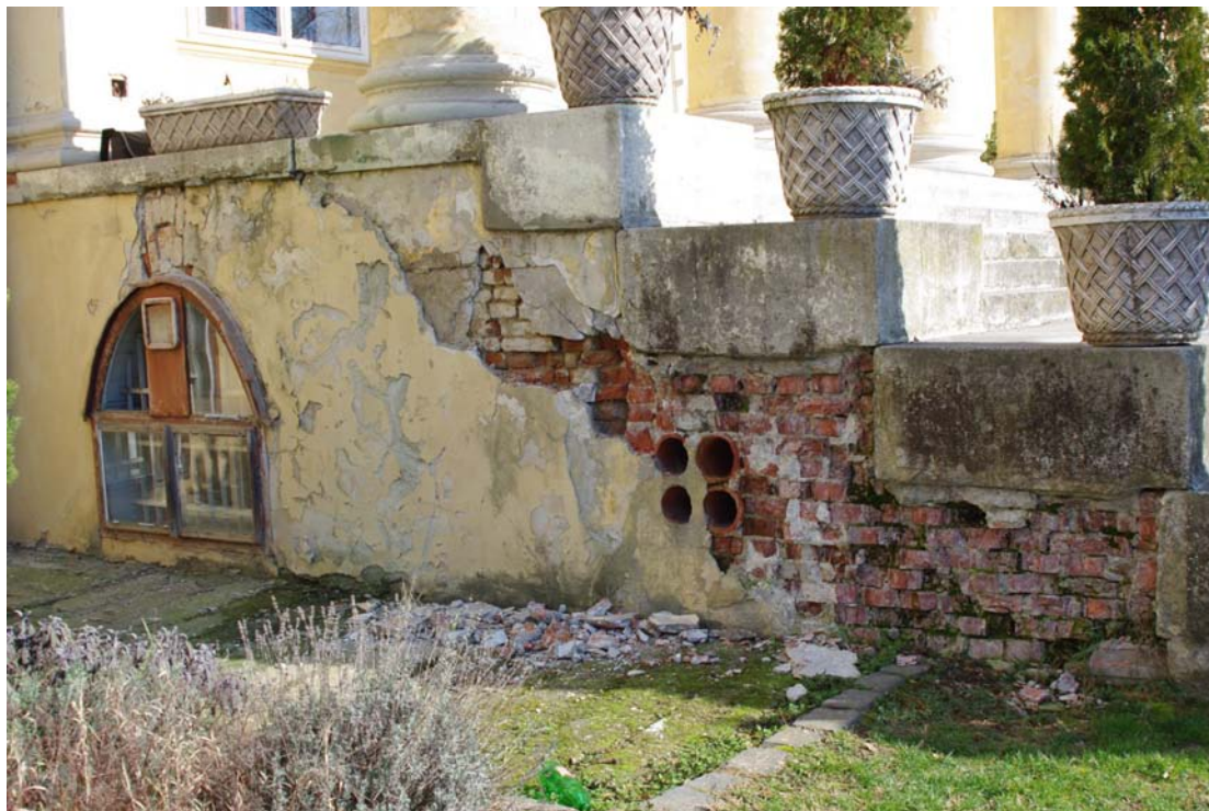
Schody na južnú terasu. Deštrukcie omietok.
