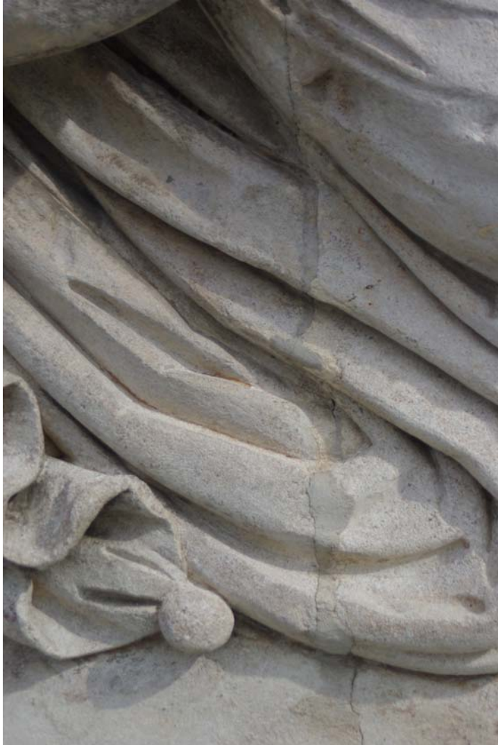
Cementové tmely na defektoch kamenného reliéfu v tympanóne.
