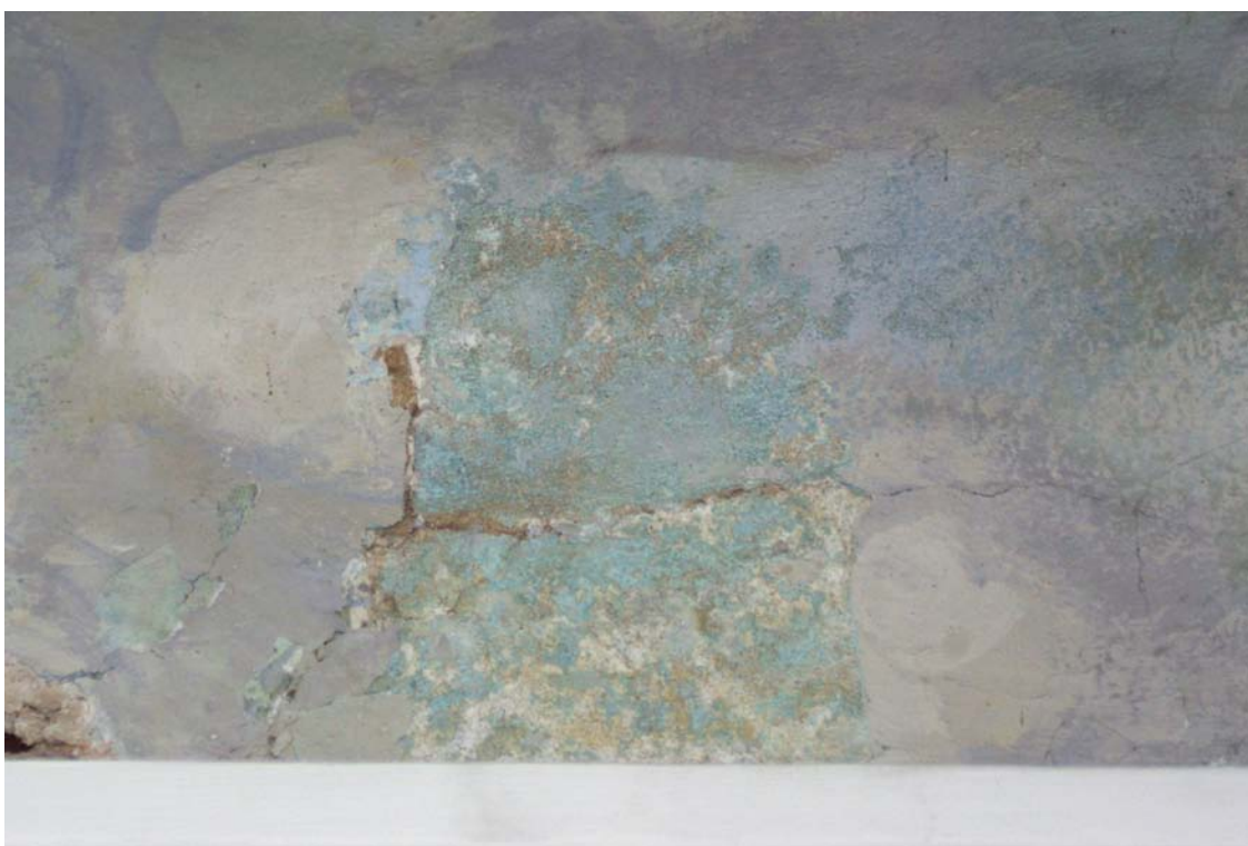
Zatečenie na strope kaplnky. Deštrukcia sa prejavuje spráškovatím originálnej farebnej vrstvy.
