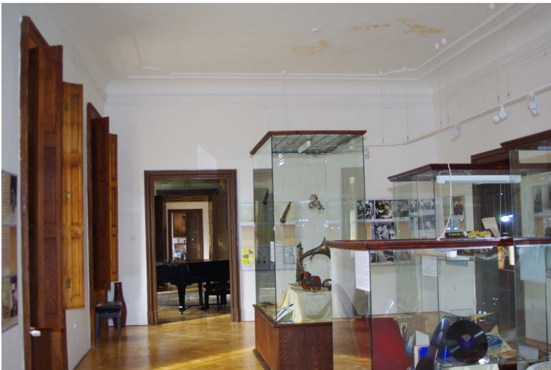
Pohľad do miestnosti č. 106. Viditeľné je zatečenie stropu.
