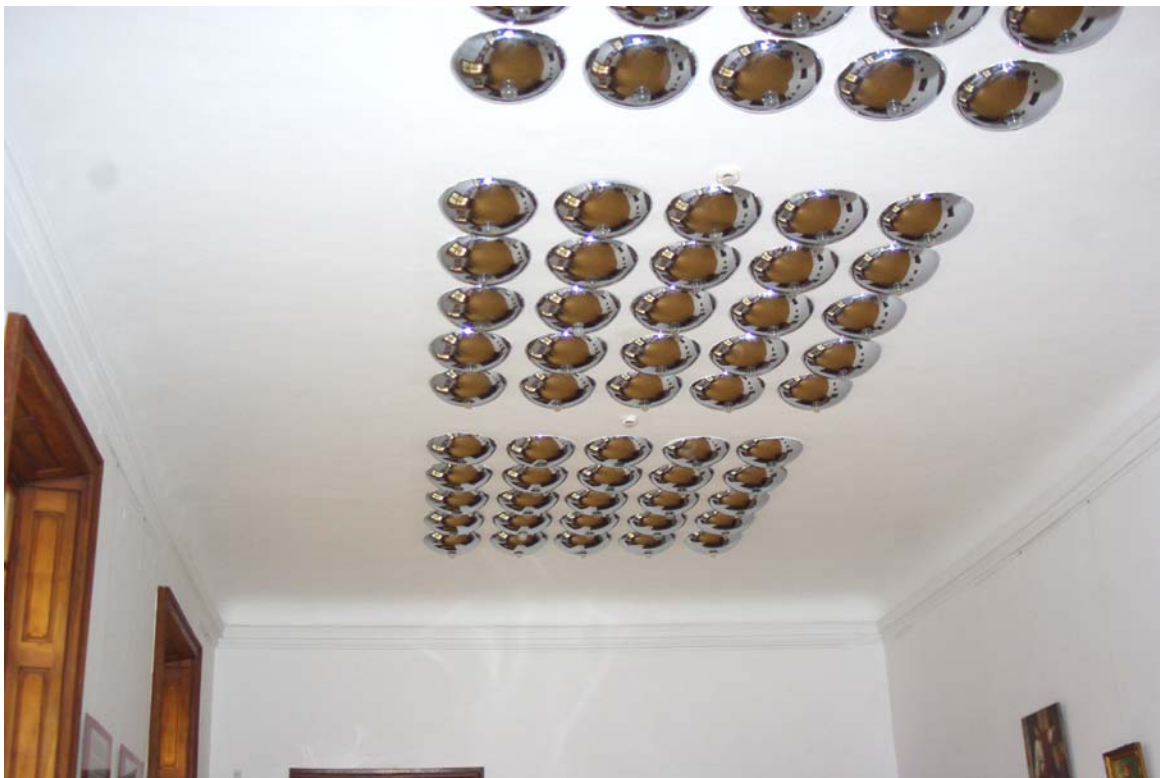
Pohľad na strop miestnosti č. 104
