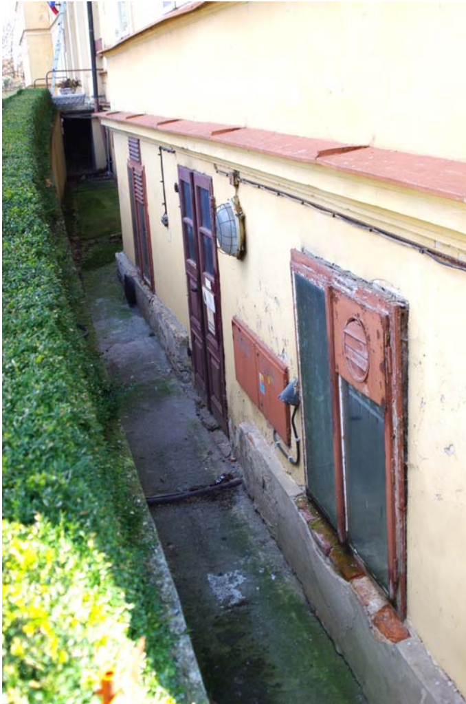
Pohľad na okná a exteriérovú severnú stenu suterénu s nevhodnými zásahmi, ktoré degradujú estetickú hodnotu objektu
