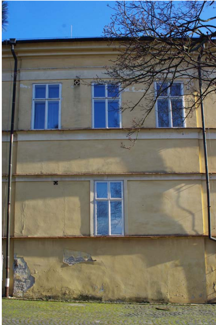
Pohľad na západnú fasádu kaštiela s deštrukciami vrstiev.
