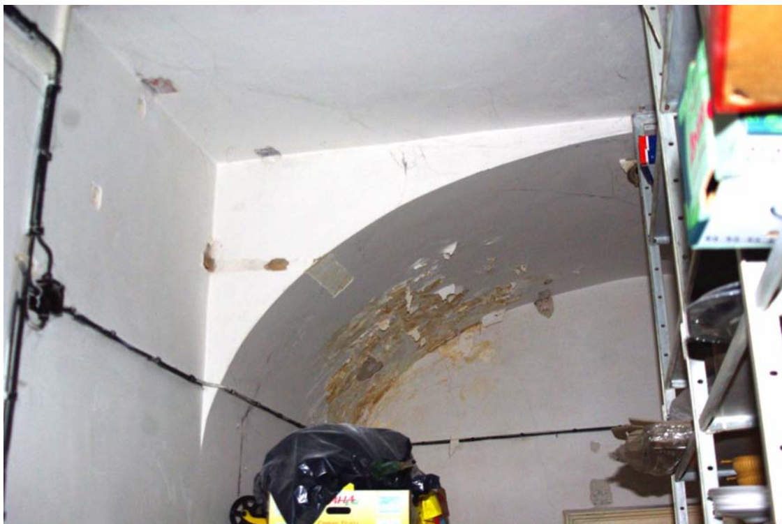
Pohľad na zatečenie klenby zrušenej empory v predelenej kaplnke. V súčasnosti skladový priestor.
