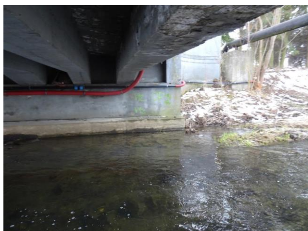
Pohled na OP2. Dochází k zatékání přes opěru. Byly detekovány protečená místa.
