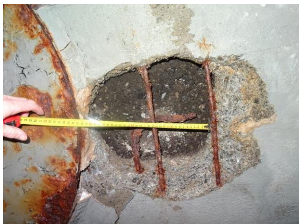
Viditelná porucha v betonu spodního líce vyložené konzoly ze strany výtoku u OP1. Chybějící beton, viditelná asfaltová vrstva vozovky.
