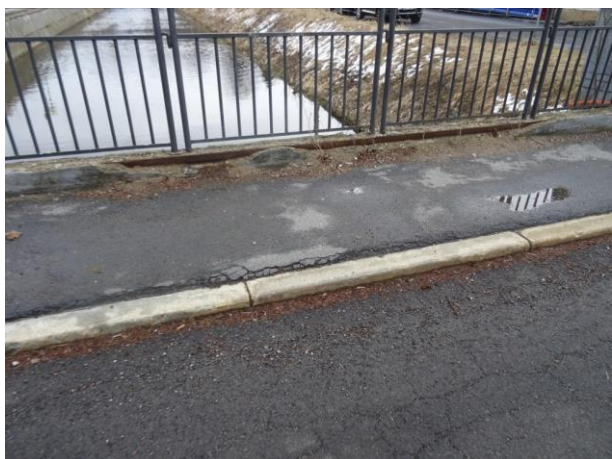
Nerovnost povrchu chodníku a vozovky, degradace betonu římsy konzoly desky NK.
