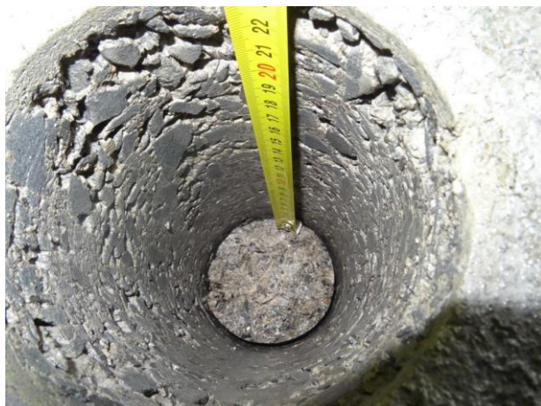
Pohled do vývrtu V12. Viditelná silně pórovitá struktura.
