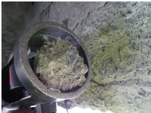
Pohled na kohezní poruchu betonu na trámu NK.
