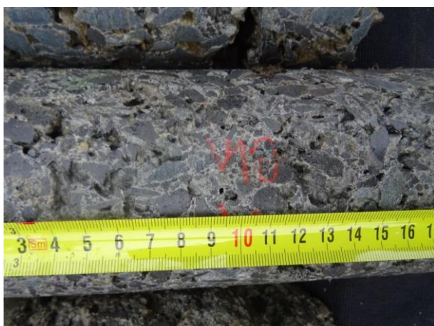
Pohled na vývrt V10. Silně pórovitá struktura betonu s malou objemovou hmotností. Chybějící cementový tmel, malá soudržnost.
