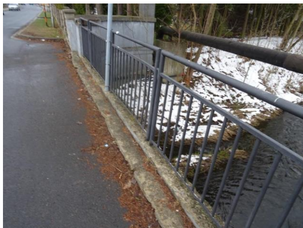
Pohled na ocelové zábradlí, degradace betonu římsy konzoly desky.
