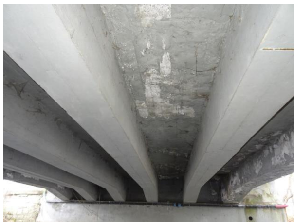
Protečení s výluhy na povrchu desky spodního líce jsou patrné i ve vnitřních polích.
