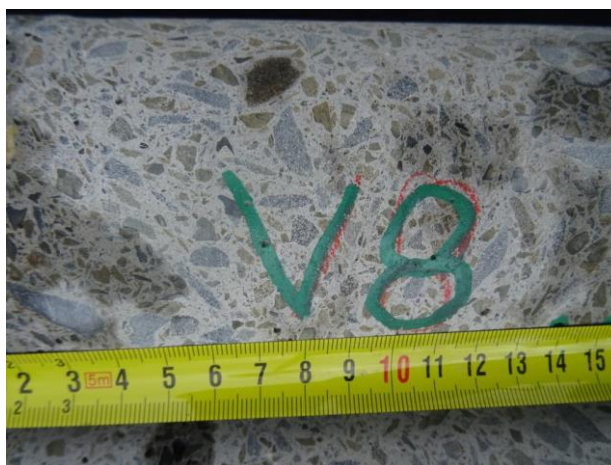
Detailní pohled na jádro vývrty V8.
