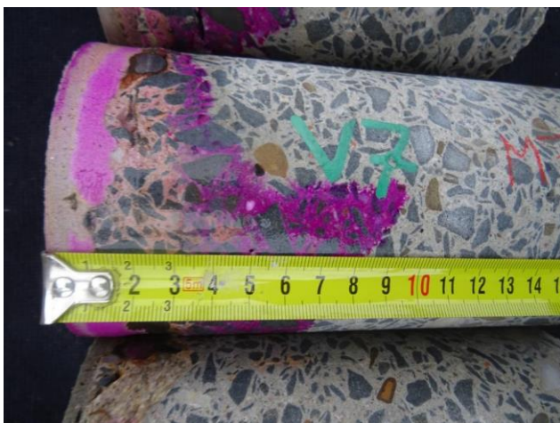
Karbonatce na vývrtnu V7 byla naměřena 35 mm.
