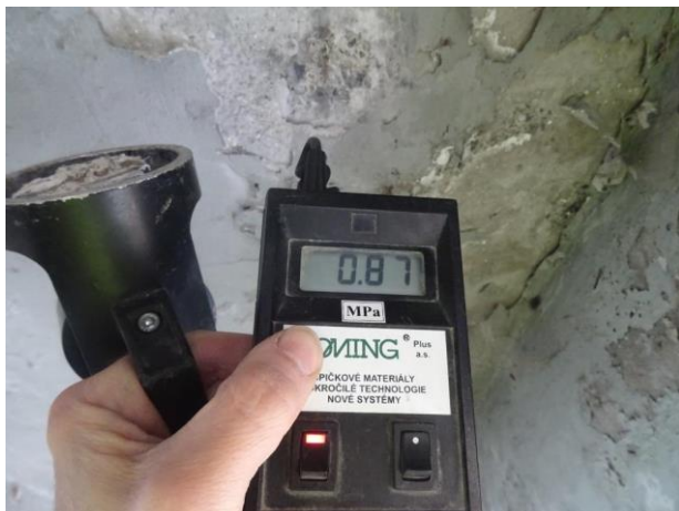
Porucha při hodnotě pevnosti povrchové vrstvy betonu v tahu 0,87 MPa.
