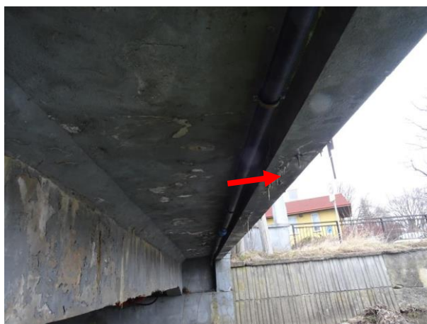
Pohled na konzolu ze strany výtoku. Viditelné inkrustace na zakončení konzoly, podélná trhлина v betonu.
