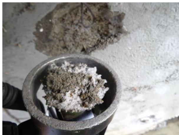
Pohled na kohezní poruchu v betonu.
