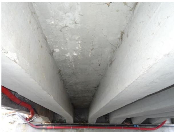
Celkový pohled na spodní líc NK. Při čtení zleva doprava T1 – T6. T4 byl detekován větší dimenze.
