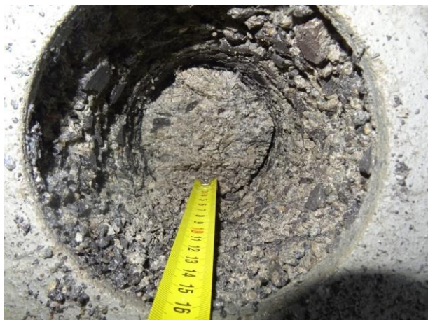
Pohled do vývrtu V9. Viditelný rozpad betonu.
