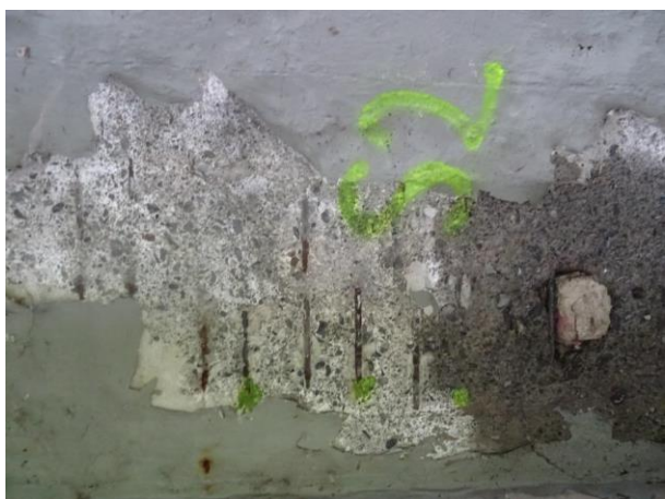
Pohled na sondu S2 do desky mezi trámy. Byla detekována hladká výztuž průměru 10 mm a 80 mm. Lokálně silná koroze s úbytkem do 10%.
