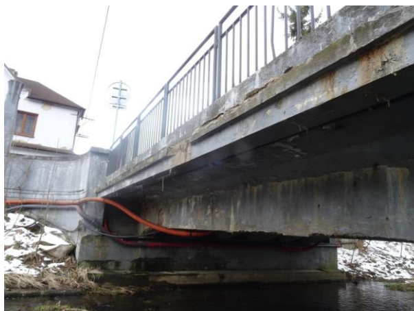
Celkový pohled na NK ze strany výtoku. Pohled k OP2. Silné zatékání do konstrukce, viditelné výluhy v betonu, silná degradace betonu římsy.
