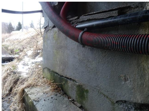
Viditelná podélná trhлина, přes kterou dochází k zatékání.
