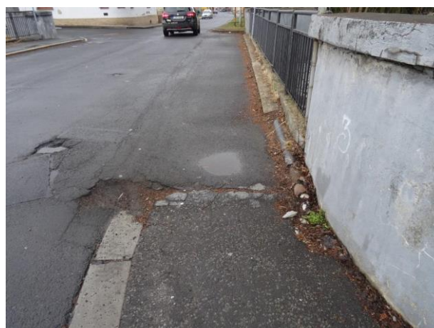
Pohled na pravou stranu (výtok). Viditelné defekty v asfaltovém krytu vozovky. Viditelná degradace betonové římsy
