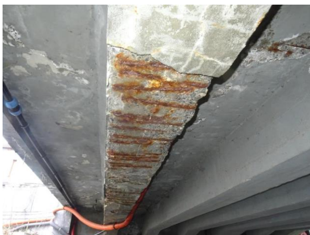
Pohled na T6. Odtržení krycí vrstvy. Viditelná koroze třmínků trámu.
