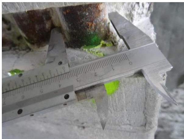
Pohled na výztuž. Byla detekována povrchová koroze bez úbytku na materiálu.
