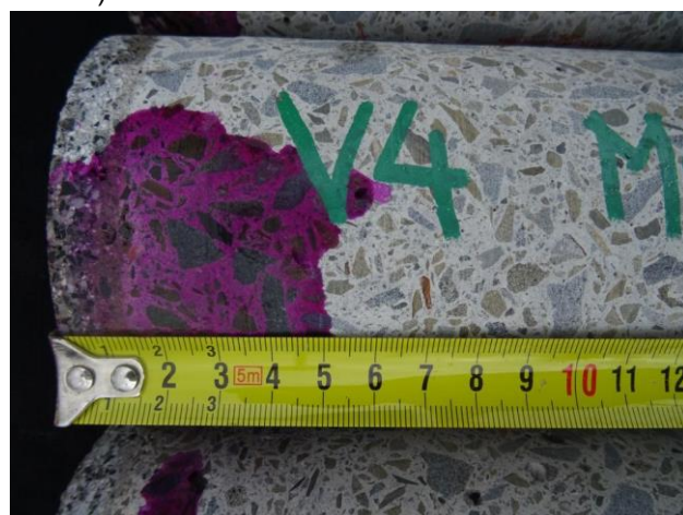
Karbonatce na vývrtnu V4 byla naměřena 10 mm (v omítce).
