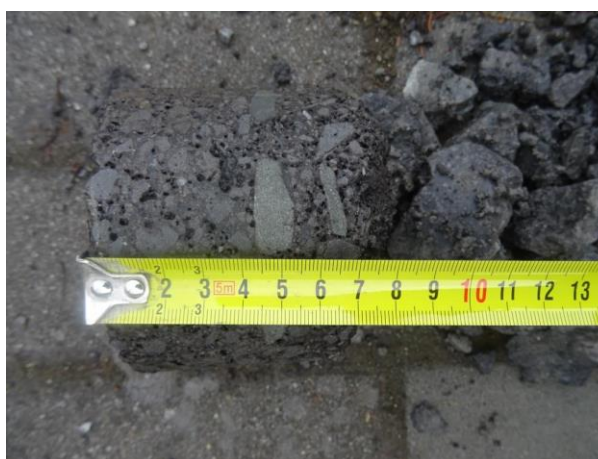
Tloušťka asfaltové vrstvy byla naměřena 80 mm.
