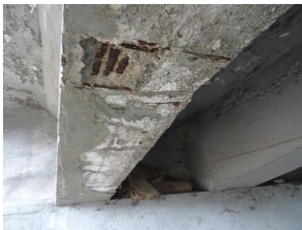
Pravá strana, trám T6, degradace krycí vrstvy, viditelná koroze hlavní výztuže trámu.
