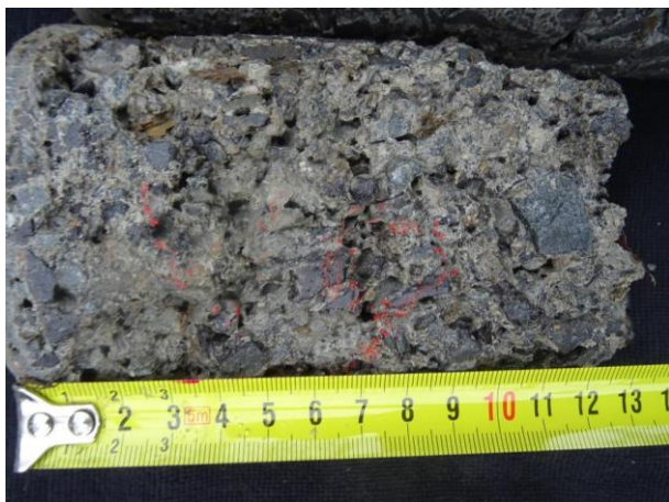
Pohled na vývrt V9. Silně pórovitá struktura betonu s malou objemovou hmotností. Chybějící cementový tmel, malá soudržnost.
