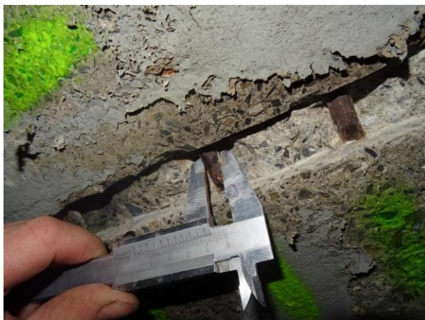
Sonda S2 - mírná povrchová až povrchová koroze bez úbytku na materiálu, krytí 10 mm.
