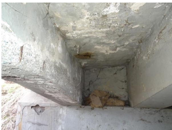
Pravá strana mezi T6 a T5. Viditelné protečení a degradace betonu desky mezi trámy.
