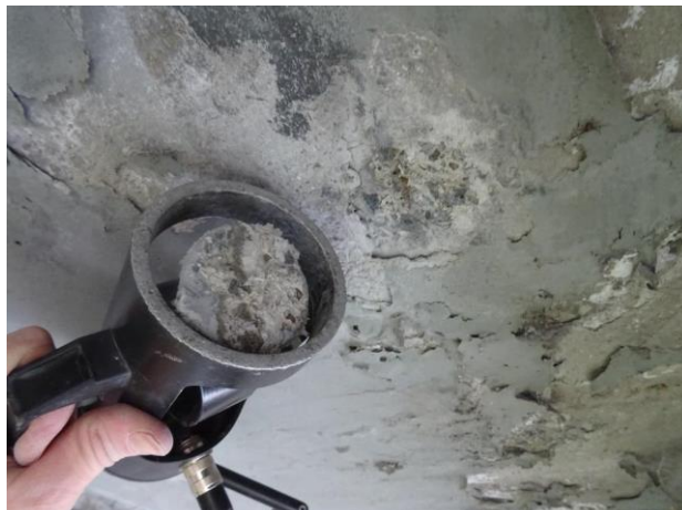
Pohled na kohezní poruchu v betonu.
