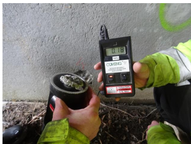
Pohled na kohezní poruchu v betonu zkoušky č. xx při hodnotě 0,18 MPa .
