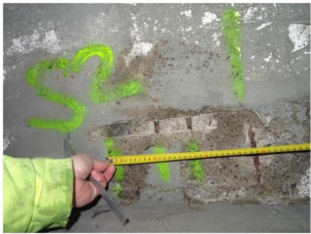
Pohled na sondu S2 do desky mezi trámy. Byla detekována hladká výztuž průměru 10 mm a 100 mm.
