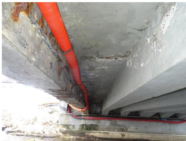
Pohled na trám T6 a konzolu ze strany výtoku. Degradace krycí vrstvy betonu trámu. Viditelné silné zatékání do konstrukce.
