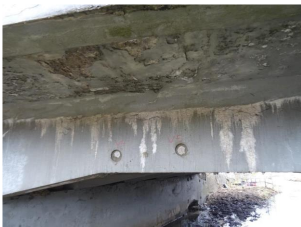
Pravá strana, pohled k OP1. Viditelné protečení NK. Výluhy z betonu na trámu a na spodním líci desky. Degradace betonu krycí vrstvy.
