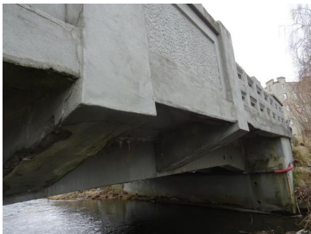
Pravá strana, pohled k OP2. Viditelné příčné trámy podepření vyložené desky. Velmi silná degradace betonu vzdušného líce NK.
