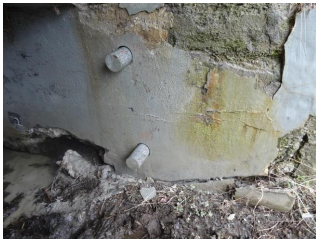
OP1 – levá strana, silná degradace povrchu betonu, viditelné podemletí dřívku opěry.
