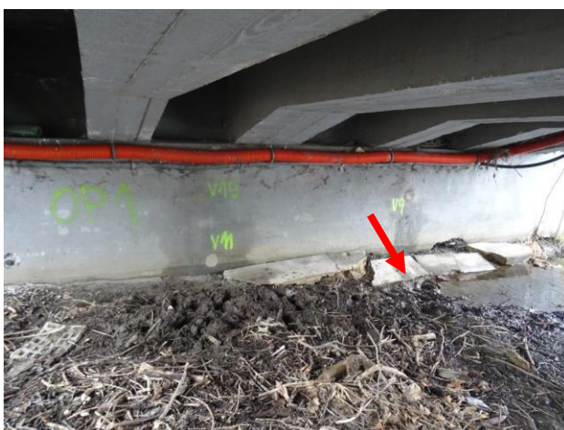
Pohled na OP1. Viditelný rozpad betonového opevnění paty opěry.
