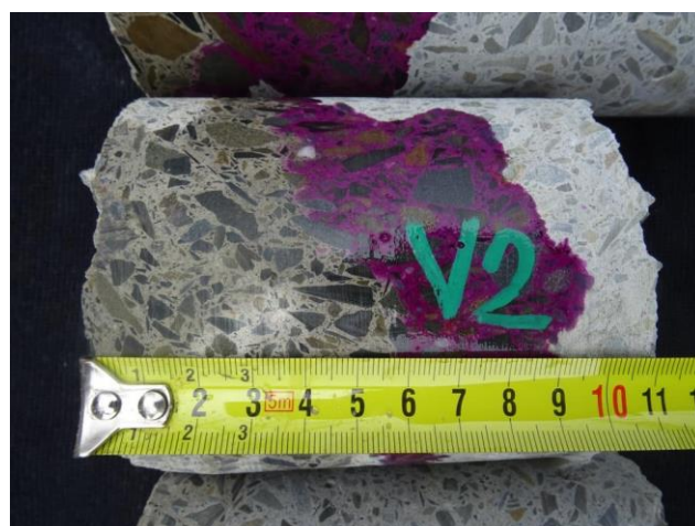
Karbonatce na vývrtu V2 byla naměřena 60 mm.
