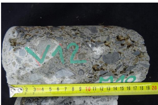
Pohled na vývrt V11. Pórovitá struktura betonu.
