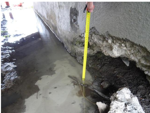
Detailní pohled na podemletí a rozpad betonu paty dříku opěry.
