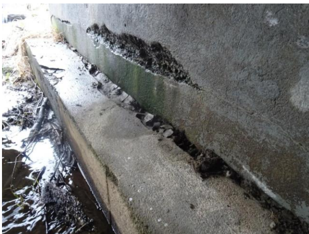
Detailní pohled na OP1. Viditelná degradace betonu dřívku a rozšířeného opevnění paty opěry.
