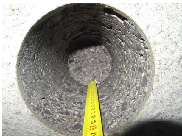
Pohled do vývrtu V10. Viditelná silně pórovitá struktura, přes kterou zatéká.
