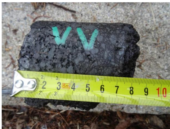
Pohled na asfaltovou vrstvu tl. 80 mm. Asfalt pórovitý, degradovaný.
