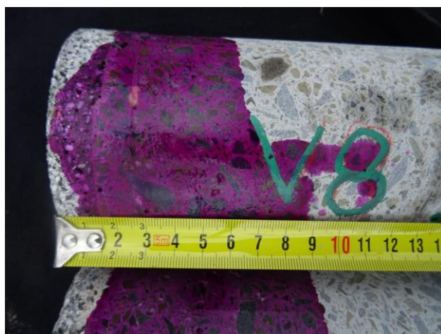
Karbonatace na vývrtu V8 byla naměřena 5 mm (v omítce).
