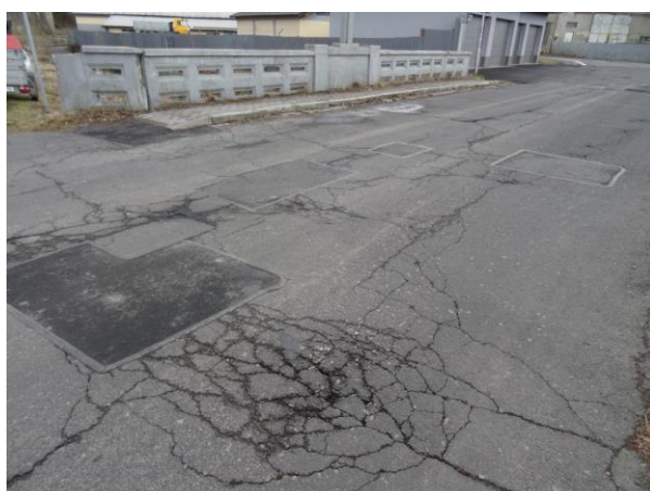
Deformace a konec životnosti asfaltového krytu vozovky.
