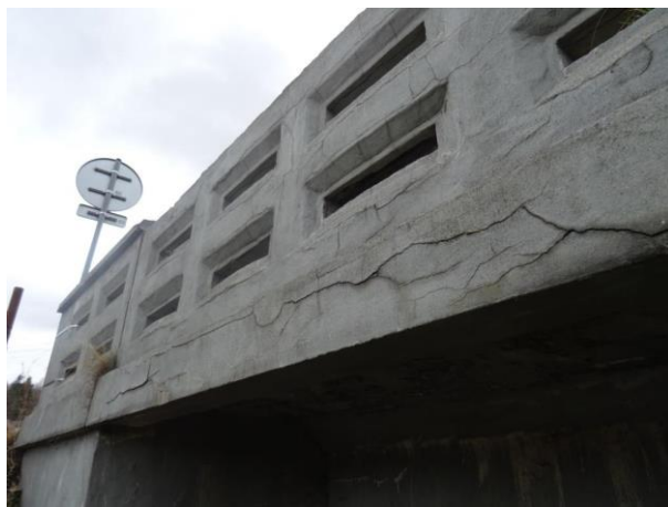
Levá strana, pohled k OP2. Železobetonová římsa navazující na železobetonové monolitické zábradlí. Mnohočetné trhliny v omítce, která již ztratila funkci.
