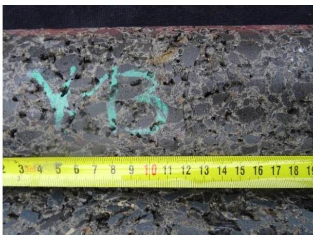
Pohled na vývrt V13. Silně pórovitá struktura betonu s malou objemovou hmotností. Chybějící cementový tmel, malá soudržnost.
