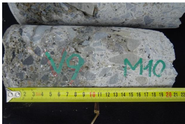
Pohled na vývrt V9. Pórovitá struktura betonu.
