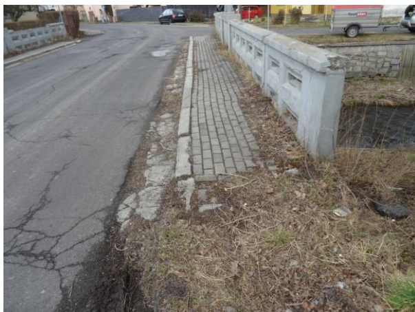
Pohled na levou stranu. Také deformace zámkové dlažby chodníku, velmi silná degradace betonu zábradlí, prorůstání vegetace.
