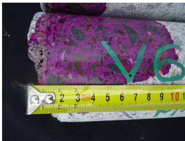
Karbonatace na vývrtu V6 byla naměřena 10 mm (v omítce).
