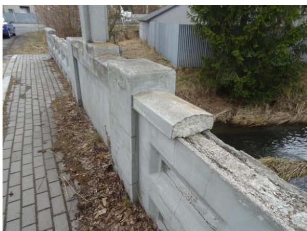
Chybí zákrytové desky zábradlí, hloubková degradace betonu, koroze výztuže zábradlí.
