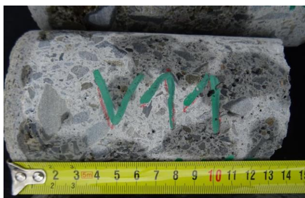
Pohled na vývrt V11. Pórovitá struktura betonu.
