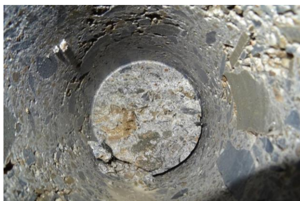
Pohled do vývrtu V12. Viditelná pórovitá struktura betonu ve vývrtu.
