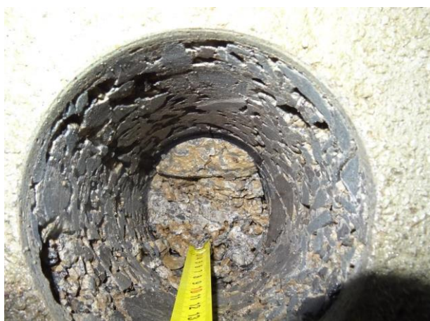
Pohled do vývrtu V11. Viditelná silně pórovitá struktura, přes kterou zatéká.
