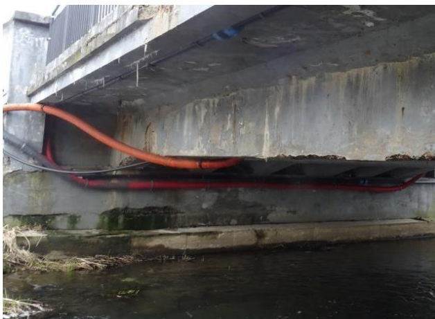
Pohled na OP2. Degradace betonu opevnění dřívku opěry. Degradace betonu dřívku, viditelná podélná trhлина, pravděpodobně pracovní spára, přes kterou silně zatéká.
