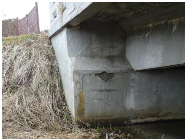
OP1 – pravá strana, silná degradace povrchu betonu. Viditelné zatékání přes opěry.
