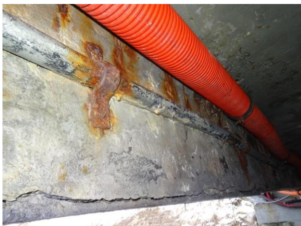
Detailní pohled na silné zatékání do konstrukce a odraženou krycí vrstvu betonu spodního líce trámu.
