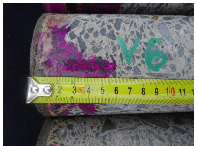
Karbonatce na vývrtnu V6 byla naměřena 20 mm.
