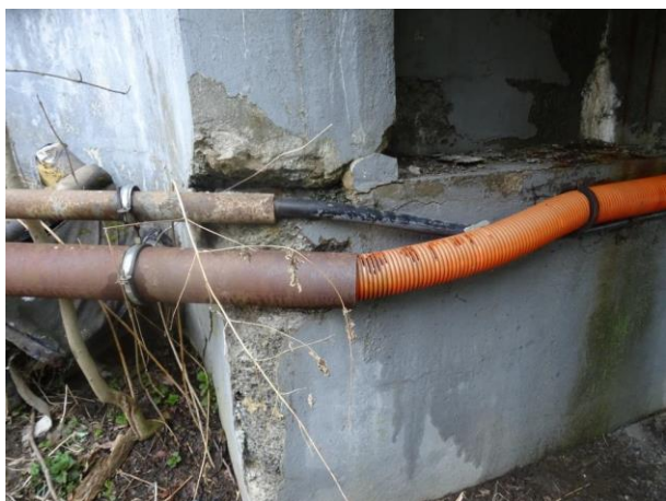
Pohled na trám T6, uložení na OP1. Odprysk betonu v oblasti spáry mezi ÚP a trámem.
