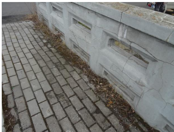
Detailní pohled. Viditelné trhliny v betonu zábradlí.
