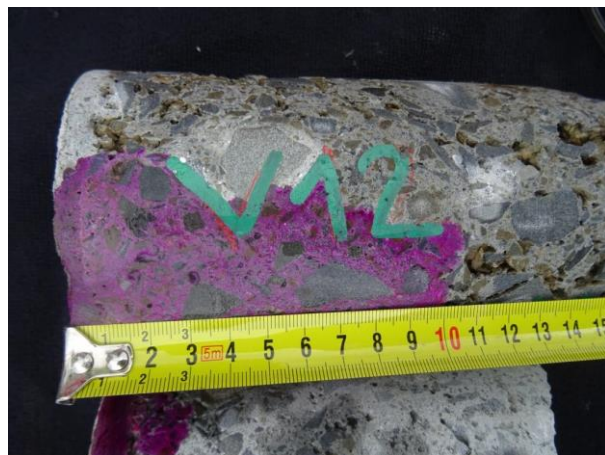
Vývrt V12, kde karbonatace omítky byla naměřena do 5 mm. Omítka chrání beton.
