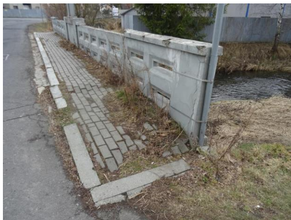
Pohled na pravou stranu. Deformace zámkové dlažby chodníku, silná degradace betonu zábradlí, prorůstání vegetace.
