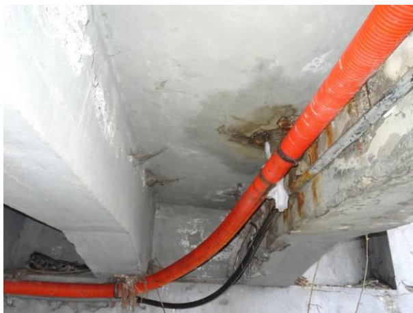
Pohled na T1 u OP1. Degradace krycí vrstvy betonu trámu. Degradace betonu vlivem nefunkčního odtoku vody prostupem.
