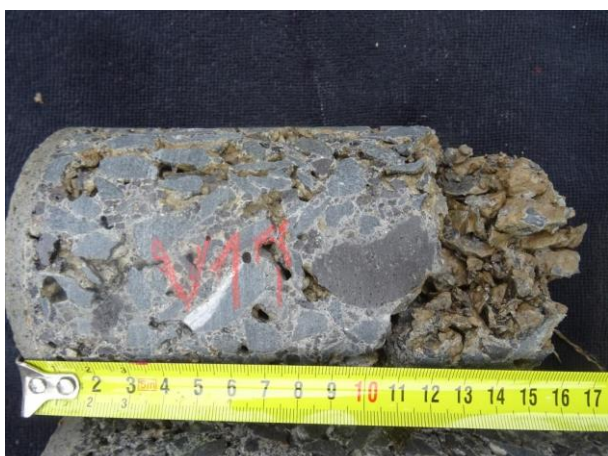
Pohled na vývrt V11. Silně pórovitá struktura betonu s malou objemovou hmotností. Chybějící cementový tmel, malá soudržnost.
