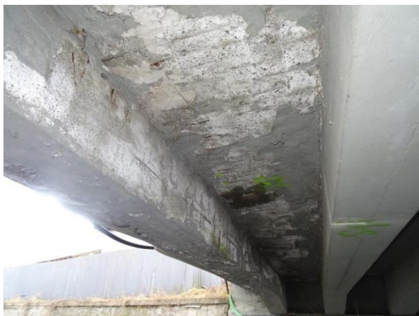
Levá strana, trám T, pohled k OP2. Protečení desky konstrukce, silná degradace krycí vrstvy betonu desky a spodního líce trámu.
