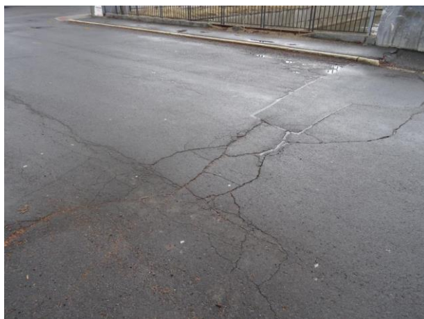
Pohled na deformaci krytu vozovky, pohled na levou stranu od OP2.
