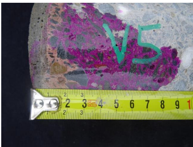
Karbonatce na vývrtnu V5 byla naměřena 25 mm.
