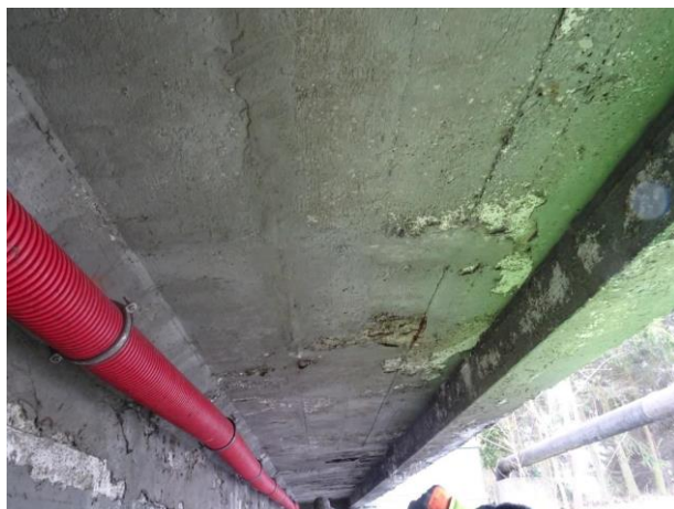
Pohled na trám T1 a konzolu ze strany výtoku. Degradace povrchu betonu.
