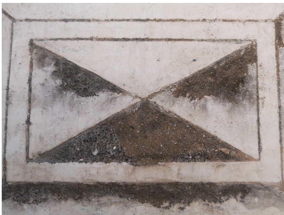
Oprava psaníčkového bosování kletováním s probarvenou spodní omítkou
