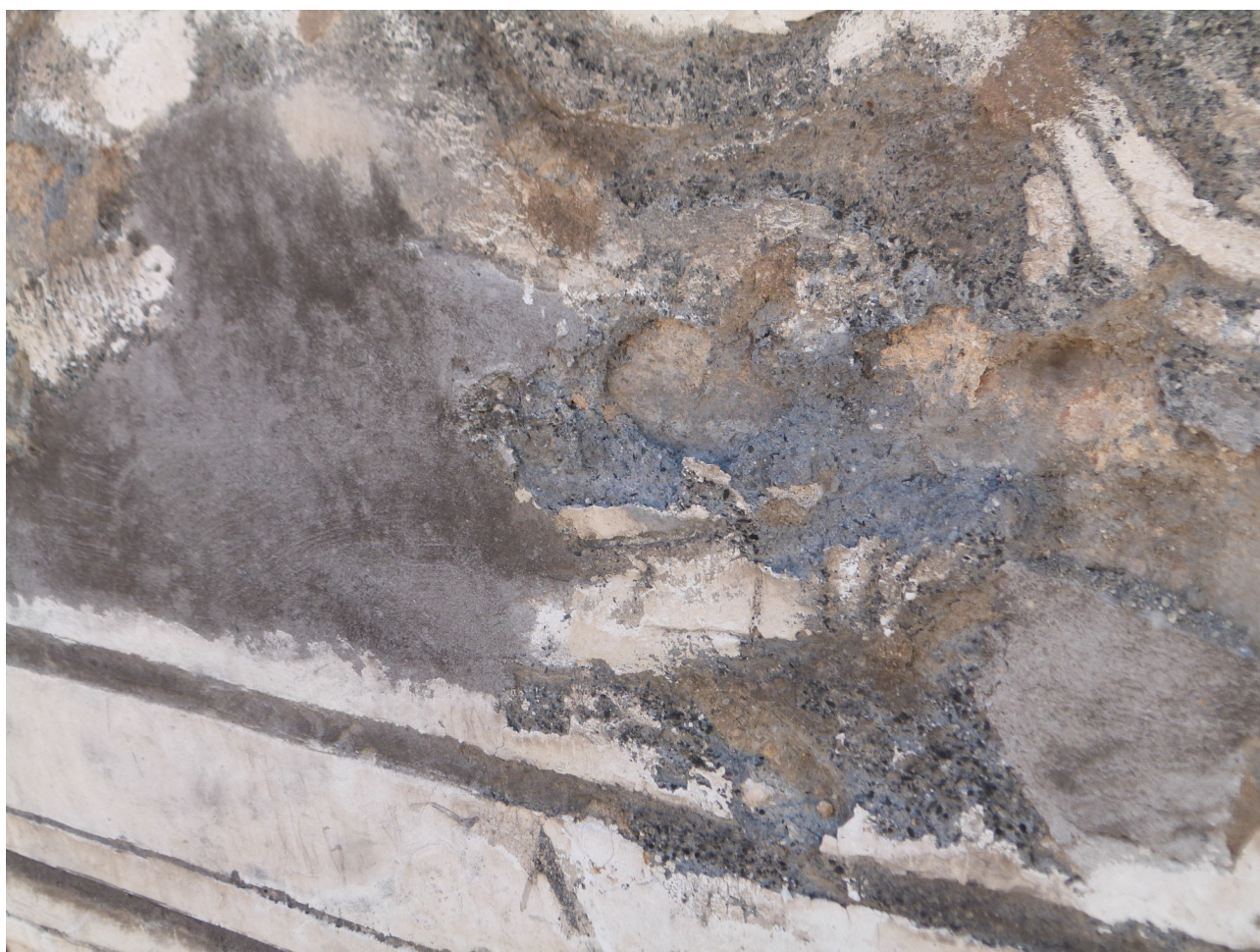
Různorodost oprav a degradace omítkových vrstev, šedé opravy jsou z tvrdých cementových materiálů, které zabraňují prodyšnosti vzdušnému vápennému originálu (část s černými částmi uhlí)
