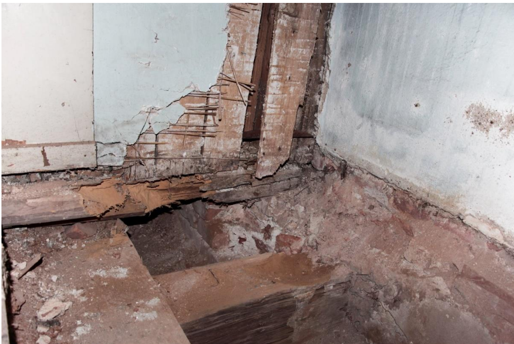
14. Prahový trám a spodní konce sloupku skeletové konstrukce příčky ve 3.NP, těžce poškozené dřevomorkou a červotočem.
