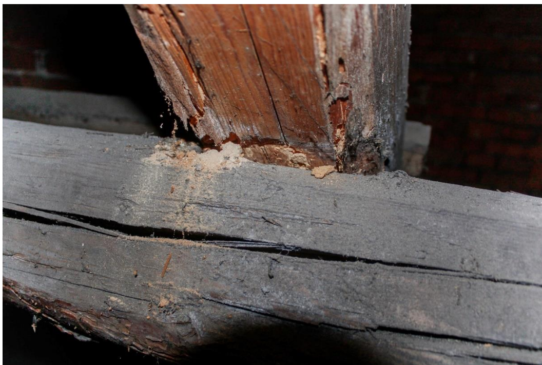
7. Příklad charakteristického znaku aktivity tesaříka v konstrukci krovu - čerstvé výletové otvory v krokvi.
