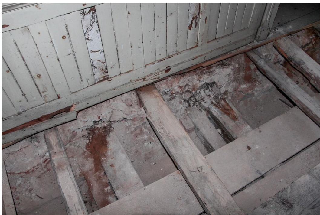
10. Pohled do pásové sondy do stropu nad 2.NP ze strany 3.NP. Drtivá většina stropních i podhledových trámů je těžce poškozena dřevomorkou a červotočem. Napadení zde přechází i do dřevěného obložení stěny.
