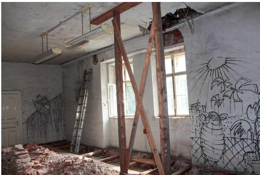
9. Dočasná výdřeva havarijního stropu nad 3.NP v oblasti zatékání úžlabím hlavního vikýře (viz. snímek č. 8).
