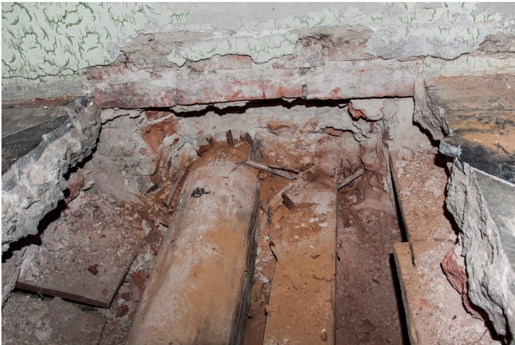
16. Detail sondy do stropu nad 2.NP na severním konci chodby ve 3.NP. Zhlaví stropních trámů u obvodové zdi jsou značně poškozena dřevomorkou a červotočem. Na spodním líci záklopu rozměrné syrcium - viz. další snímek.
