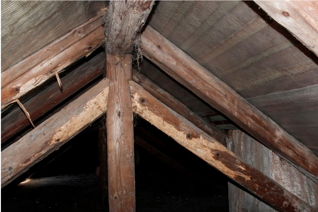
3. Plná vazba krovu, značně poškozená aktivním působením tesaříka krovového.
