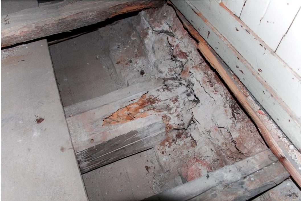
11. Detail těžkého poškození stropního trámu nad 2.NP u obvodové zdi, způsobeného dřevomorkou a červotočem.
