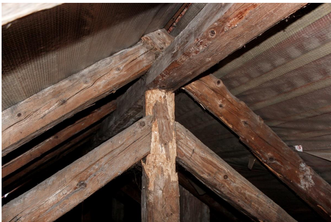
2. Plná vazba krovu, značně poškozená aktivním působením tesařika krovového.
