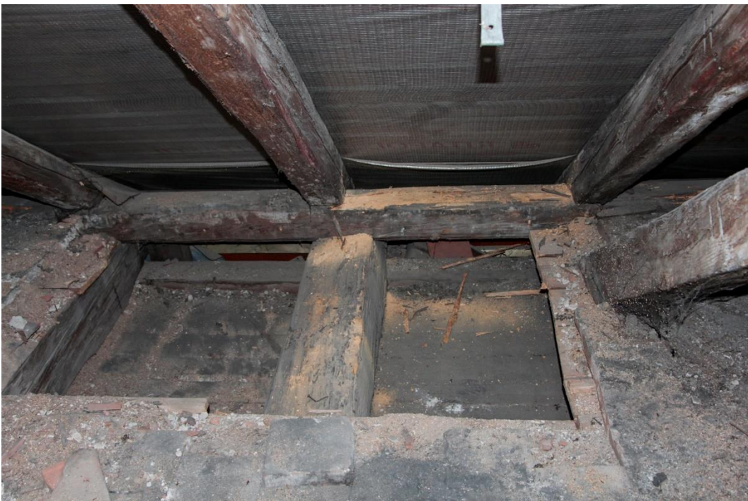
4. Spodní vaznice a vazný trám krovu na východním průčelí středně silně poškozené aktivním napadením tesaříkem
