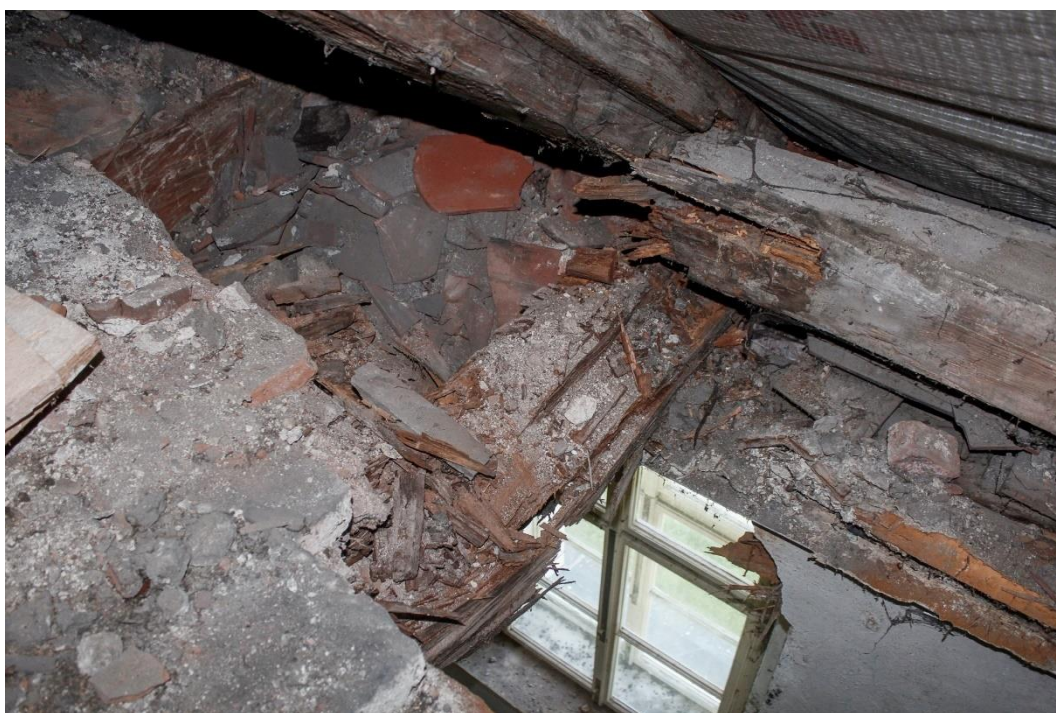
8. Havarijní strop nad 3.NP v oblasti zatékání úžlabím hlavního vikýře při pohledu z půdního prostoru. Stropní (resp. vazné) trámy, pozednice a konce krokvi jsou silně poškozeny dřevomorkou, konioforou a červotočem.
