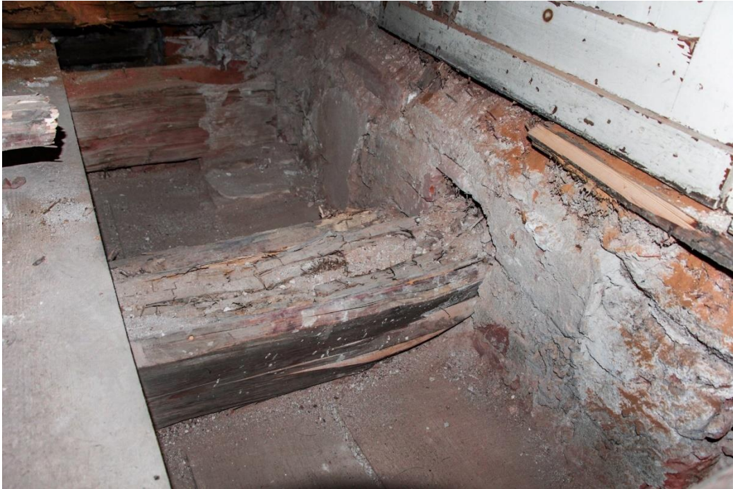
13. Havarijní stav stropního trámu nad sociálním zařízením expozice Thonet ve 2.NP. V této části půdorysu je nezbytné stropní konstrukci dočasně podepřít.
