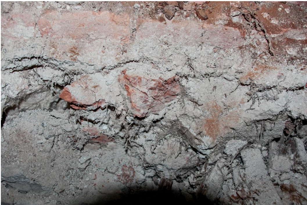
12. Mycelium dřevomorky, prorůstající spárami mezi cihlami do hloubky zdiva v oblasti styku stropu nad 2.NP. V těchto případech je nutná hloubková sanace zdiva biocidní injektáží.
