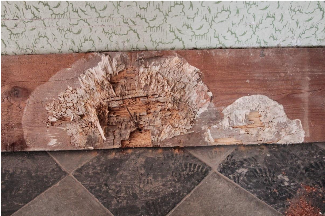
17. Rozměrné syrociom dřevomorky na spodní straně záklopu stropu nad 2.NP na chodbě, v místě sondy na snímku č. 16.
