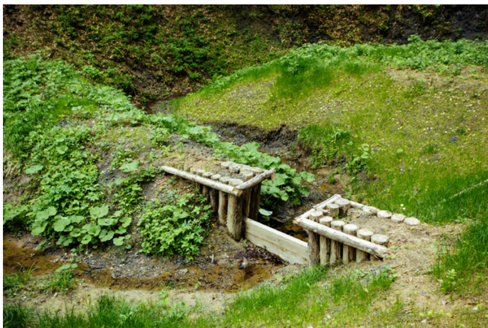
Fot. 31. Nawet małe zastawki wymagają wzmocnienia przyróżków w celu przeciwdziałania parciu wody (archiwum CKPŚ)
