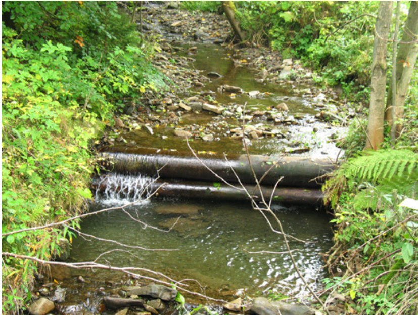
Fot. 130. Erozja dna poniżej progu – brak ubezpieczenia niecki wypadowej, Nadleśnictwo Andrychów, 2005 (fot. L. Książek)
