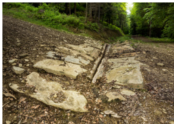
Fot. 107. Wodospust odprowadzający wodę z drogi do lasu, Nadleśnictwo Łosie (archiwum CKPŚ)
