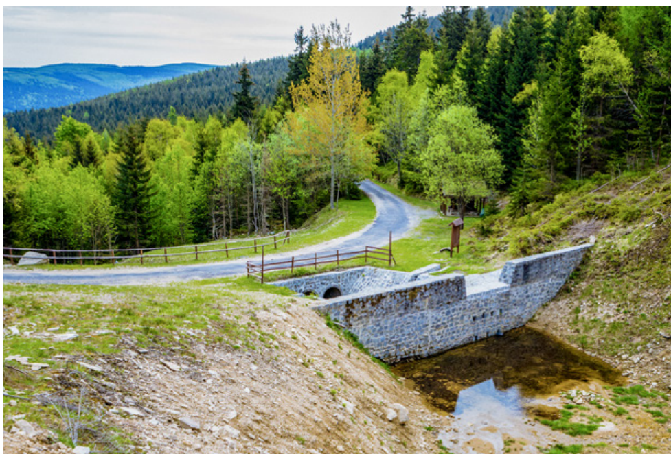
Fot. 139. Opróżniona z zalegającego rumoszu wysoko położona na zboczu góry zapora w Nadleśnictwie Świeradów (archiwum CKPŚ)
