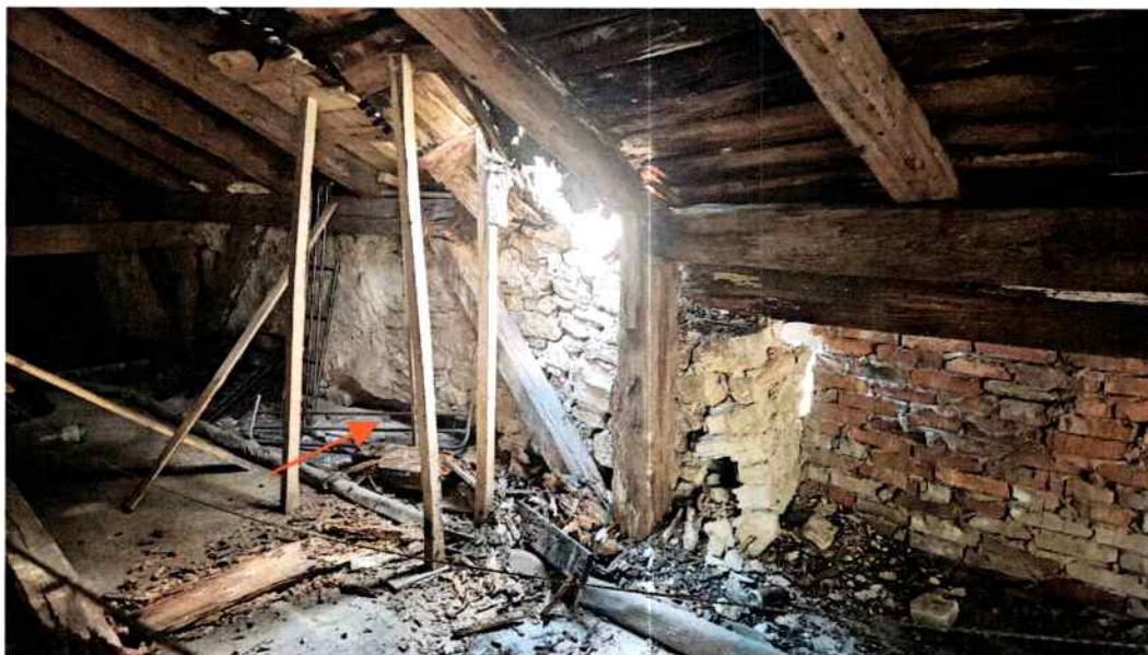
Częściowo zawalona północna ściana kolankowej na strychu. Widoczna bruzda wykuta w ścianie tuż nad stropem, będąca w dużej mierze przyczyną utraty stateczności ściany.
