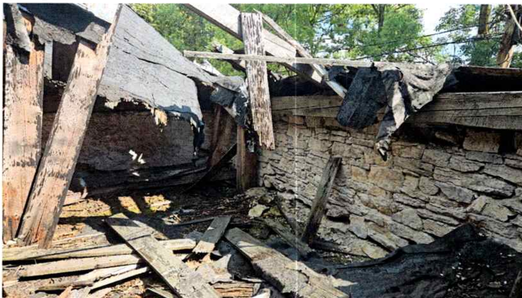
Załamanie elementów więźby w południowo – wschodnim narożniku.
