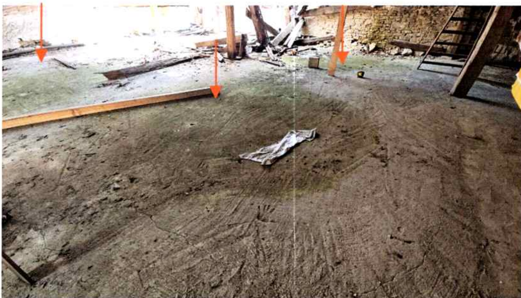
Widoczne ślady po zastoinach wodnych, powstałych na skutek przeciekania dachu w miejscach znacznego ugięcia płyty stropowej
