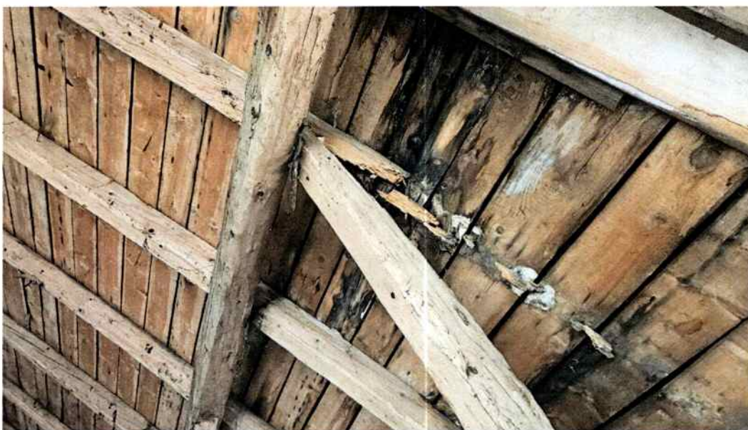
Złamanie krokwi na skutek daleko posuniętej korozji biologicznej.
