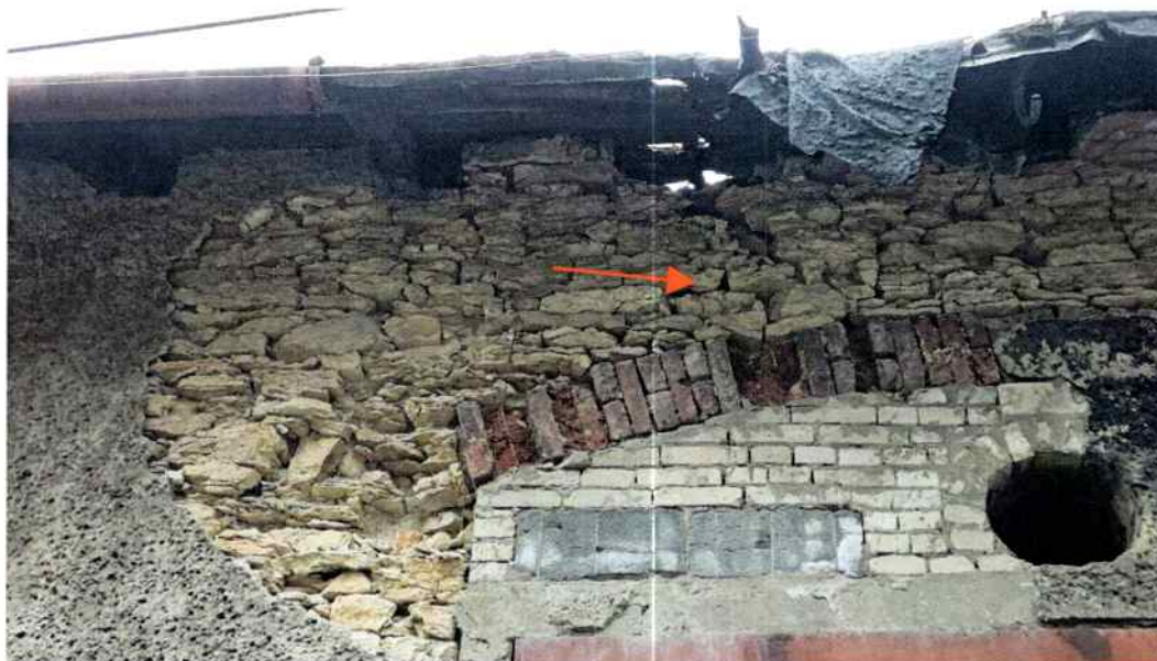
Uszkodzona ściana na elewacji południowej. Widoczne pionowe pęknięcia, wykruszone elementy muru kamiennego.
