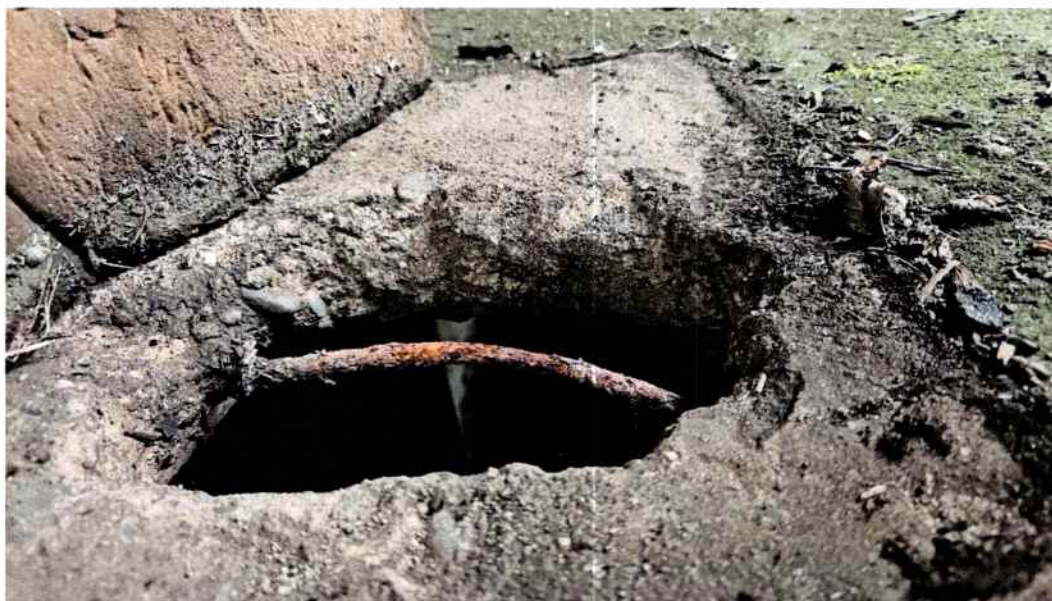
Perforacja płyty stropowej w widocznym, skorodowanym zbrojeniu
