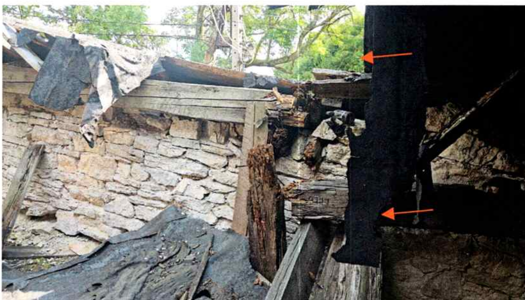
Załamanie elementów więźby połaci południowej.
