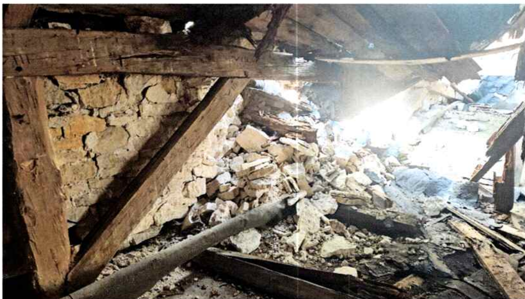
Częściowo zawalony kolejny fragment północnej ściany kolankowej na strychu.
