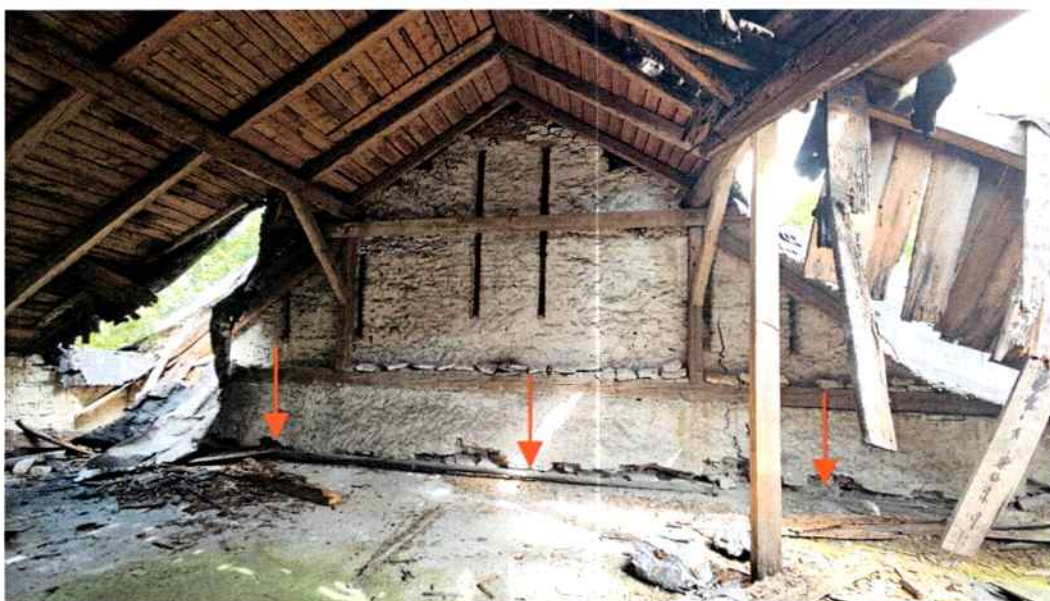
Widok na wschodnią ścianę szczytową od wewnątrz. Strzałkami oznaczono podkucie ściany na strychu na głębokość od 20cm do 40cm dla oparcia stropu (około 2/3 całkowitej grubości ściany).
