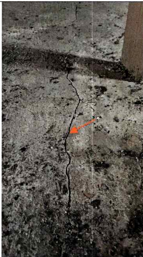
Pęknięcie górnej powierzchni płyty stropowej
