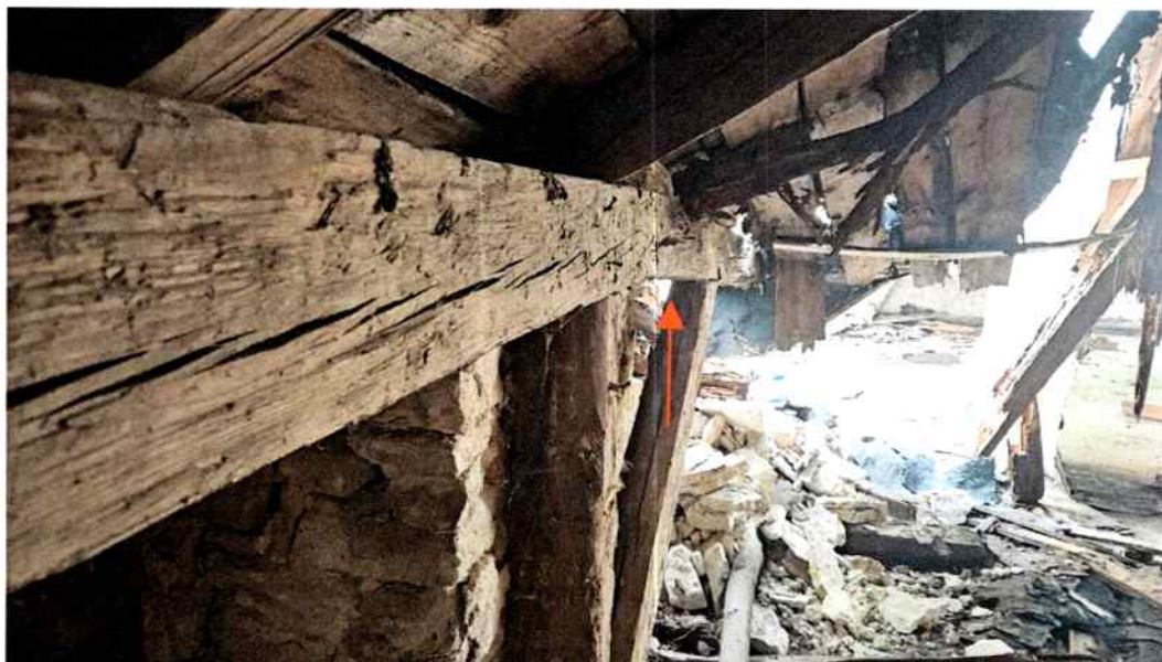
Uszkodzona płatew pełniąca rolę murłaty. Strzałką oznaczono złamanie tego elementu. Na skutek częściowego zawalenia się ściany doszło także do przemieszczenia poziomego płatwi.
