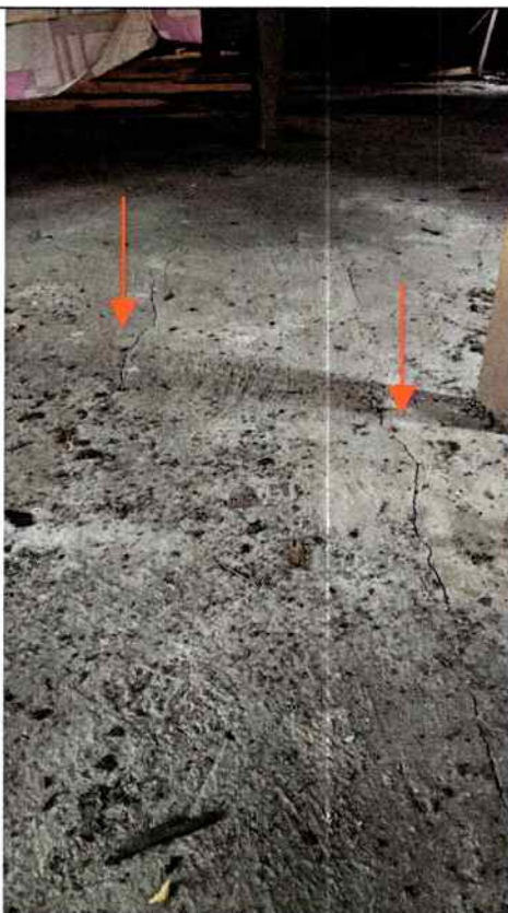
Pęknięcie płyty stropowej obustronnie nad podciągami
