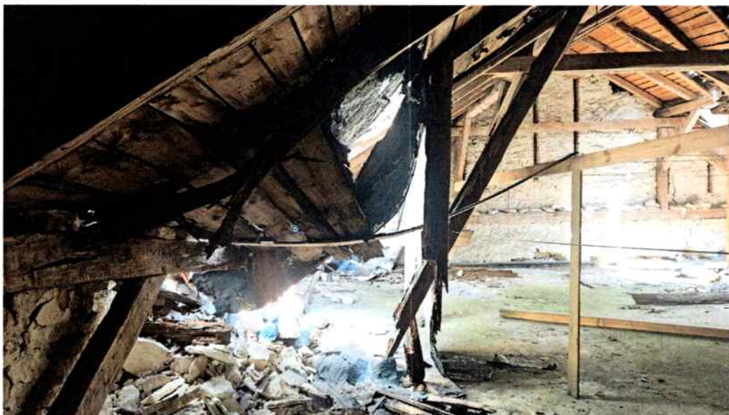
Załamanie elementów więźby połaci północnej.
