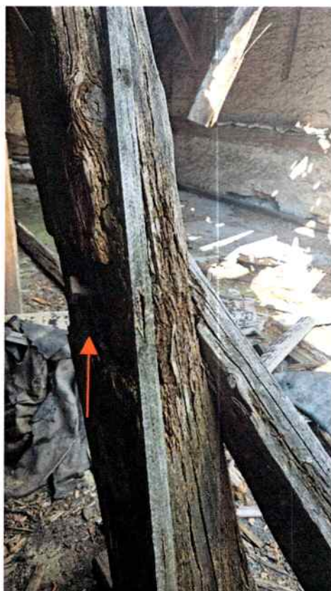
Zmurszały słup nośny układu wieszarowego na skutek daleko posuniętej korozji biologicznej. Widoczne po lewej stronie wyłamanie elementu spinającego więz (pozostała tylko śruba mocująca).
