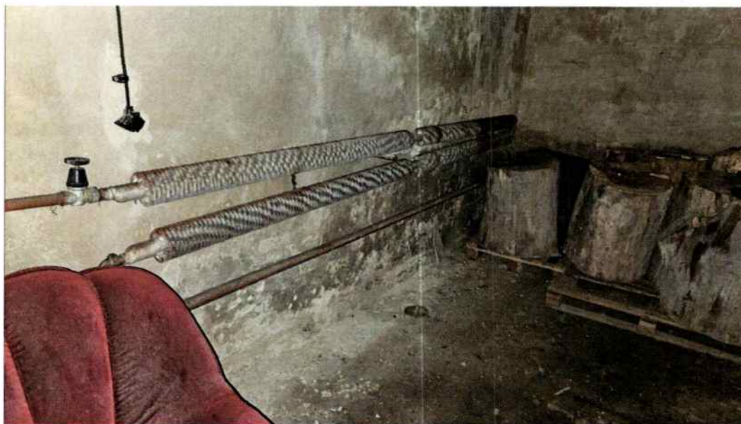
Elementy instalacji c.o.
