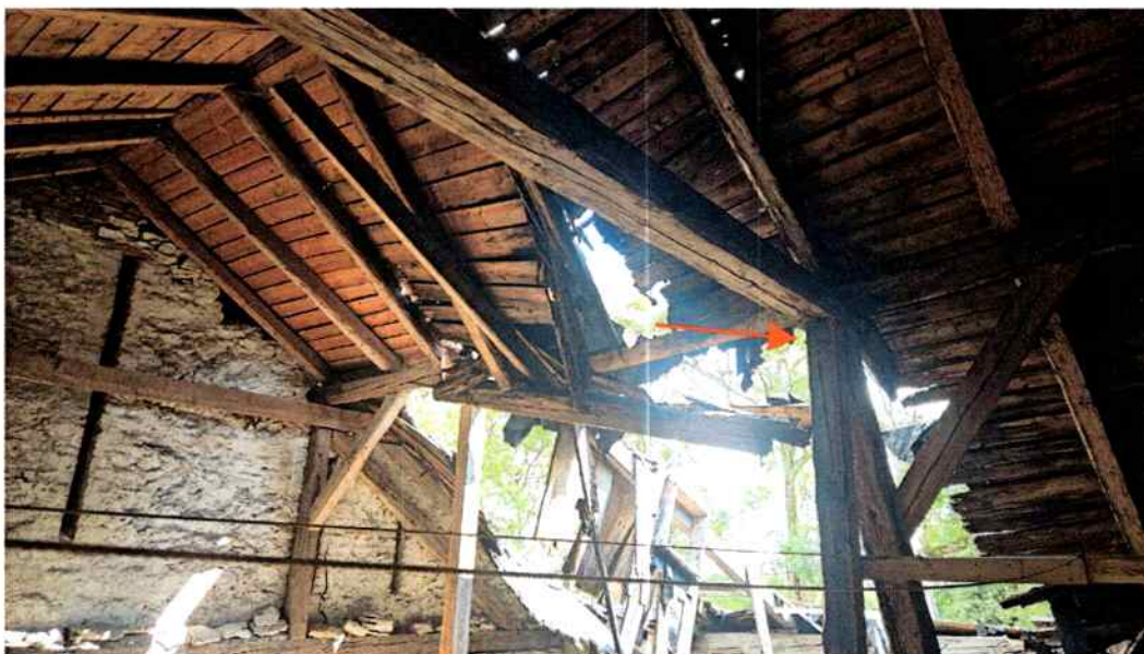
Zawalony fragment południowej połaci dachu. Strzałką oznaczono lokalizację układu wieszarowego konstrukcji dachu.
