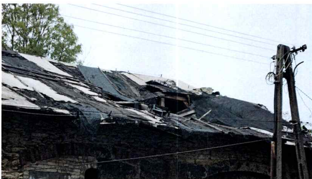
Załamania południowej połaci dachu
