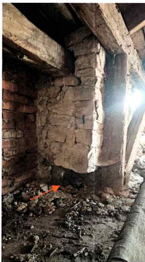
Widoczne około 40cm podkucie północnej ściany kolankowej na strychu (około 2/3 całkowitej grubości ściany).
