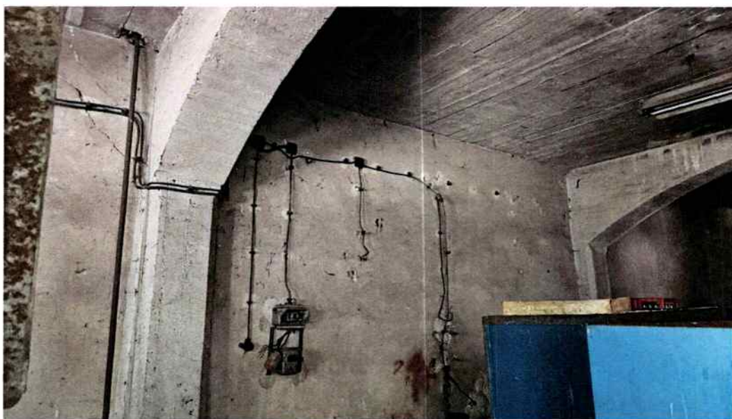
Uszkodzone elementy instalacji elektrycznej.
