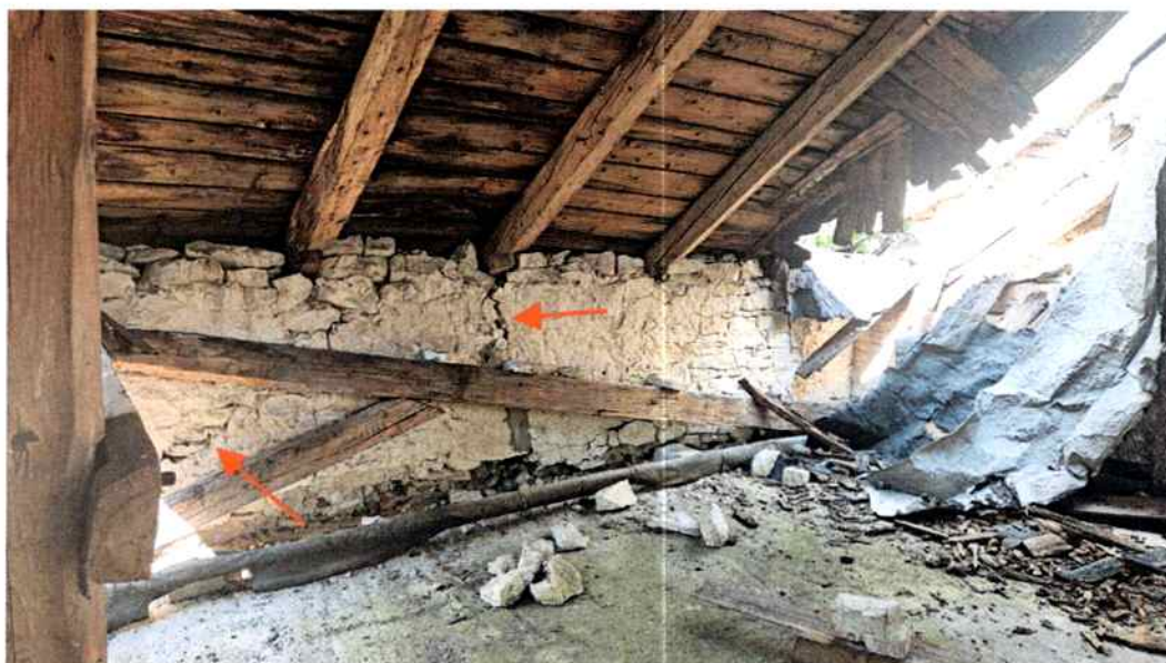
Pęknięcia ścian w północno – wschodnim narożu budynku. Fragment tej ściany jest wychylony od pionu
