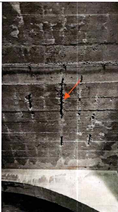
Widoczne odkryte i skorodowane pręty zbrojeniowe płyty stropowej w pomieszczeniu magazynowym po stronie zachodniej
