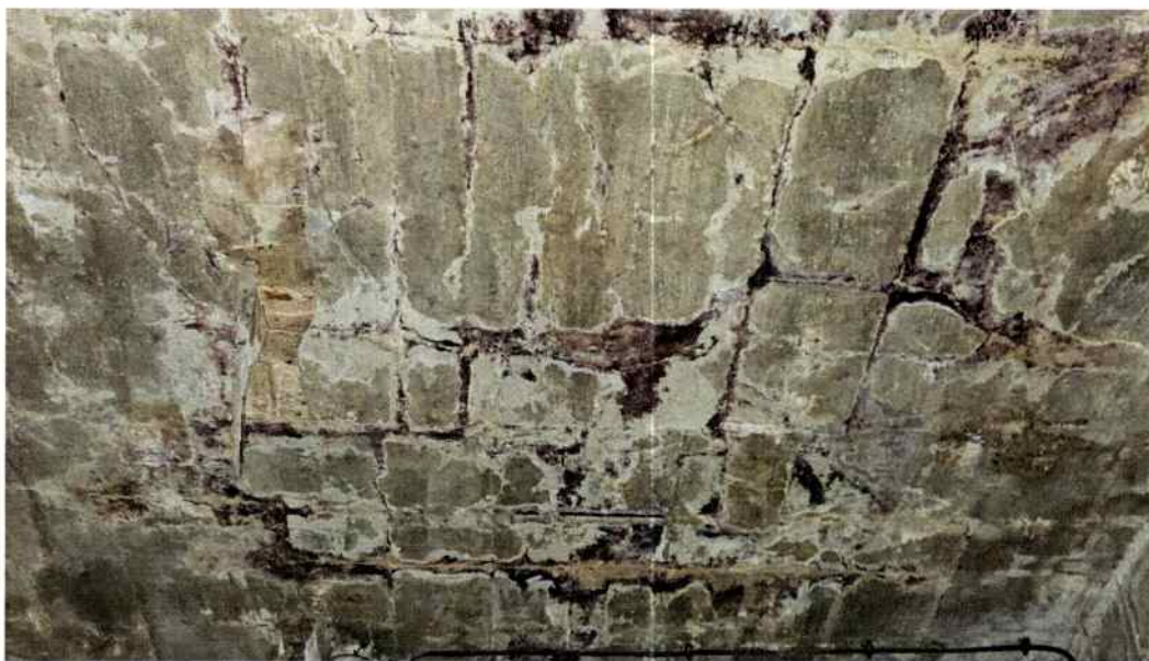
Widoczne odkryte i skorodowane pręty zbrojeniowe płyty stropowej oraz ślady zawilgoceń w pomieszczeniu magazynowym po stronie zachodniej
