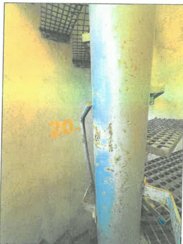
Fot. 16 Typowa korozja elementów klatki schodowej wieży H=20m
