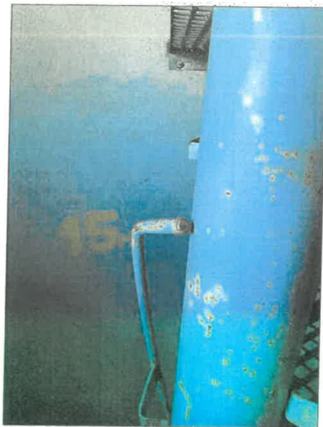
Fot. 11 Korozja elementów klatki schodowej wieży H=15m
