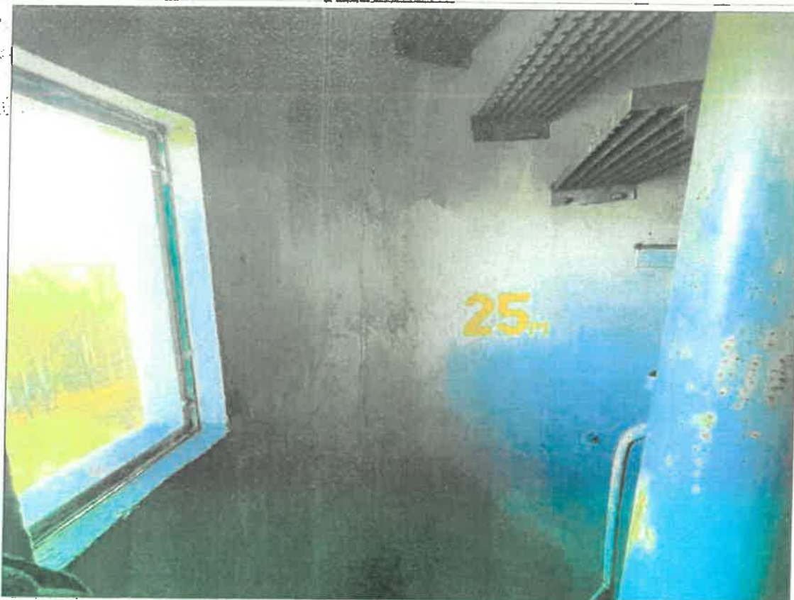
Fot. 21 Poziom H=25m – dobry stan stopni klatki schodowej, spocznik, słup, poręcz i wsporniki do renowacji
