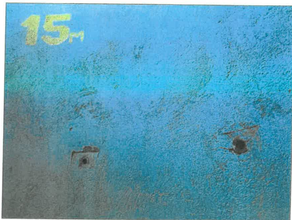
Fot. 12 Powierzchnia wewnętrzna wieży H=15m – włoskowate rysy pionowe i poziome
