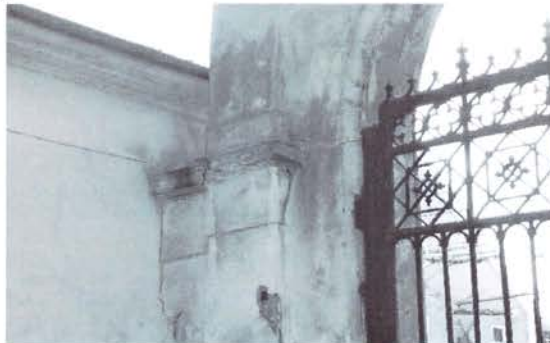
obr.19 trhlina v styku so susednou prícestnou kaplnkou
