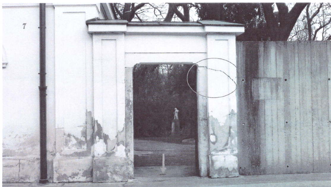
obr.28 Brána pre peších – pohľad z ul.29.augusta s vyznačením trhliny a kanalizačnej vpuste
