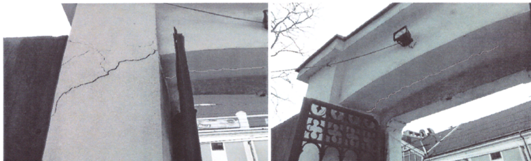
obr.35 – 36 Brána pre peších – pohľad zvnútra – detaily trhlín
