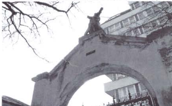
obr.18 trhlina pod korunou južnej plochy
