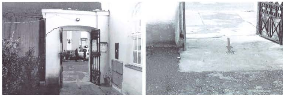
obr.29 – 30 Brána pre peších – pohľad zvnútra cintorína s vyznačením trhlíny a kanalizačnej vpuste
