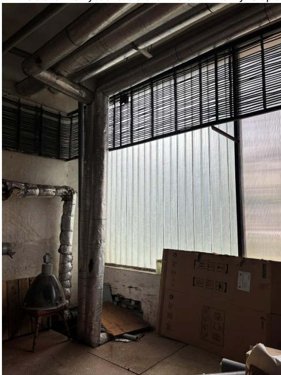
Obrázok 13 Výbuchová stena v kotolni + hlavný vstup do objektu
