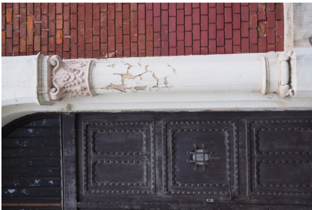
Foto č. 42: Pohľad zo SV, nárožný rizalit, detail poškodenia vstupného portálu.
