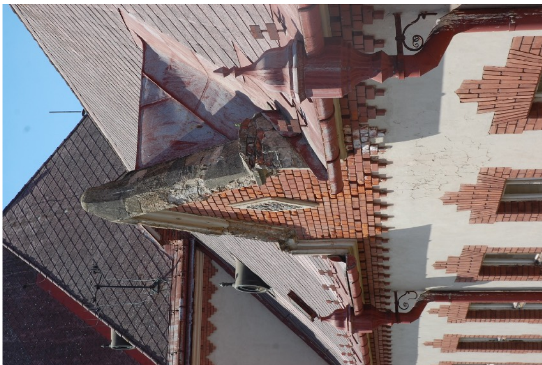
Foto č. 190: Pohľad z lešenia na Z, dvorová fasáda, časť tzv"veľký dvor", časť S krídla s atikovým štítom, detail poškodenia.
