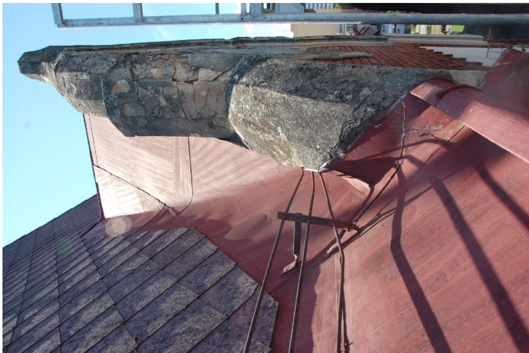
Foto č. 143: Aktuálny stav: detail strechy s atikovým štítom, detail poškodenia.
