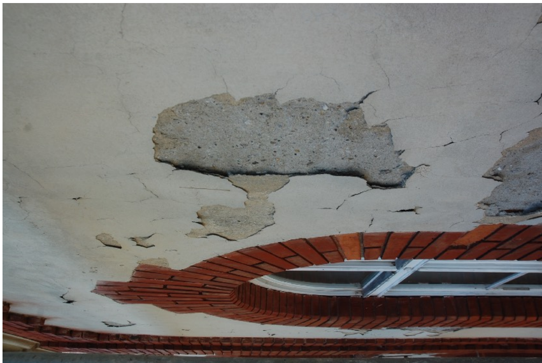
Foto č. 157: Stredový hlavný ríزالit S fasády, centrálna časť, 3.NP, detail poškodenia.
