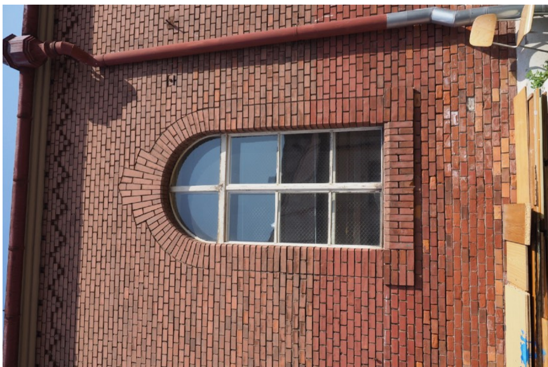
Foto č. 109: Pohľad na časť fasády prístavby aktuálnej telocvične, dvorová fasáda, časť tzv "veľký dvor", detail poškodenia.
