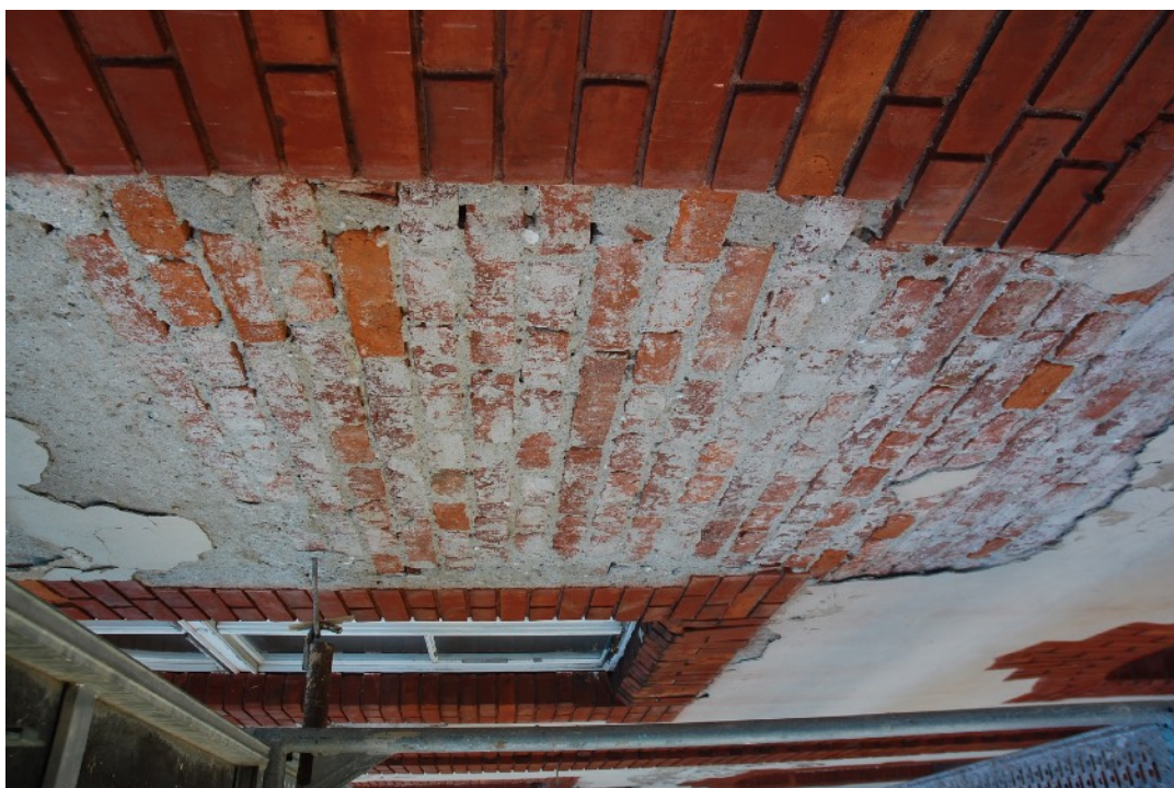
Foto č. 158: Stredový hlavný ríزالit S fasády, centrálna časť, 3.NP, detail poškodenia.
