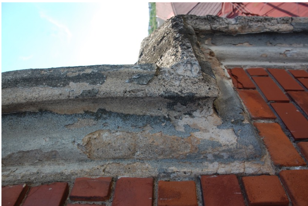
Foto č. 152: Atikový štít, aktuálny stav, detail poškodenia.
