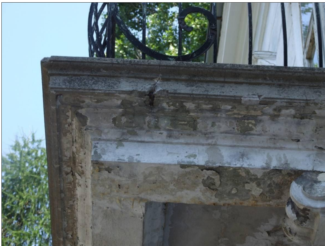
východné krídlo, dvorová fasáda, stav konštrukcie balkóna
