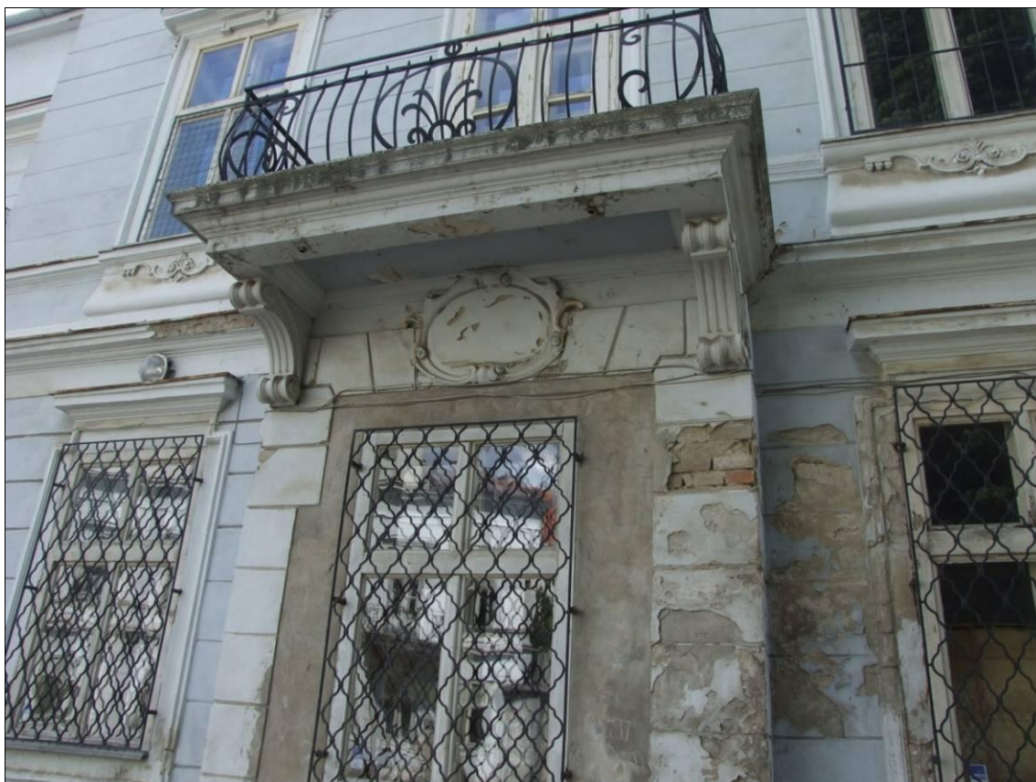
západné krídlo, dvorová fasáda, stav omietok
