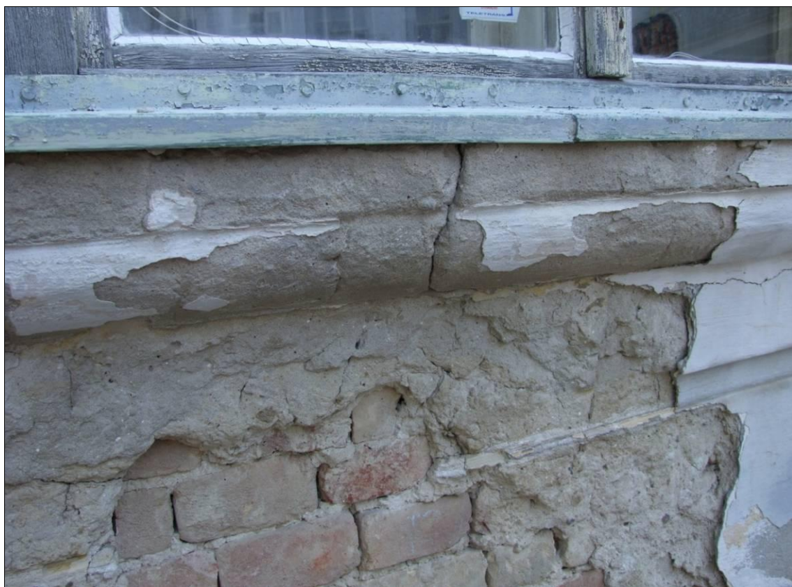
východné krídlo, dvorová fasáda, severná časť, 1.n.p., stav omietok
