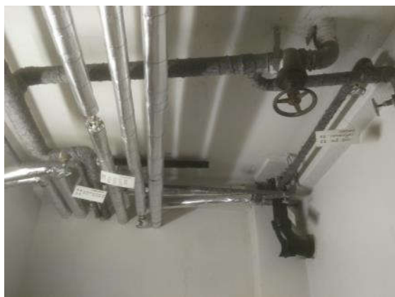
Obr. 16 Potrubné rozvody teplej vody (Zdroj: autori)
