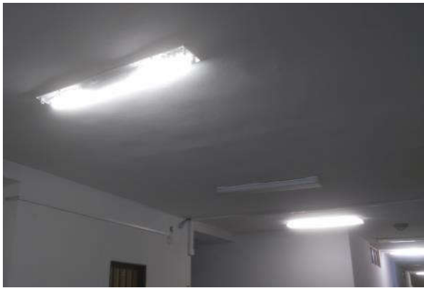
Obr. 18 Svietidlá umelého osvetlenia v priestoroch chodby (Zdroj: autori)
