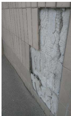
Obr. 5 Závady na fasáde (Zdroj: autori)
