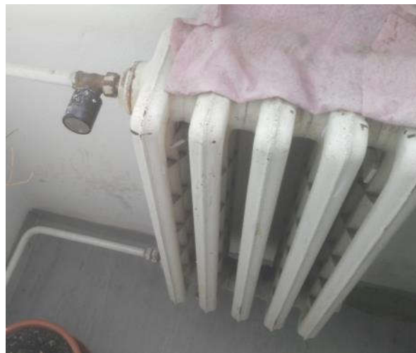
Obr. 13 Vykurovacie teleso s ventilom (Zdroj: autori)
