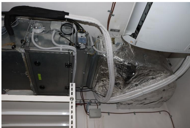
Pohled na přívod vzduchu k jednotce a CU potrubí s chladičem vedoucí od kondenzační jednotky ze střechy.
