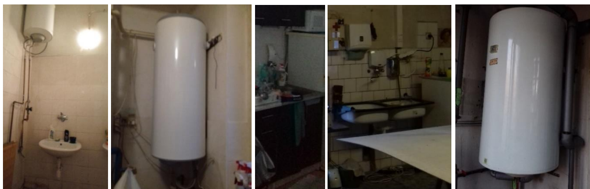
Obr. 19: Príprava TV – (zľava doprava) 1x budova A; 3x budova C; 1x budovy D, E a F
