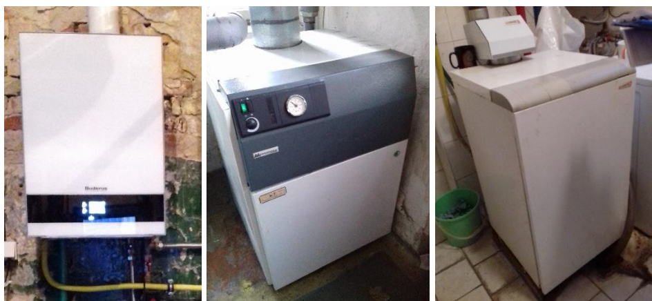
Obr. 16: Zdroje tepla – (zľava doprava) Kotolňa č.1, Kotolňa č.2, Kotolňa č.3
