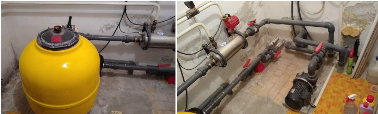
Obr. 9: Úprava vody pre vnútorný bazén v budove
