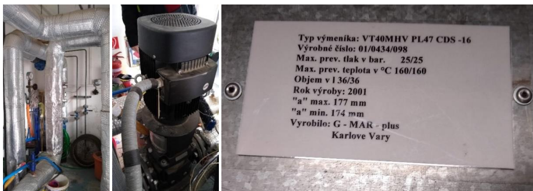
Obr. 18: Odovzdávacia stanica tepla č. 995
