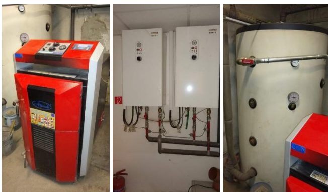
Obr. 7: Kotle a akumulčná nádoba teplej vody na vykurovanie
