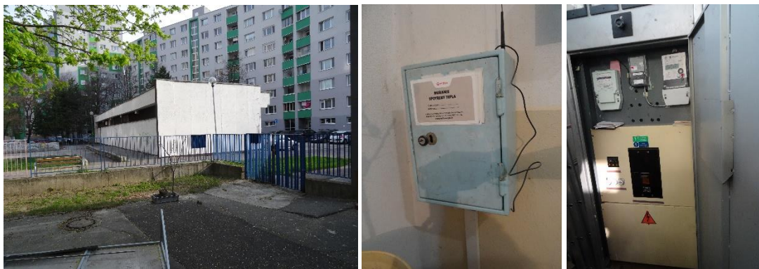
Obr. 8: Odovzdávacia stanica tepla
