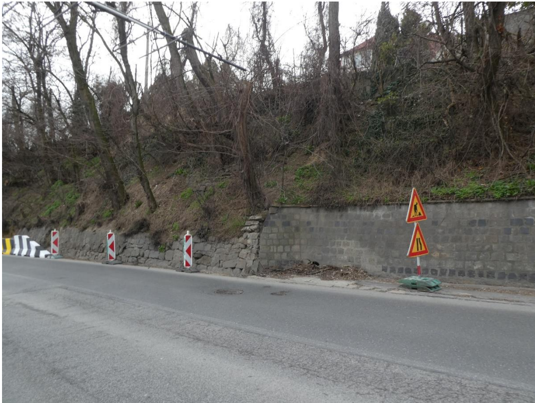
Obr. 12: Zanesený a neprečistený výpust
