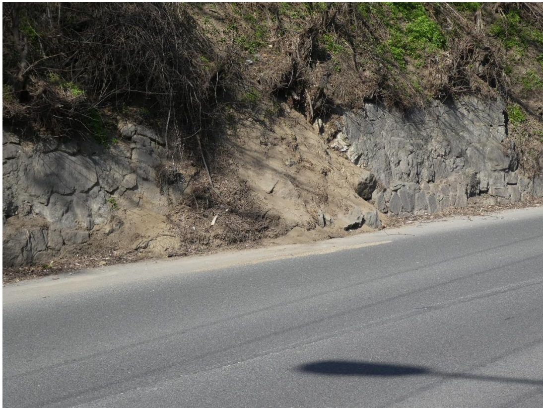
Obr. 8: Vypadnutie kamenného obkladu pôsobením tlaku zosuvných zemín
