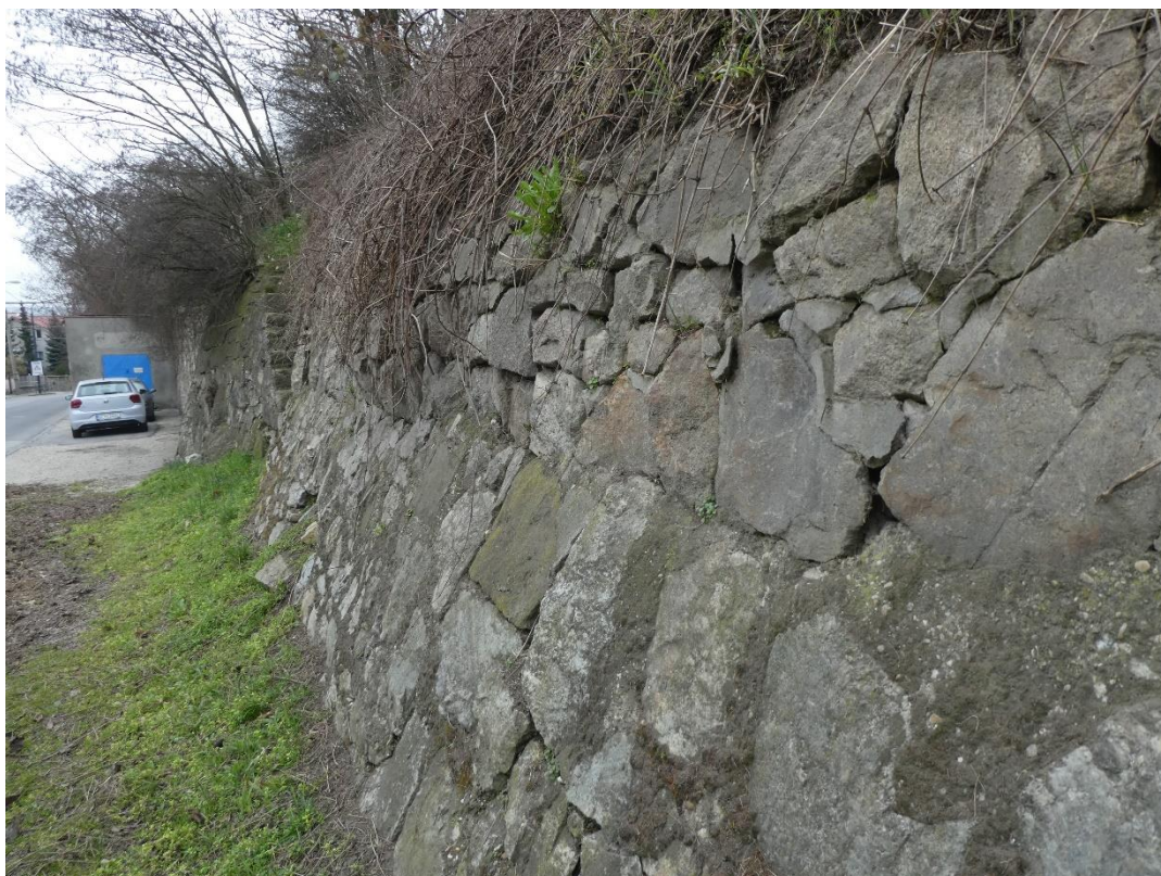
Obr. 23: Deformácia hornej časti múra spôsobená tlakom zeminy.
