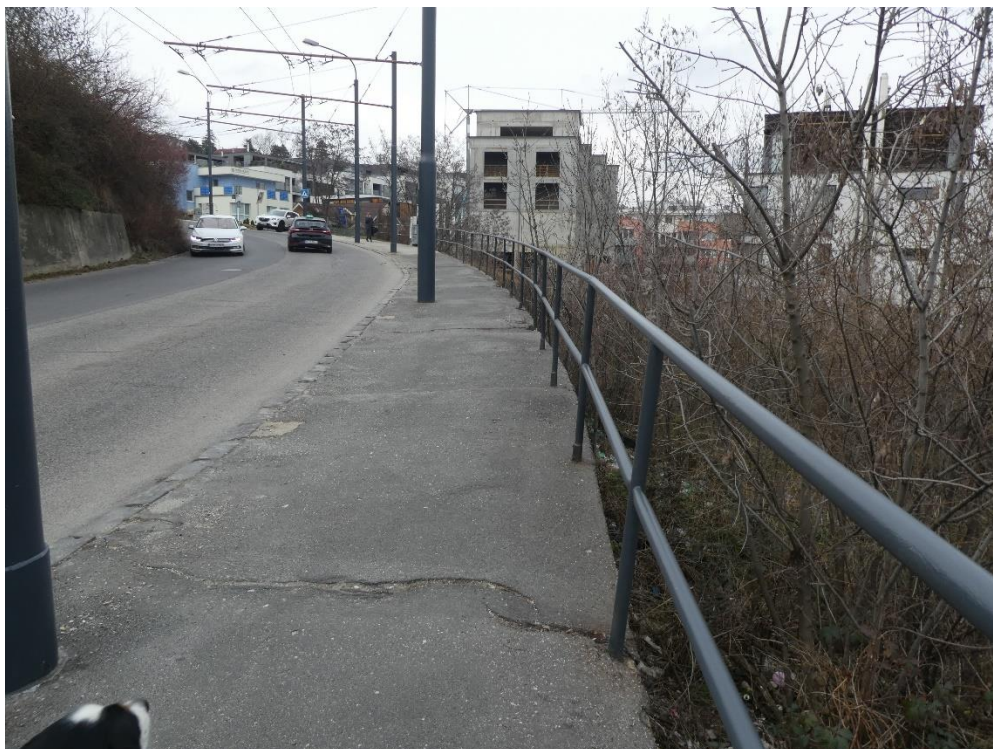
Obr. 27: Pohľad na korunu múra s poškodeným zábradlím.
