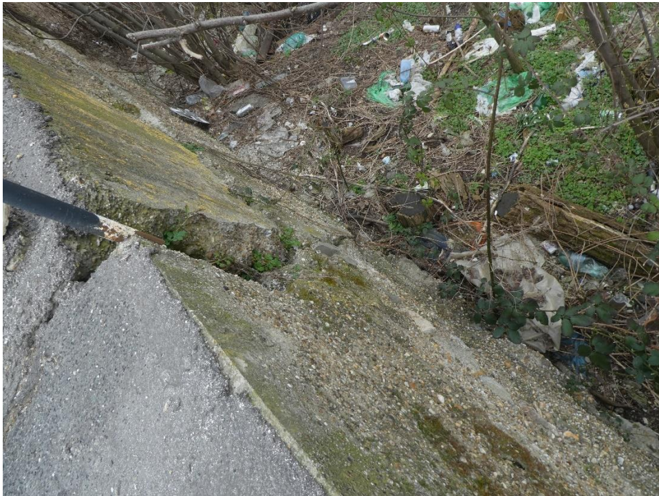
Obr. 31: Vertikálna trhlina po celej výške múru.
