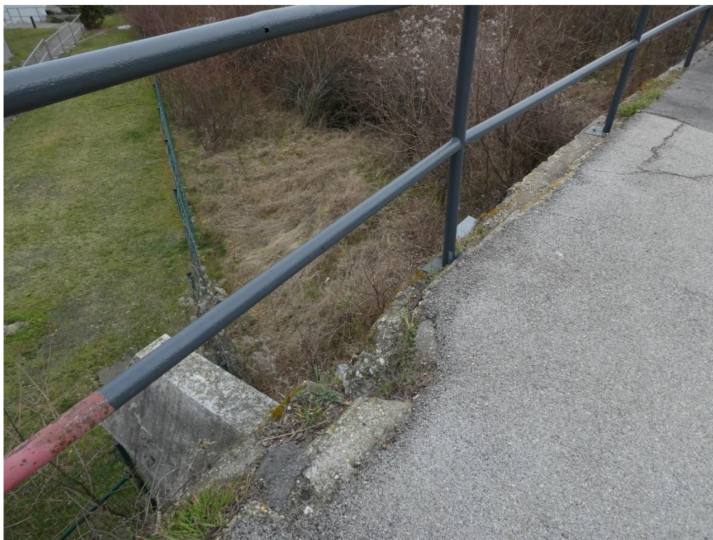
Obr. 29: Degradácia asfaltového chodníka.
