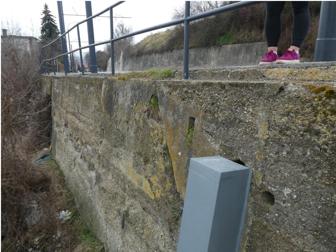
Obr. 26: Vzdušná strana oporného múru s viditeľnou degradáciou povrchu.
