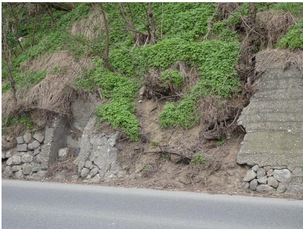
Obr. 15: Nezastabilizovaný zosuv so zaneseným vpustom.
