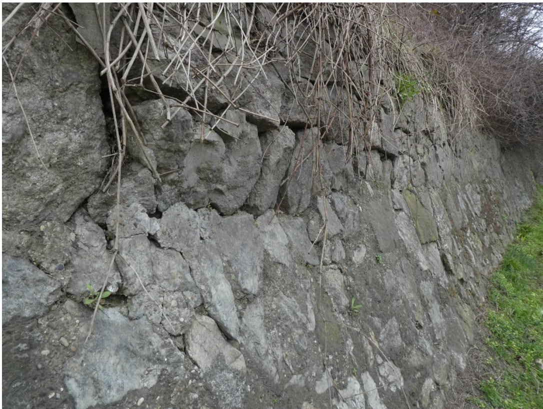
Obr. 22: Deformácia hornej časti múra spôsobená tlakom zeminy.
