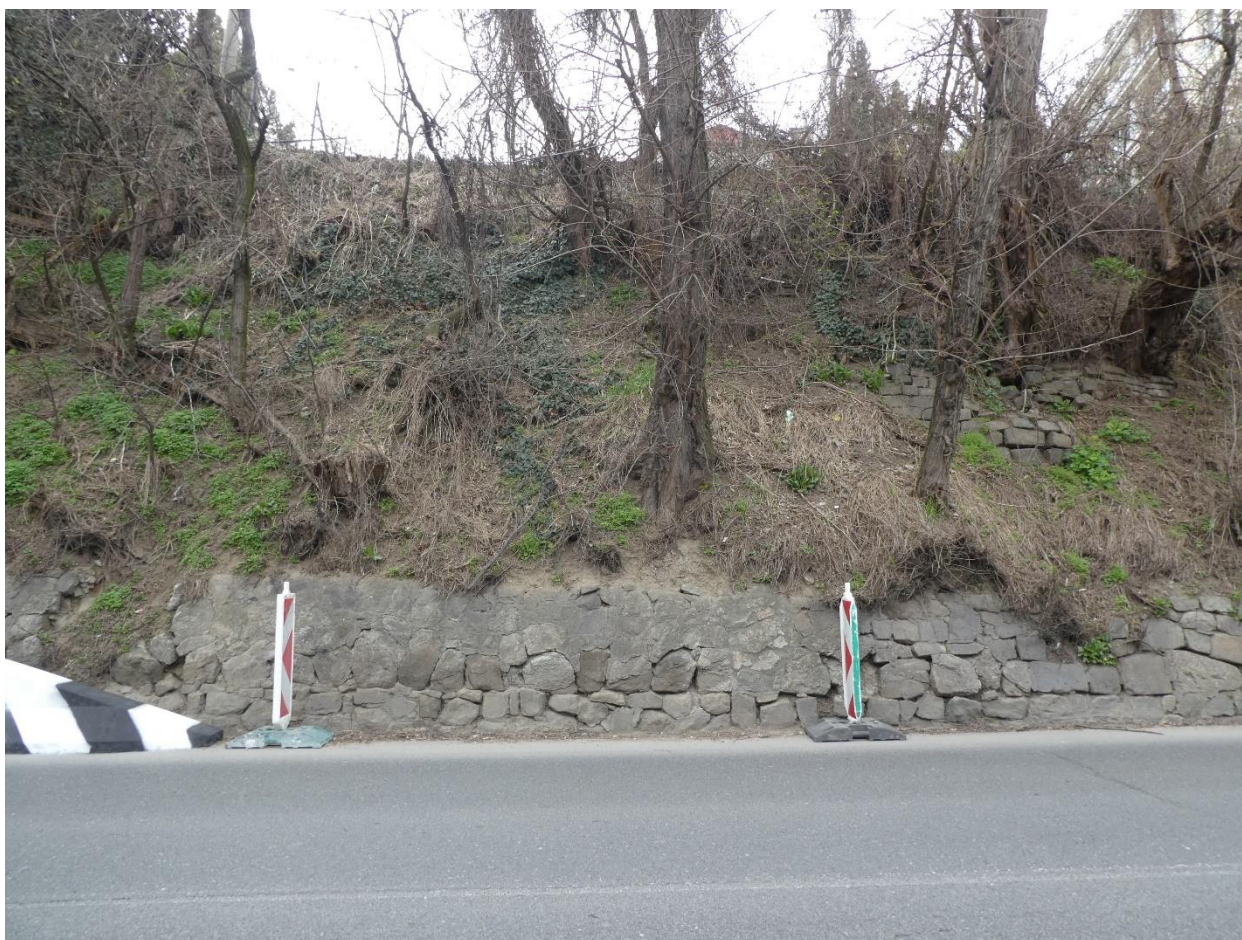
Obr. 6: Odhalené škáry, s viditeľnou sanovanou časťou
