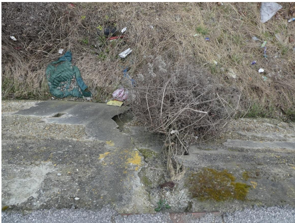
Obr. 32: Vertikálna trhlina po celej výške múra medzi ďalšími blokmi múru.
