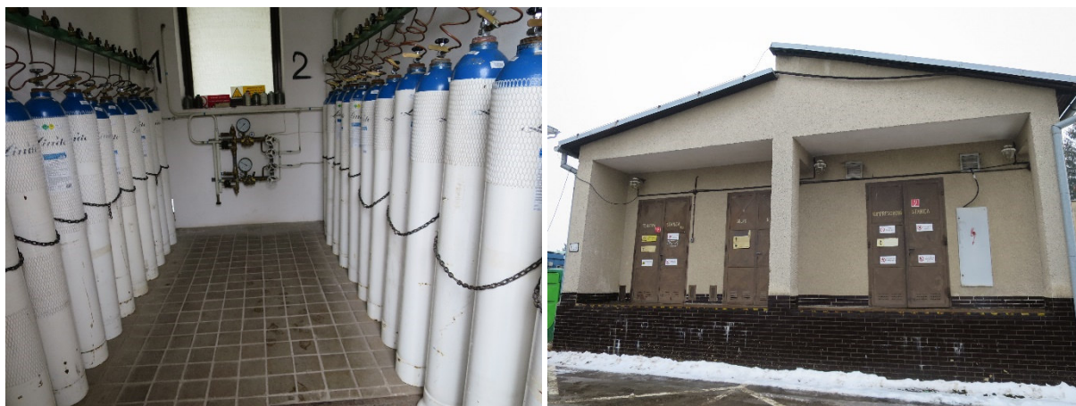
Obrázok 20: Tlaková stanica na N 2 O (vľavo) a budova skladu tlakovej stanice N 2 O a O 2
