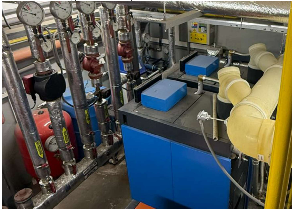
Obrázok 5 Rozdeľovač a plynové kondenzačné kotly
