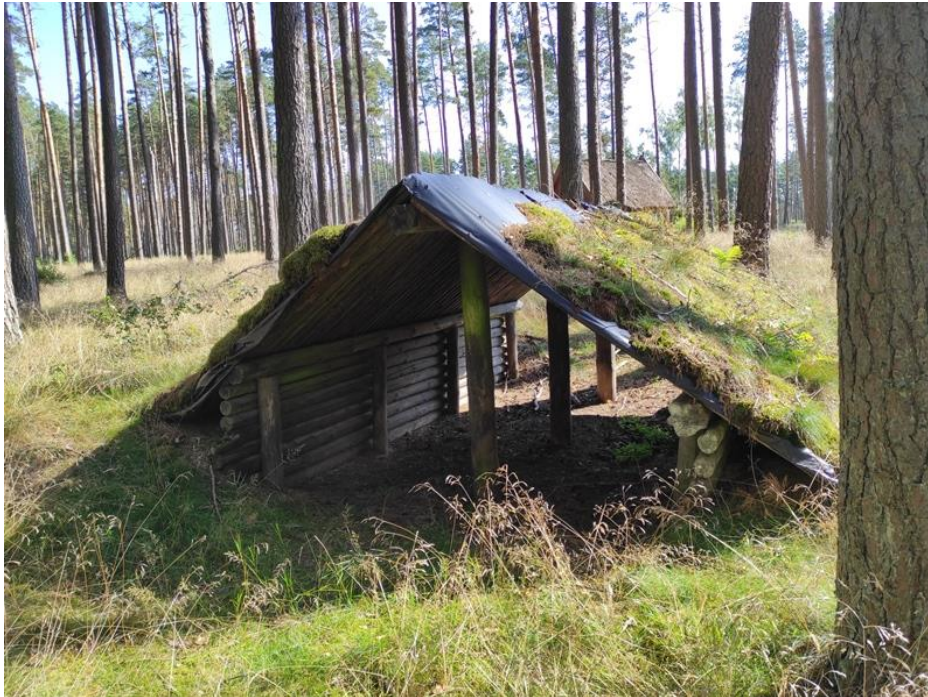
Karmowisko z dachem do naprawy
