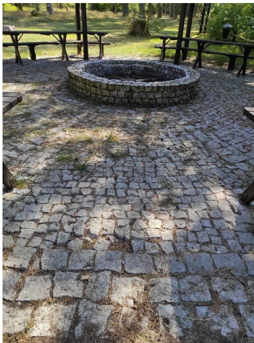
Powierzchnia bruku do oczyszczenia i naprawy
