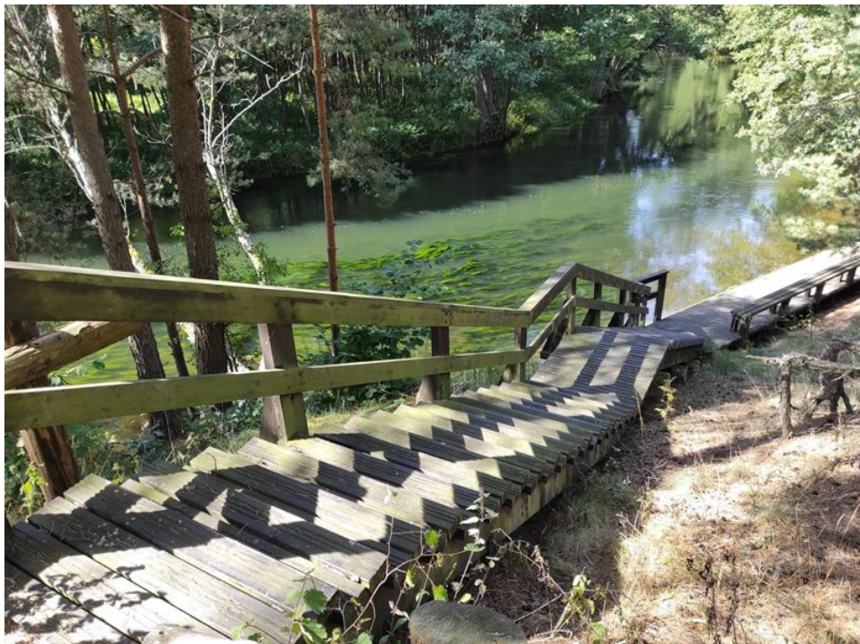
Platforma widokowa na przystanku Harcerskie pole biwakowe do naprawy i konserwacji
