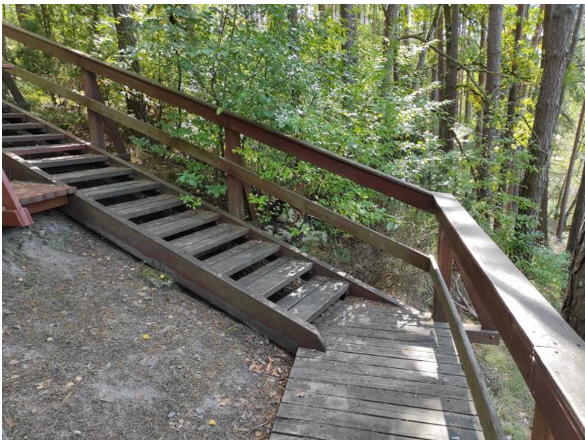
Platforma widokowa na przystanku Dolina Rzeki Brdy do naprawy i konserwacji
