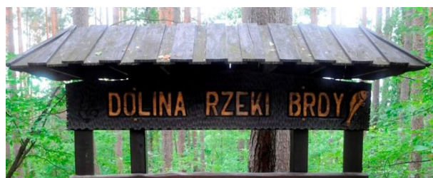
Istniejące zniszczone zadaszenia tablic
