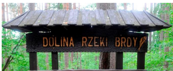
Istniejące zniszczone zadaszenia tablic
