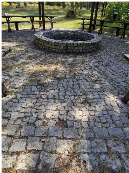
Powierzchnia bruku do oczyszczenia i naprawy
