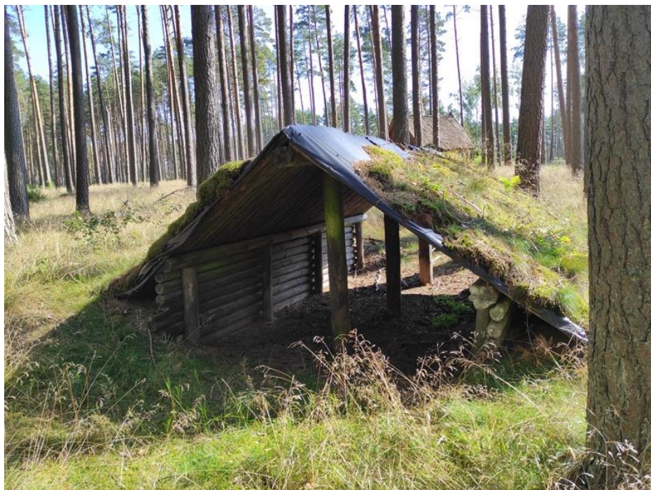
Karmowisko z dachem do naprawy
