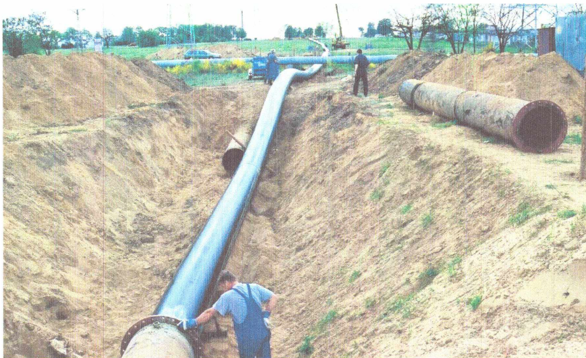
Przykład 1. KGHM Polska Miedź S.A. Wciągnięcie rurociągu DN 710 l=1100m w jednym odcinku.
