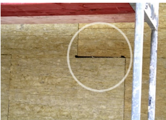
ILUSTRÁČNÁ FOTKA - Medzera medzi doskami izolácie - vzniká tepelný most
