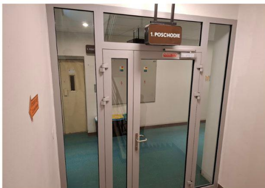
36. Požiarne dvere na chodbe
