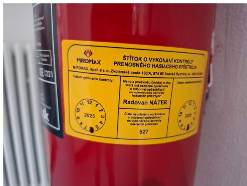
21. HP práškový, chodba, štítok
