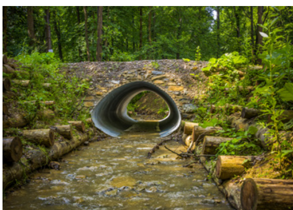
Fot. 140. Nowoczesne konstrukcje odporne na zatkanie rumoszem, Nadleśnictwo Strzyżów (archiwum CKPŚ)
