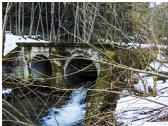
Fot. 88. Zniszczony betonowy przepust okularowy na nieużytkowanym szlaku zrywkowym w Nadleśnictwie Cisna, przerywający ciągłość biologiczną cieku (archiwum CKPŚ).
