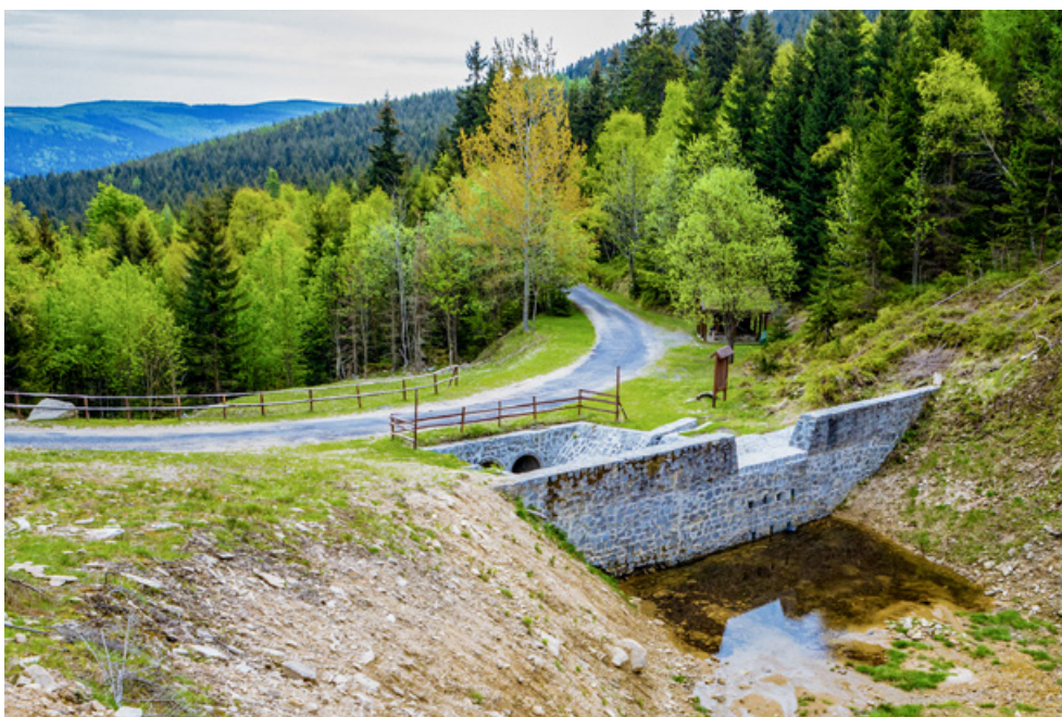
Fot. 139. Opróżniona z zalegającego rumoszu wysoko położona na zboczu góry zapora w Nadleśnictwie Świeradów (archiwum CKPŚ)
