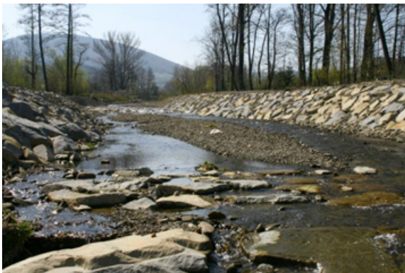
Fot. 74. Narzut kamienny z dużych głazów układany mechanicznie, Targaniczanka (fot. L. Książek, 2009)
