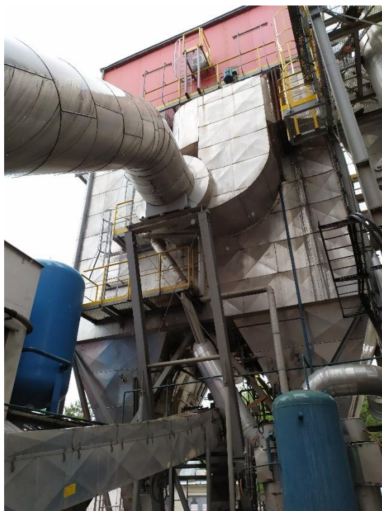
Obr. č. 5: Kompenzátor na spalinovodu u by-passové klapky linky K2
