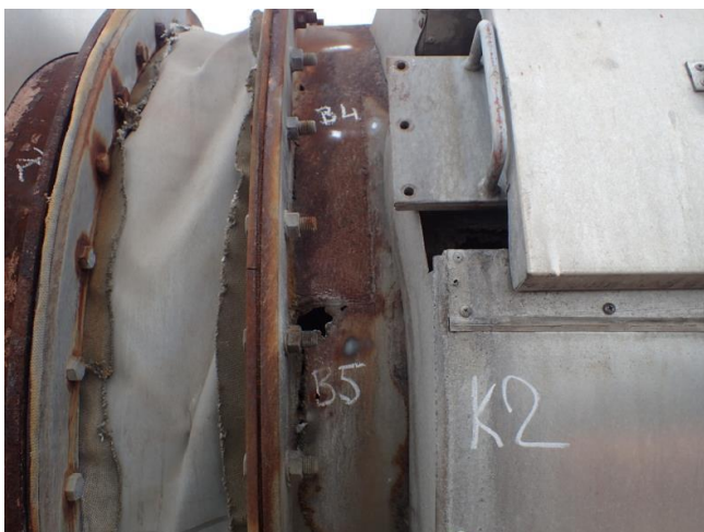
Obr. č. 2: Koroze spalinovodu u kompenzátoru linky K2
