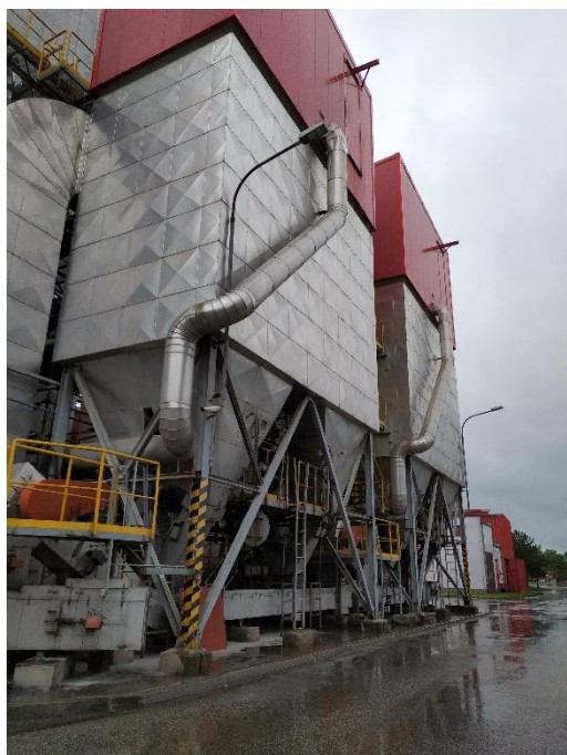
Obr. č. 10: Spalinovody z filtru TF1 a TF2.
