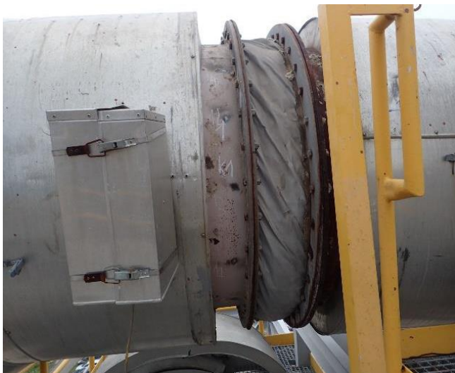
Obr. č. 1: Koroze spalinovodu u kompenzátoru linky K1
