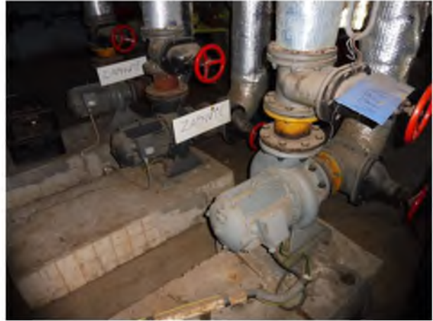
Obrázok 18 – Obehové čerpadlá vykurovacej vody
