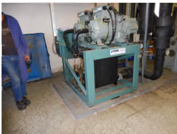
Obrázok 25 – Chladiaca jednotka - chiller
