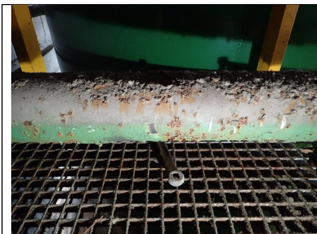
Obr. 3 – stav povrchu potrubí, poškodený náter, jamková korózia
