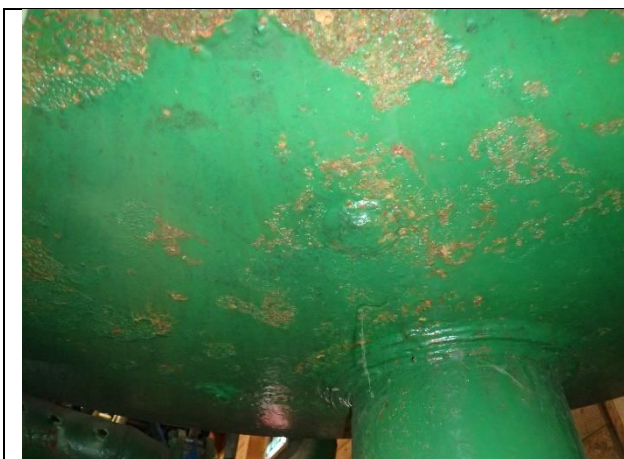
Obr. 5 – stav spodných klenutých dien filtrov
