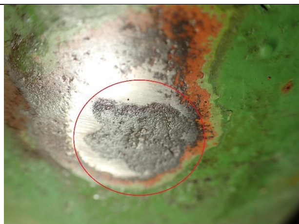
Obr. 6 – detail korózneho poškodenia
