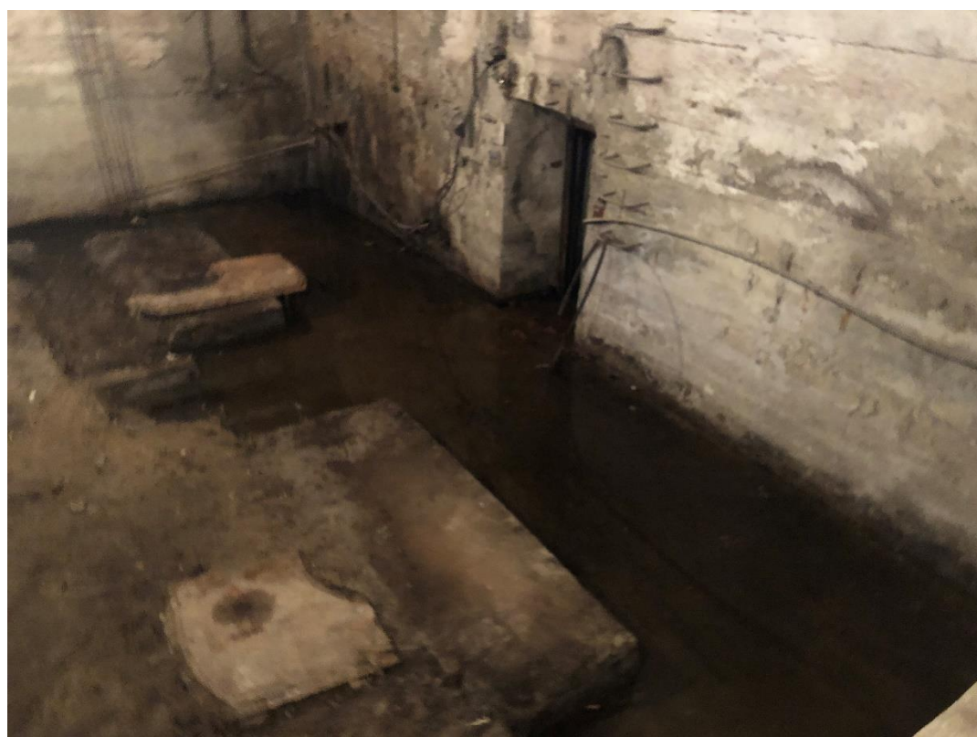
Zatopená nižšia časť v bytovom dome – priestor bývalej kotelne, do ktorej steká voda z vyššie položenej zauhľovne cez dverný otvor vid' foto strana 2.
