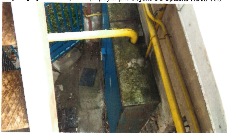
fotografia č.10 Plynová prípojka pre objekt OÚ Spišská Nová Ves
