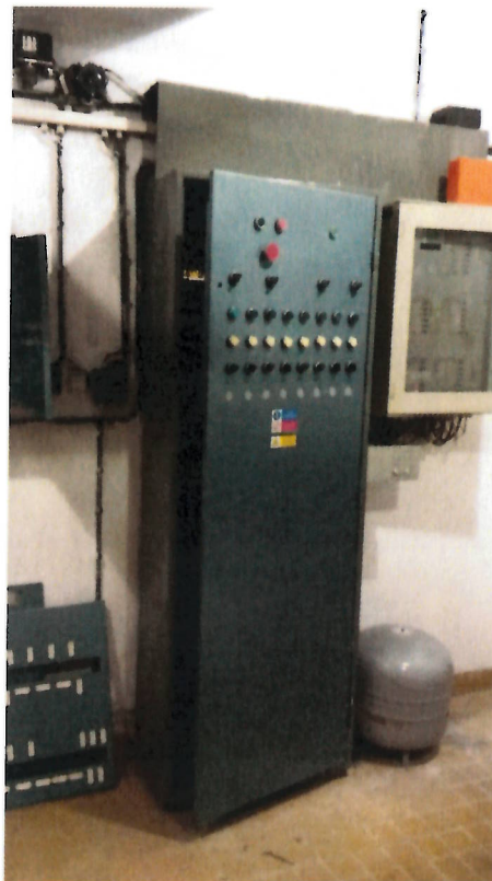
fotografia č.4 Rozvádzač v strojovni ÚK v suteréne
