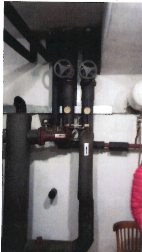
fotografia č.7 Ventily a rozdeľovač v strojovni ÚK v suteréne
