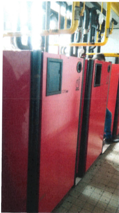
fotografia č.3 Pohľad na kotle ORTAS 125 NT v kotolni na 1.poschodí
