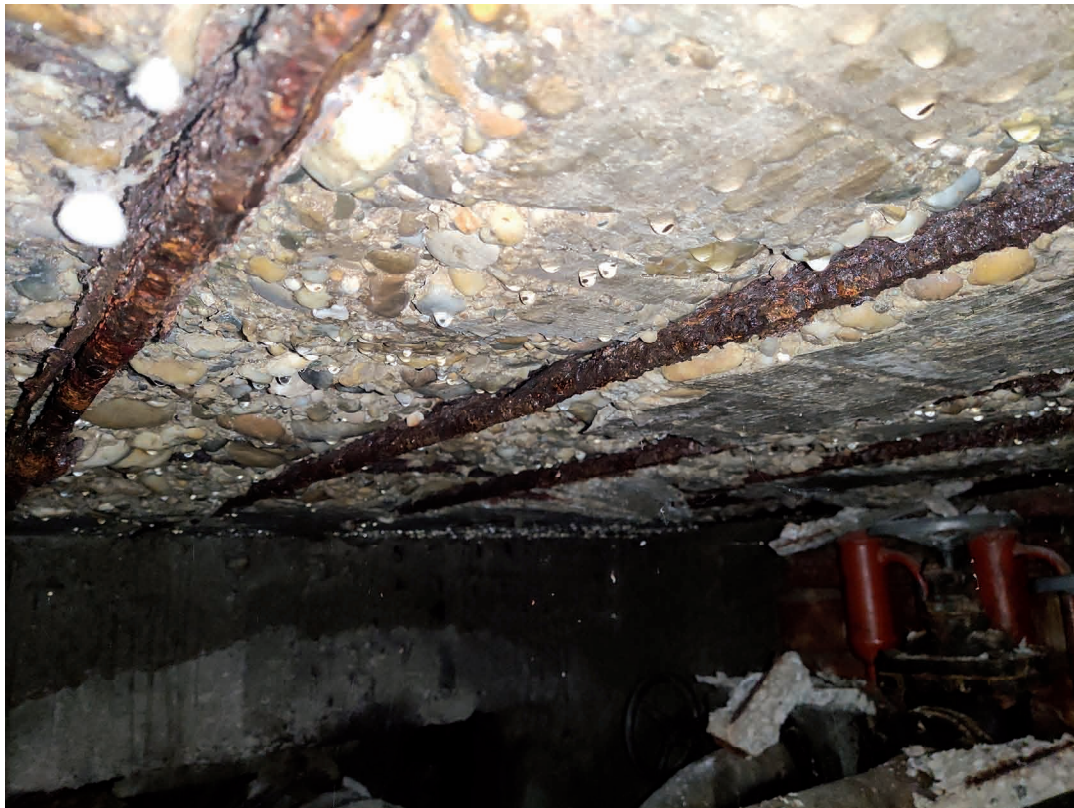
Obr. č.1 – stav stropnej dosky v šachte pred vstupom
