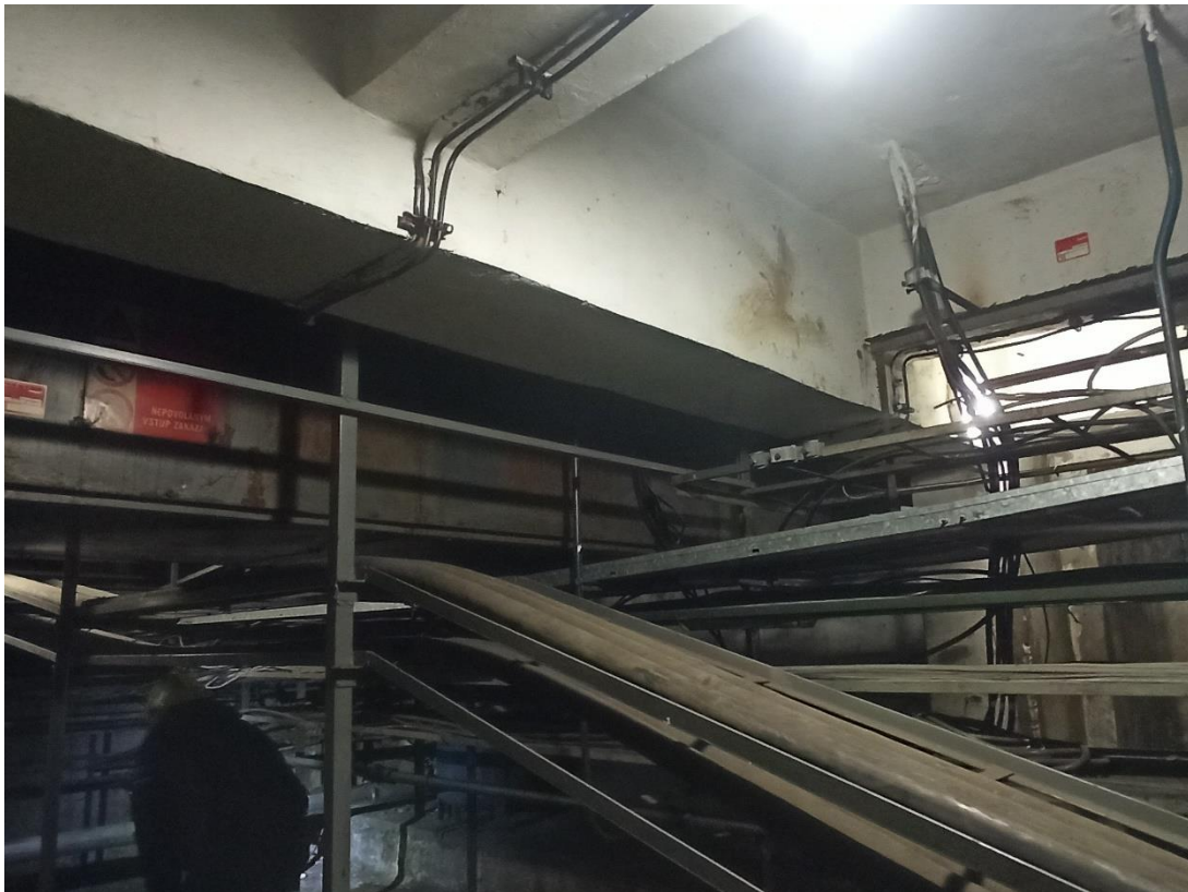
Obr.6 Preklad v káblovom priestore pod rozvodnou R22.1
