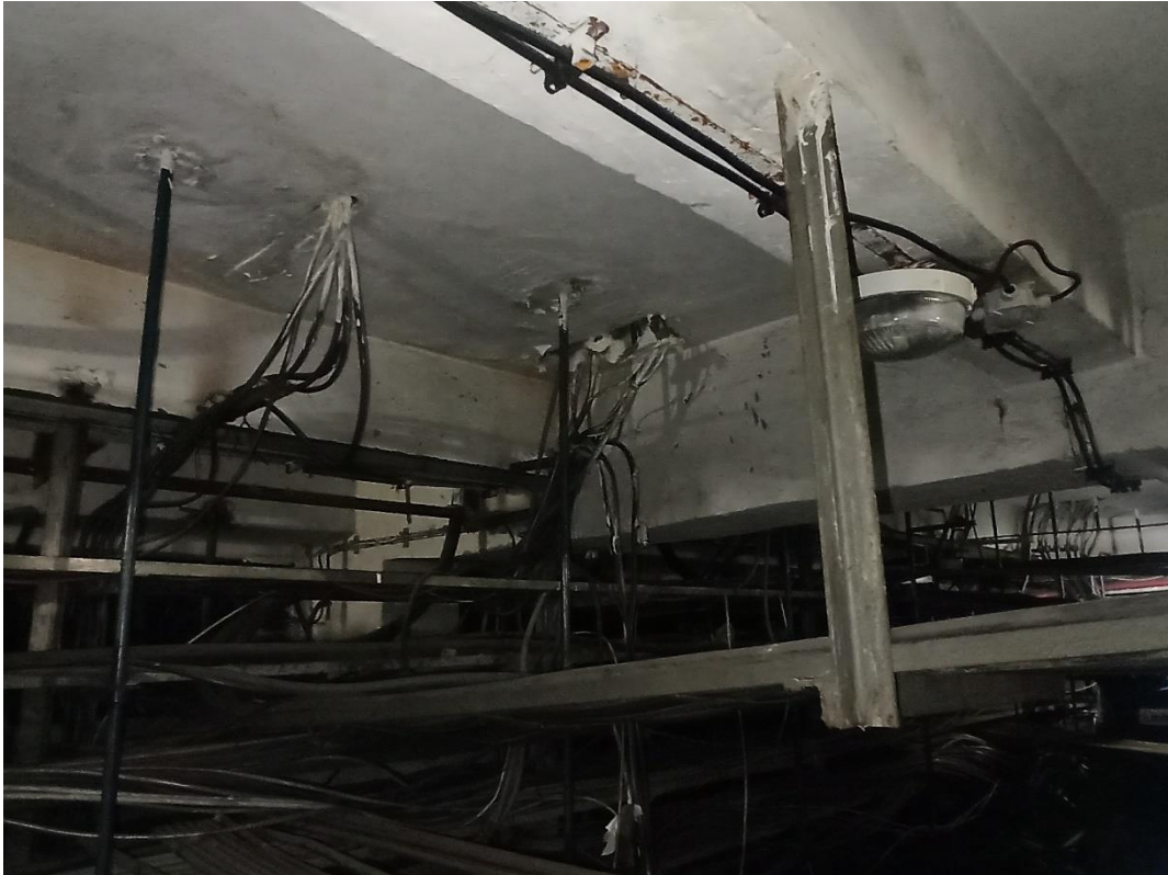
Obr.7 Preklad v kábllovom priestore pod rozvodnou R22.1
