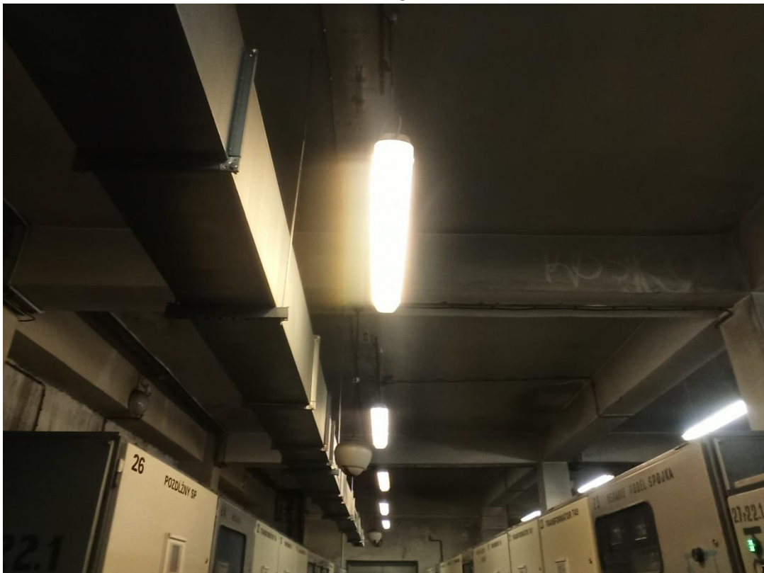
Obr.4 Priestor rozvodne R22.1
