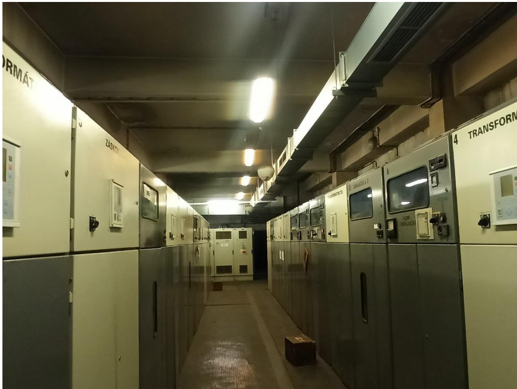
Obr.5 Priestor rozvodne R22.1
