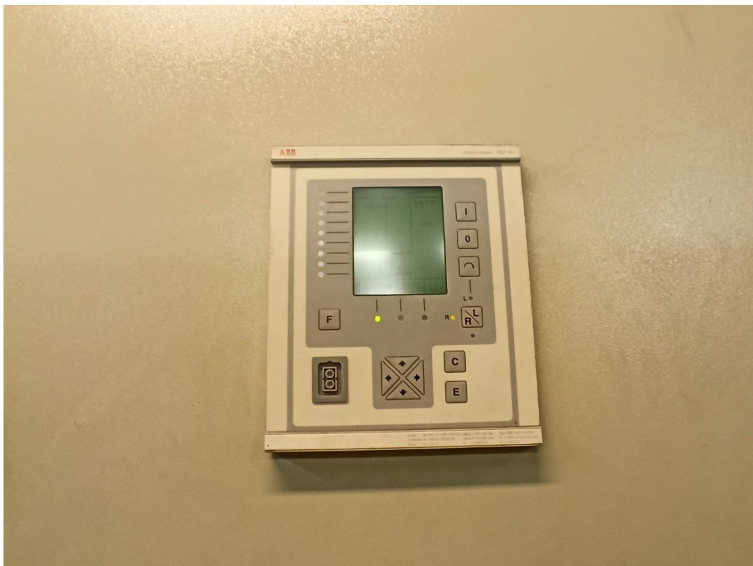
Obr.2 Detail technologického zariadenia
