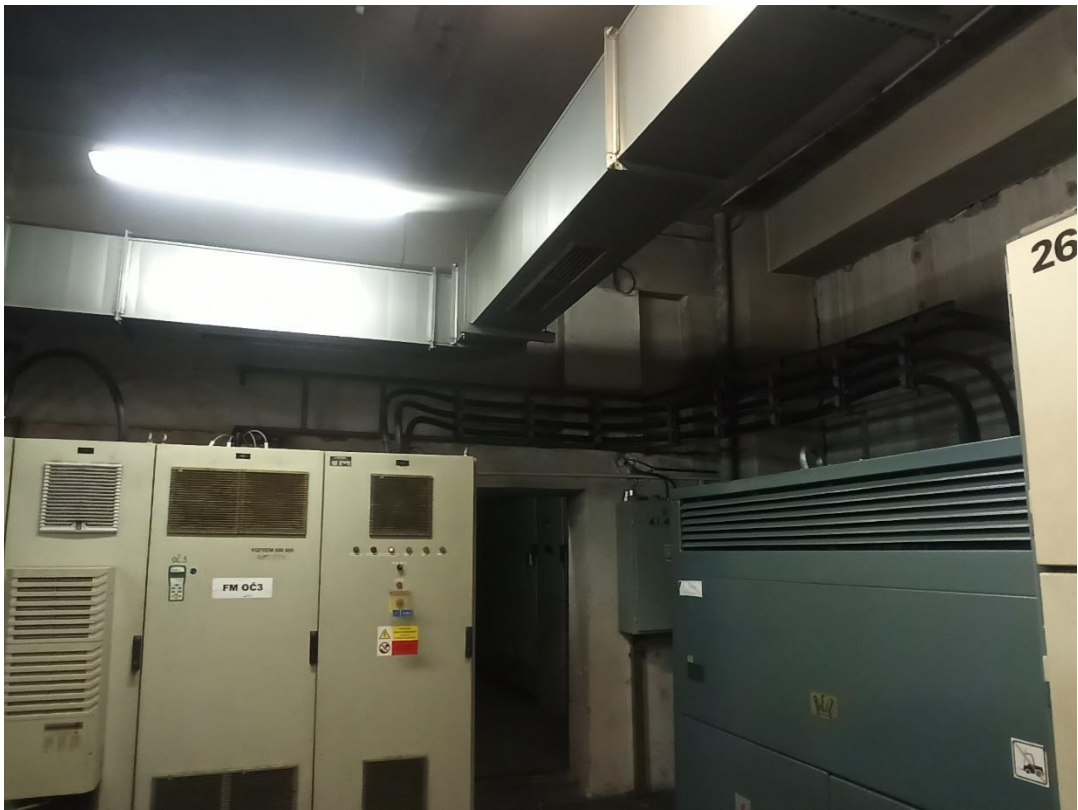
Obr. 1 Klimatizácia rozvodne R22.1
