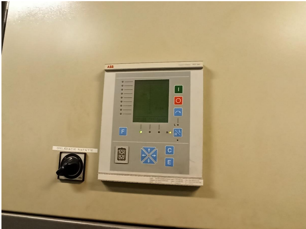
Obr.3 Detail technologického zariadenia
