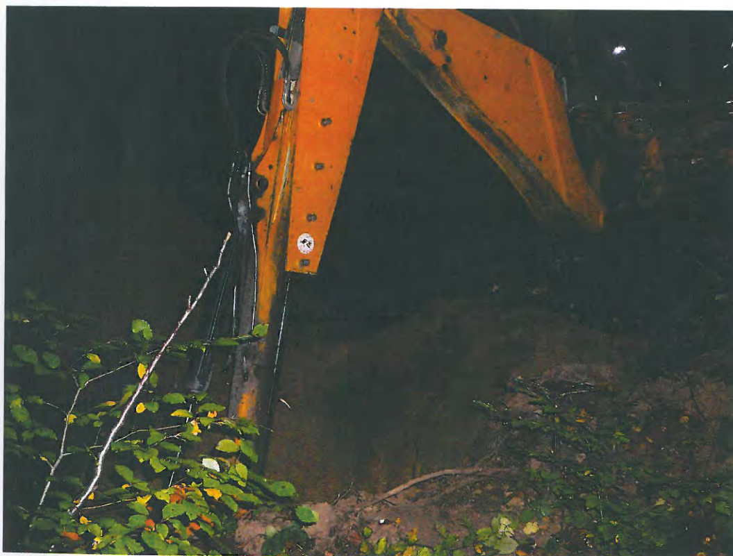
Obr.č.2 Kopená ryha KS na lokalite Kamený potok – lokalita Krigrund s hĺbkou 4,0 m
