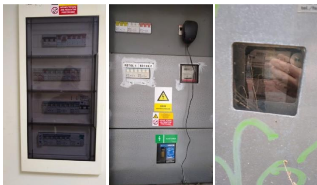
Obr. 4: Meranie elektrickej energie
