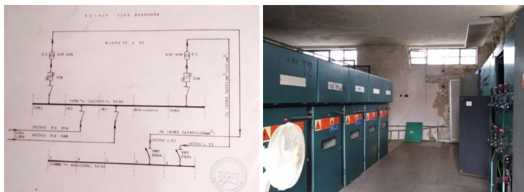
Obr. 4: Trafostanica a VN/NN rozvodňa 22kV v areáli
