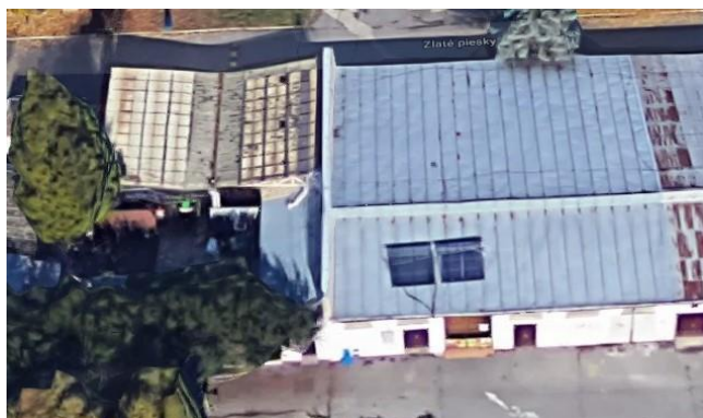
Obr. 9: Pohľad na strechu prevádzkovej budovy A, kde sú inštalované solárne kolektory
