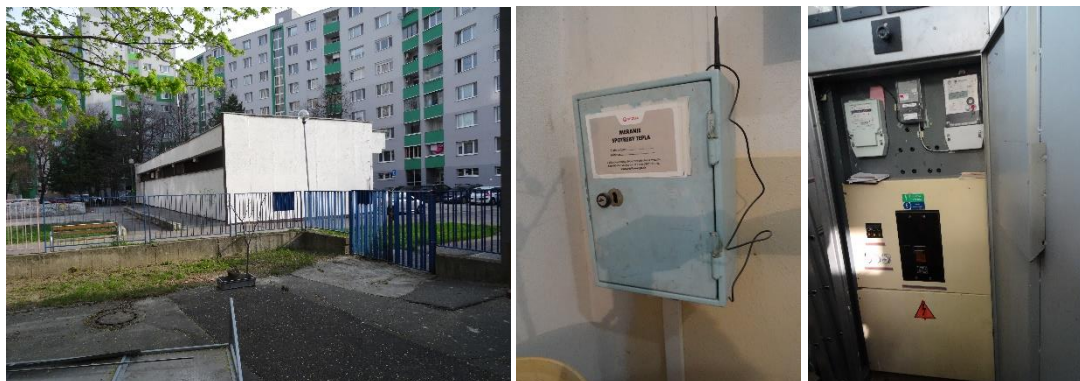
Obr. 8: Odovzdávacia stanica tepla
