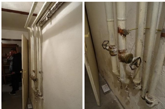
Obr. 9: Rozvody tepla v suteréne CVČ Štefánikova 35
