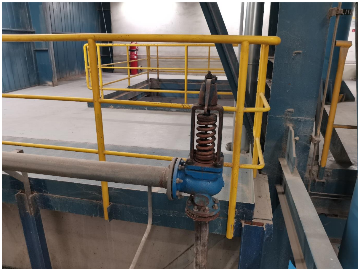
22. Poistný ventil pri napájacej nádrži P57 217 540 DN65 PN40 – umiestnenie: 3. poschodie
