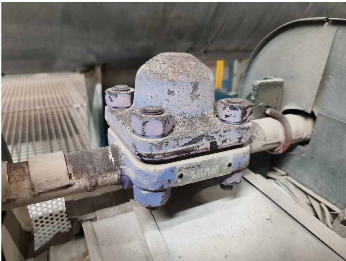
10. Odvádzače kondenzátu na 40 bar rozdeľovači CNU 117 540 DN25 – umiestnenie: 8. poschodie
