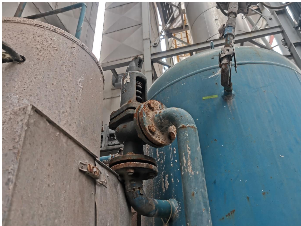
54. Poistné ventily na vzdušníkoch pri textilných filtroch DN50 PN16 – umiestnenie: vonkajší areál závodu
