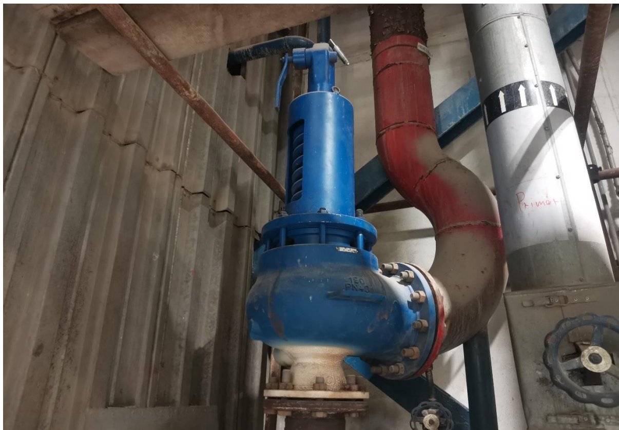
36. Poistný ventil na 19bar rozdeľovači pary č.1 P51 217 540.11 DN150 PN40 – umiestnenie: 1. poschodie
