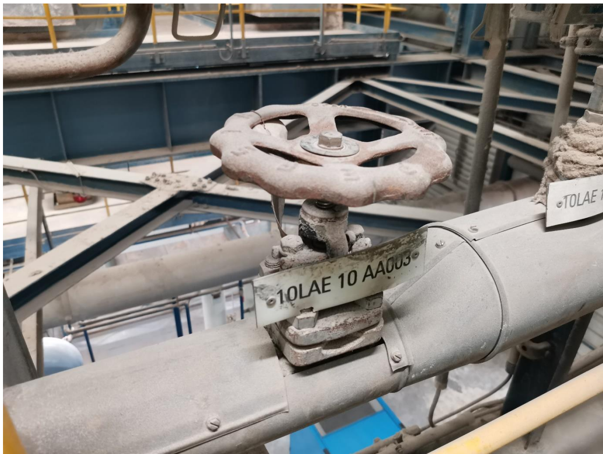
16. Uzatváracie armatúry na zástreku do kotlov 200AE 21.2 DN25 PN100 – umiestnenie: 4. poschodie
