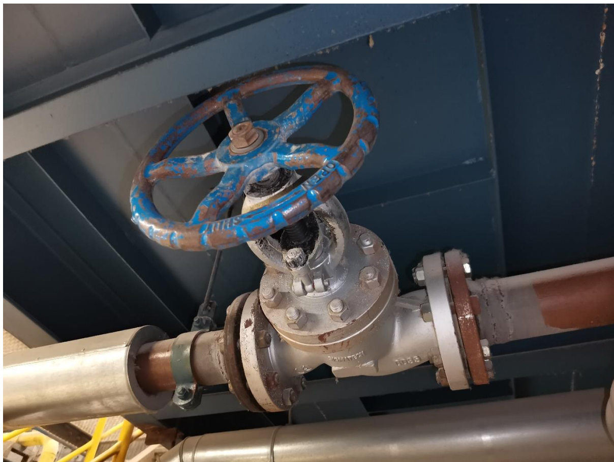
25. Odvodňovacia armatúra napájacej nádrže DN100 PN100 – umiestnenie: 2. poschodie
