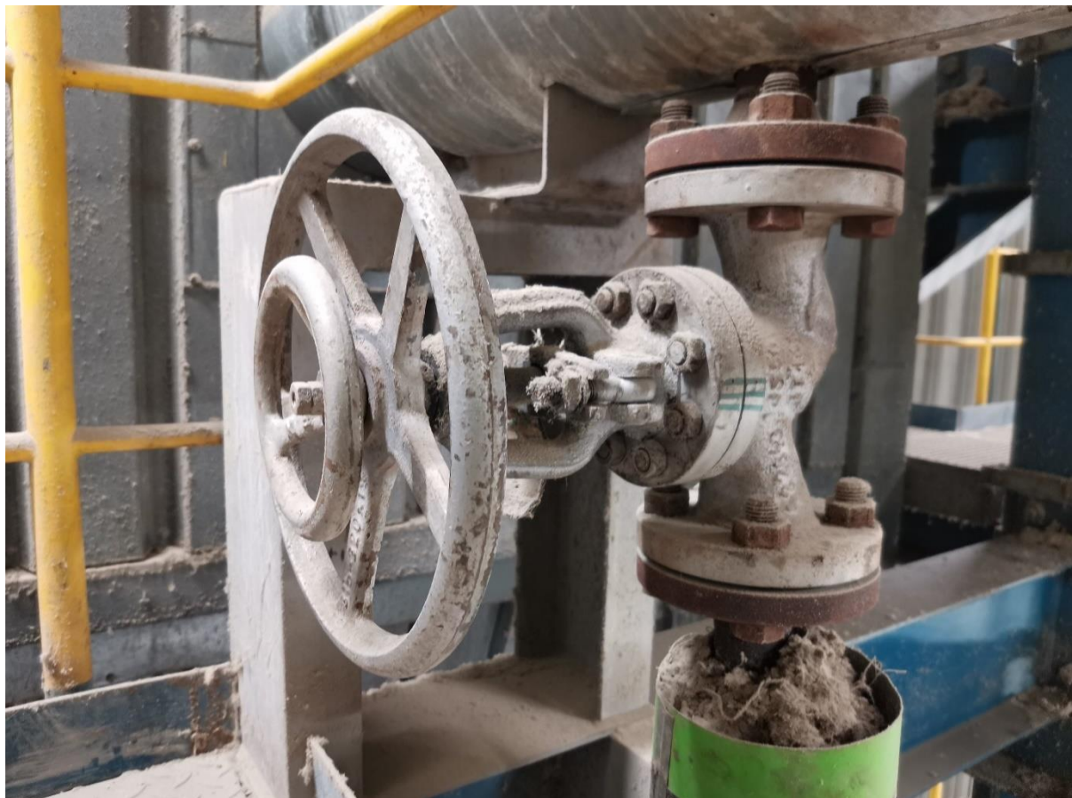
20. Odvodňovacie armatúry hlavné – para-voda DN50 PN100 – umiestnenie: 4. poschodie
