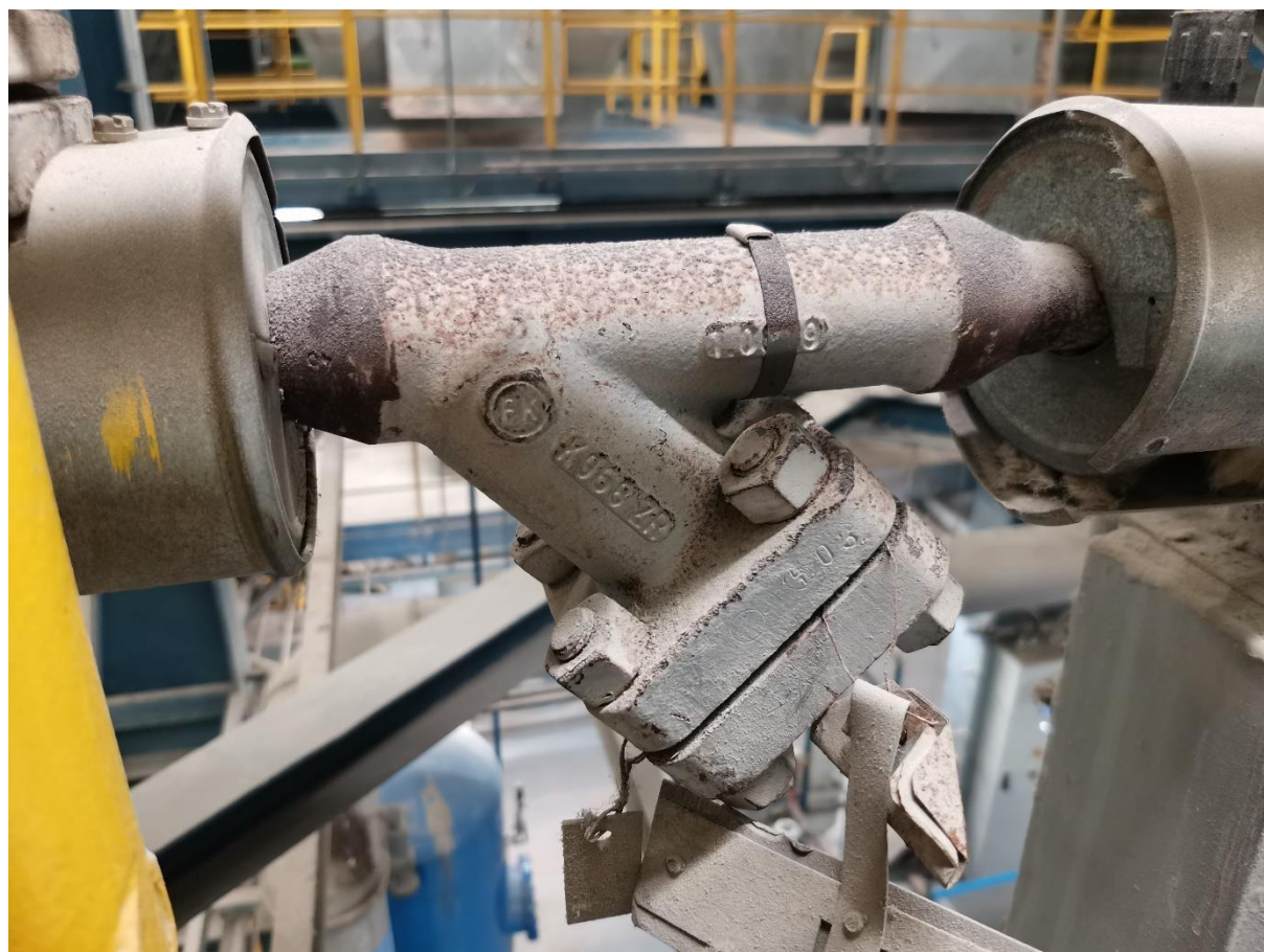
17. Filtre navarovacie na zástreku do kotlov SF25-5A/S DN25 (vyčistenie sitka, pretesnenie zaslepovacej príruby) – umiestnenie: 4. poschodie
