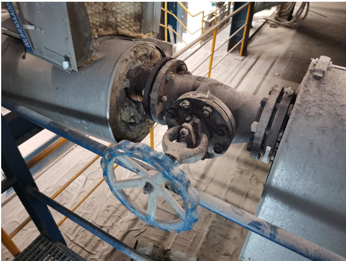
24. Uzatváracie armatúry napájacej nádrže D71 117 616 DN150 PN16 – umiestnenie: 3. poschodie
