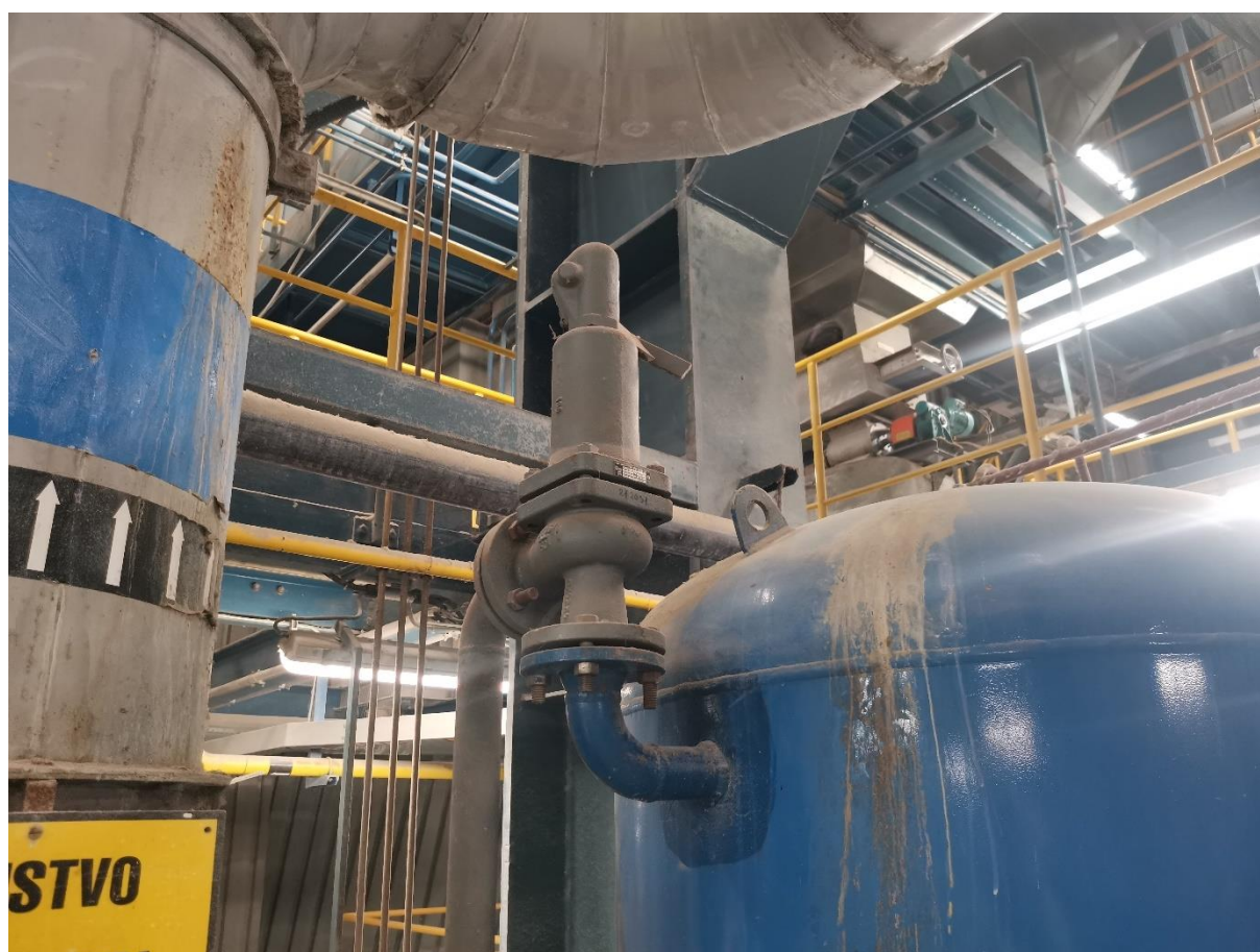
23. Poistný ventil na vzdušníku P16 217 616 DN50 PN16 – umiestnenie: 3. poschodie
