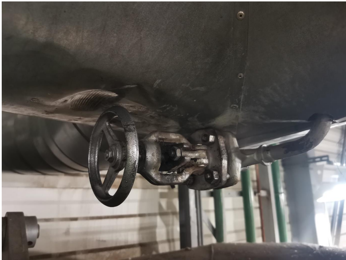
53. Uzatváracie armatúry na bypasse vstupu pary do turbíny DN15 PN100 – umiestnenie: strojovňa TG
