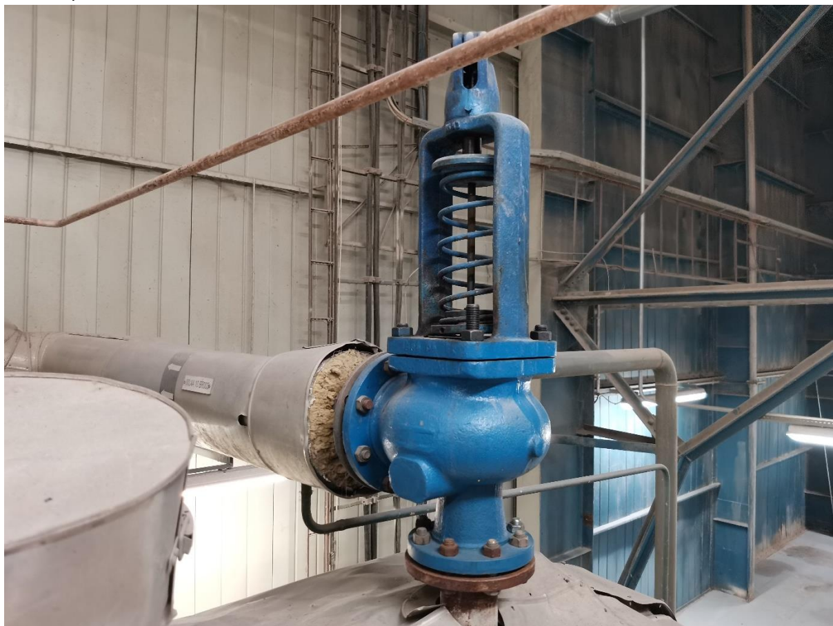
21. Poistný ventil na napájacej nádrži P57 217 540 DN80 PN40 – umiestnenie: 3. poschodie
