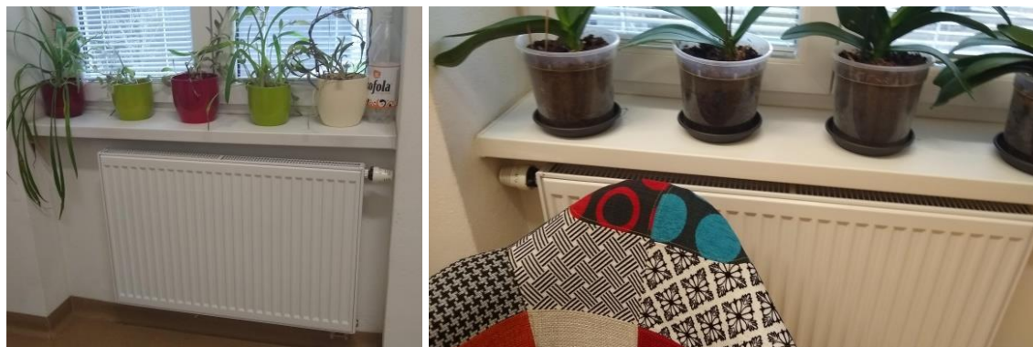
Obr. 10: Vykurovacie telesá s termostatickými hlaviciami v budove
