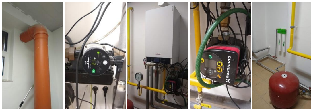
Obr. 8: Plynový kondenzačný kotol Viessmann, zásobník teplej vody Vitocell a technológia kotolne
