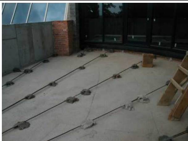
Fot.5: Taras, zdjęcie archiwalne – widoczny murek żelbetowy i jego fragment z cegły ceramicznej pełnej
