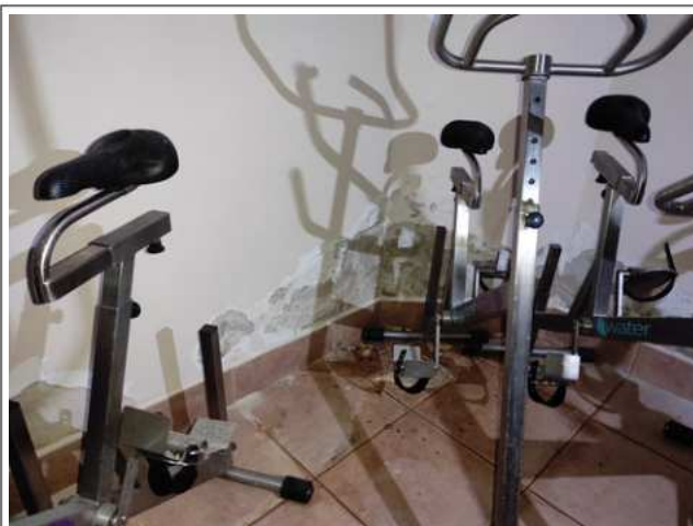
Fot.1: Zawilgocenie ścian piwnicy
