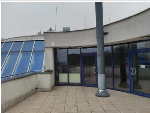
Fot.6: Taras, stan obecny - widoczne ślady zawilgocenia i odspojenia tynku na murku płyty tarasu od strony wewnętrznej
