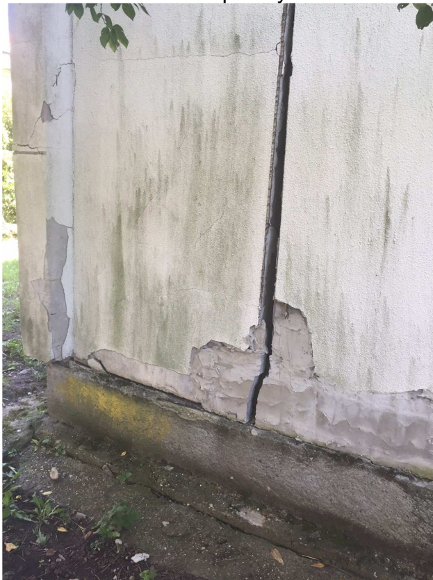
Poškodené obvodové panely
