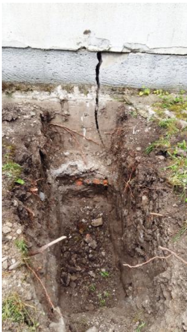
Obr.1 - Trhlina v základovom páse
