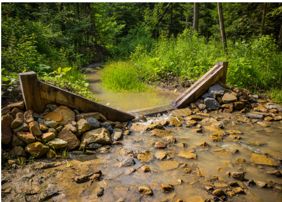
Fot. 37. Prawidłowo ubezpieczone stanowisko górne i dolne progu z pojedynczą ścianką szczelną, Nadleśnictwo Strzyżów (archiwum CKPŚ)
