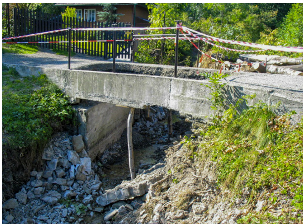
Fot. 142. Straty powodziowe w 2005 roku – uszkodzony mostek o zbyt małym świetle, Targanica (fot. L. Książek)
