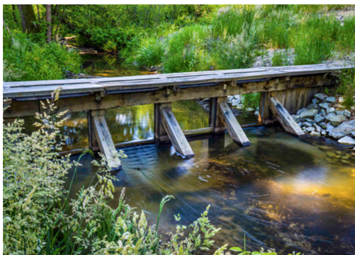
Fot. 35. Jaz zastawkowy z kilkoma przęsłami i szandorami w Nadleśnictwie Sieraków (fot. J. Smarczewski, 2023)
