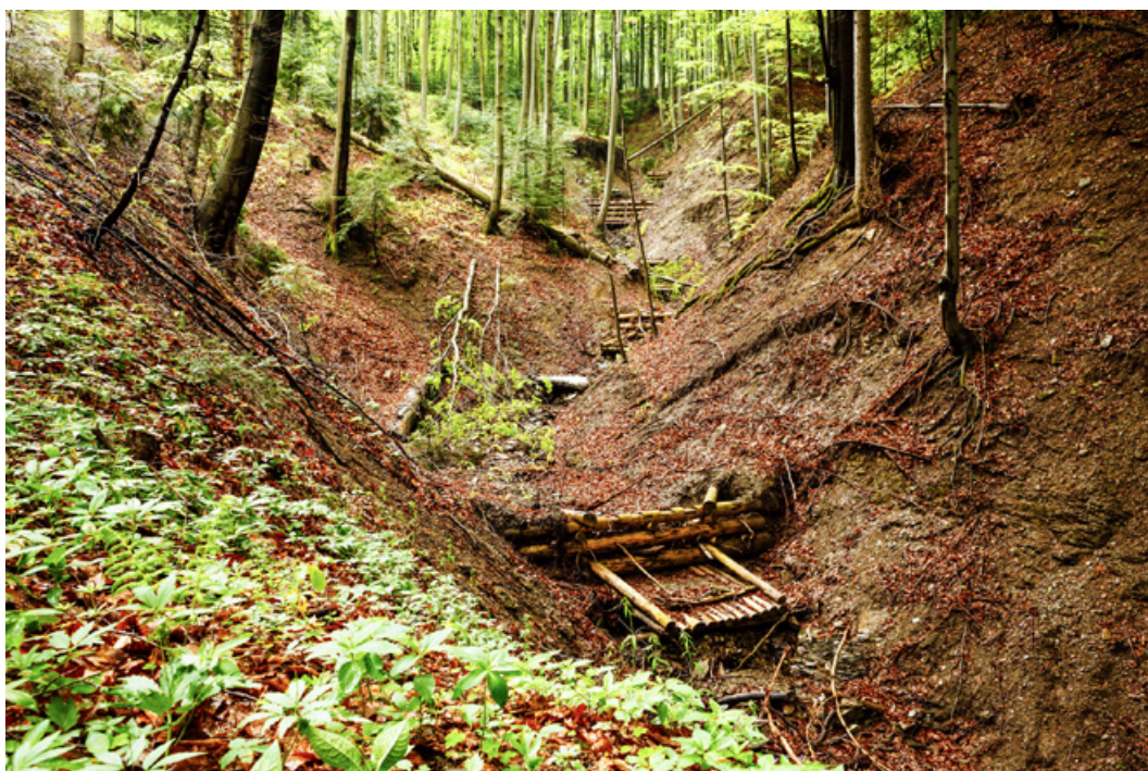
Fot. 149. Niewielkie zapory przeciwrumowiskowe rozłożone w wyerodowanym wąwozie na cieku okresowym, Nadleśnictwo Limanowa (archiwum CKPŚ)
