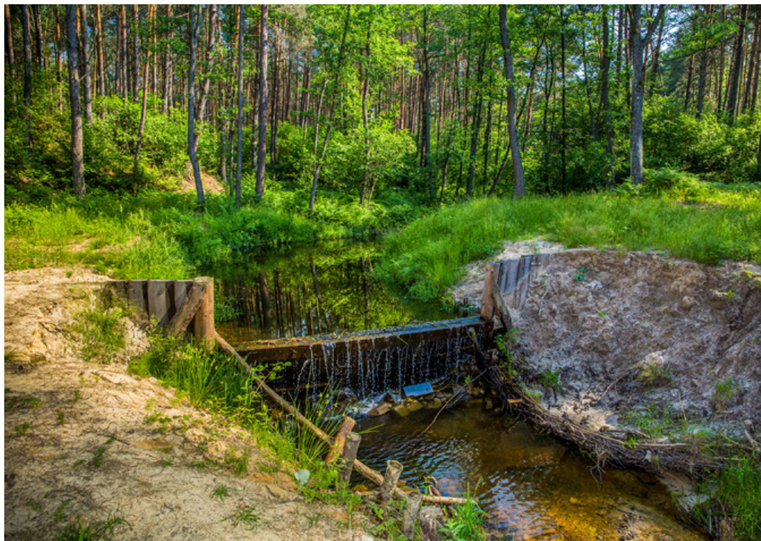
Fot. 36. Widoczna erozja dna i skarp prowadząca do osłabienia konstrukcji oraz wygięcia progu pod naporem wody, Nadleśnictwo Łągów (archiwum CKPŚ)
