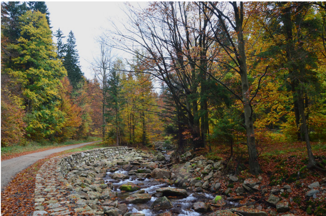
Fot. 3. Zabezpieczenie brzegu niewielkim murem oporowym w celu ochrony infrastruktury drogowej, Nadleśnictwo Międzyzlesie (archiwum CKPŚ)
