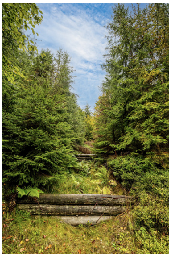
Fot. 103. Typowa zabudowa szlaków zrywkowych z wykorzystaniem belek drewnianych w Nadleśnictwie Wiśła (fot. J. Smarczewski, 2021)
