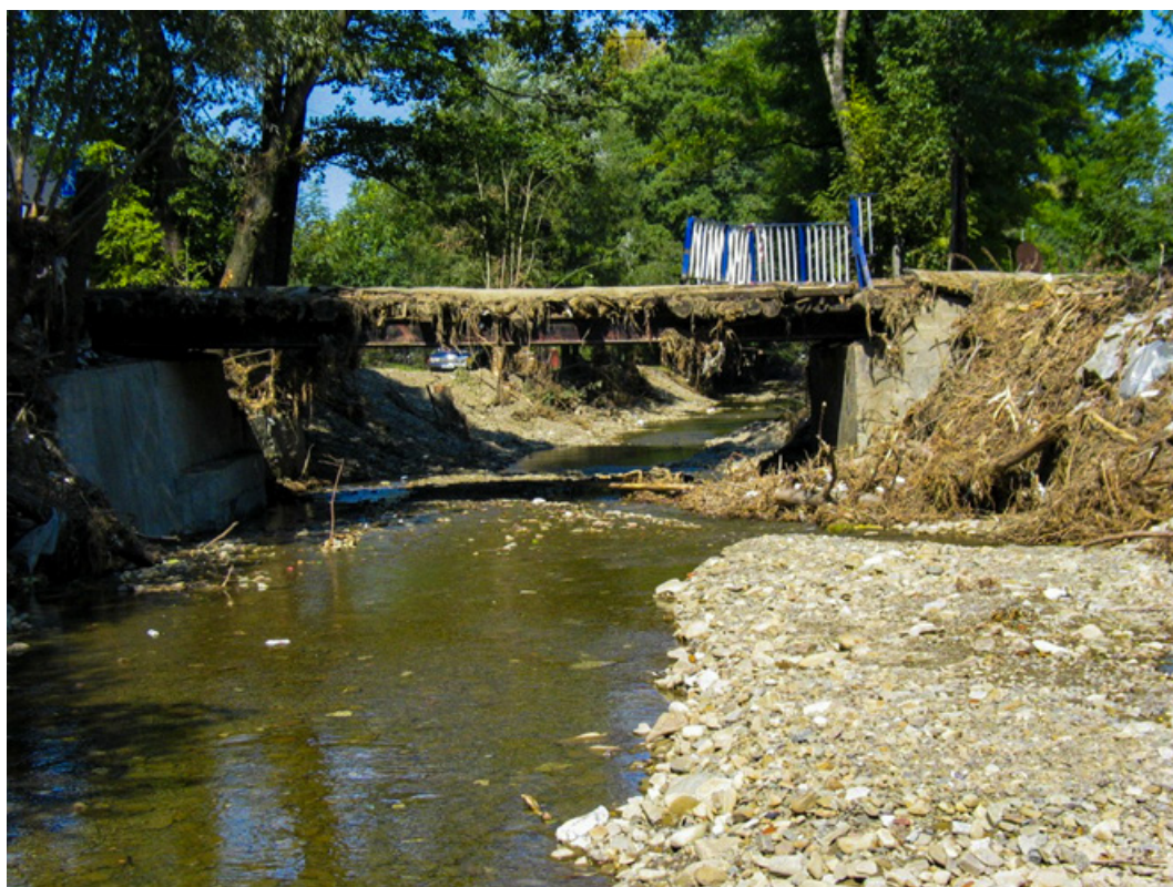
Fot. 145. Mostek z uszkodzoną barierką, ocalały po przejściu fali powodziowej, Targaniczanka (fot. L. Książek, 2005)
