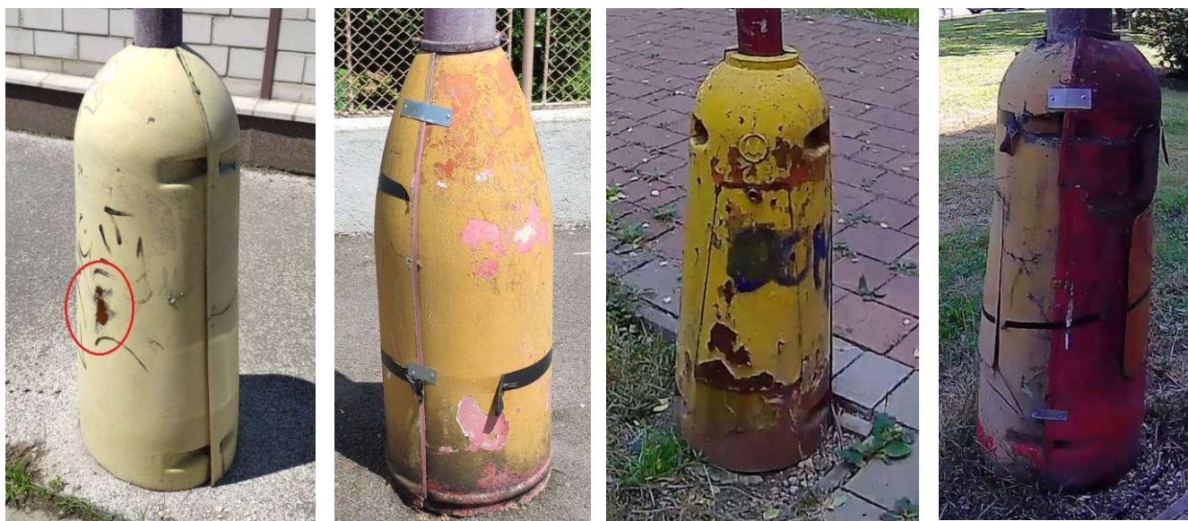
Obr. 10 Prepáskované, deravé, rozbyté, nezatesnené pätky stožiarov
