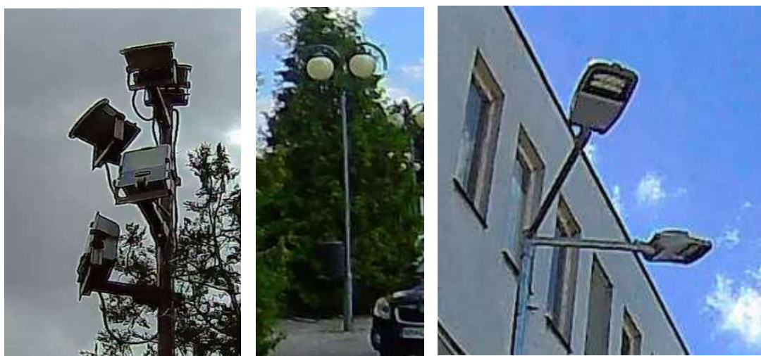
Obr. 5 Päť / dve svietidlá na oceľovom stožiar
