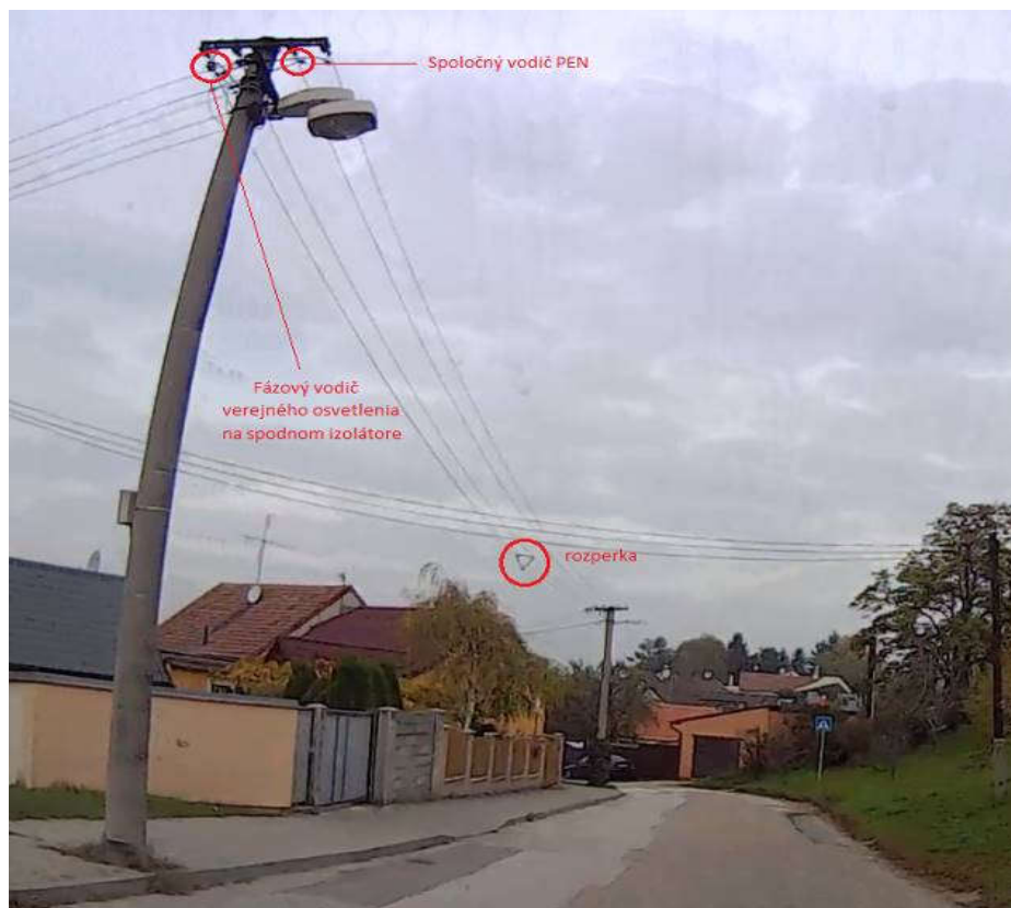
Obr. 14 Holé vzdušné vedenie typu AIFe 25
